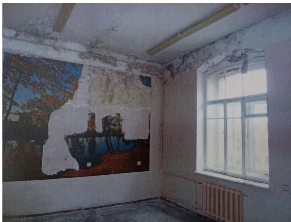
40. Вид промерзания перекрытия по контуру помещения второго этажа «Д...И», между осями «5...6». Архив КГИОП. Заключение по результатам технического обследования конструкций крыши здания. Разработано ЗАО «Стройком». 2012 г.
