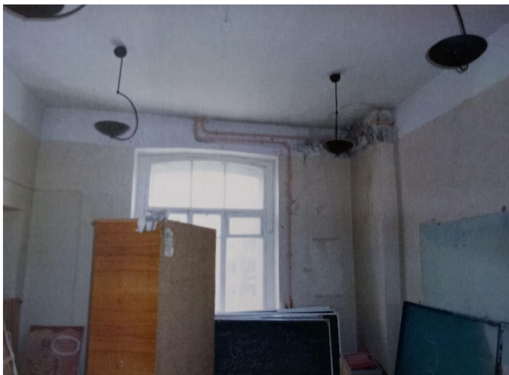
42. Вид типовых протечек в помещении второго этажа в осях «В...Д» между осями «2...3» вследствие выпадения конденсата на поверхности металлической кровли из-за отсутствия утепления в помещениях мансарды, расположенных в осях «Е/1...И», между осями «2/2...2/3», «4/2...4/3», и в осях «В...Г/1», между осями «2/2...2/3», «4/2...4/3».
