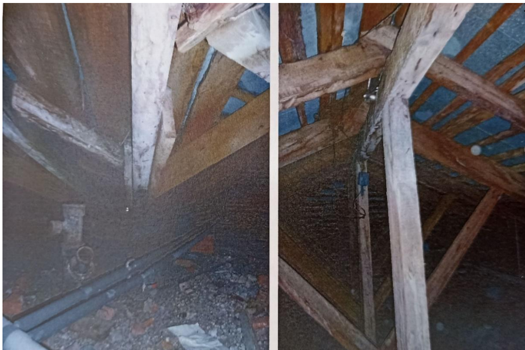
33. Вид усиленной накосной стропильной ноги слева, деревянные стропильные конструкции, получившие дополнительные деформации (отклонение от вертикали, кручение верхнего прогона) вследствие ослабления гвоздевых соединений и отсутствия единого мауэрлата под опорами стропильных ног. Архив КГИОП. Заключение по результатам технического обследования конструкций крыши здания. Разработано ЗАО «Стройком». 2012 г.
