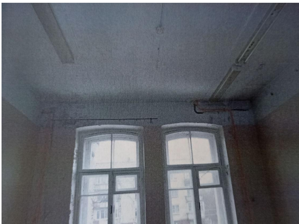
39. Вид типовых протечек в помещении второго этажа в осях «В...Д» между осями «2...3» вследствие неработоспособного состояния кровельного покрытия и выпадения конденсата на поверхности металлической кровли из-за отсутствия утепления в помещениях мансарды, расположенных в осях «Е/1...И», между осями «2/2...2/3», «4/2...4/3», и в осях «В...Г/1», между осями «2/2...2/3», «4/2...4/3».
