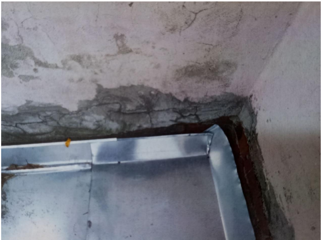
28. Неудовлетворительного состояние кровельного покрытия в примыкании к стенам по осям «Е/1» и «2/1». Архив КГИОП. Заключение по результатам технического обследования конструкций крыши здания. Разработано ЗАО «Стройком». 2012 г.
