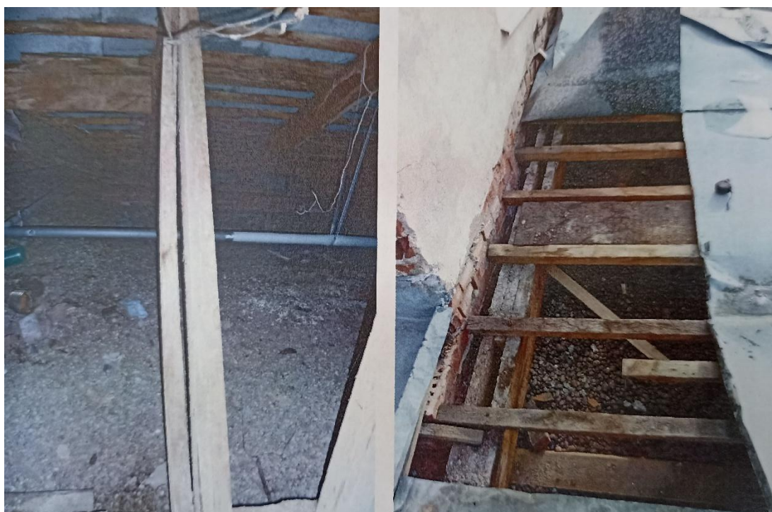
36. Вид деформирования состояния составного подкоса из доски 150x50 мм и двух брусков 50x50 мм, соединенных между собой при помощи гвоздей, слева, вид вскрытия поврежденного участка крыши в осях «В...И» между осями «5...6», справа. Архив КГИОП. Заключение по результатам технического обследования конструкций крыши здания. Разработано ЗАО «Стройком». 2012 г.
