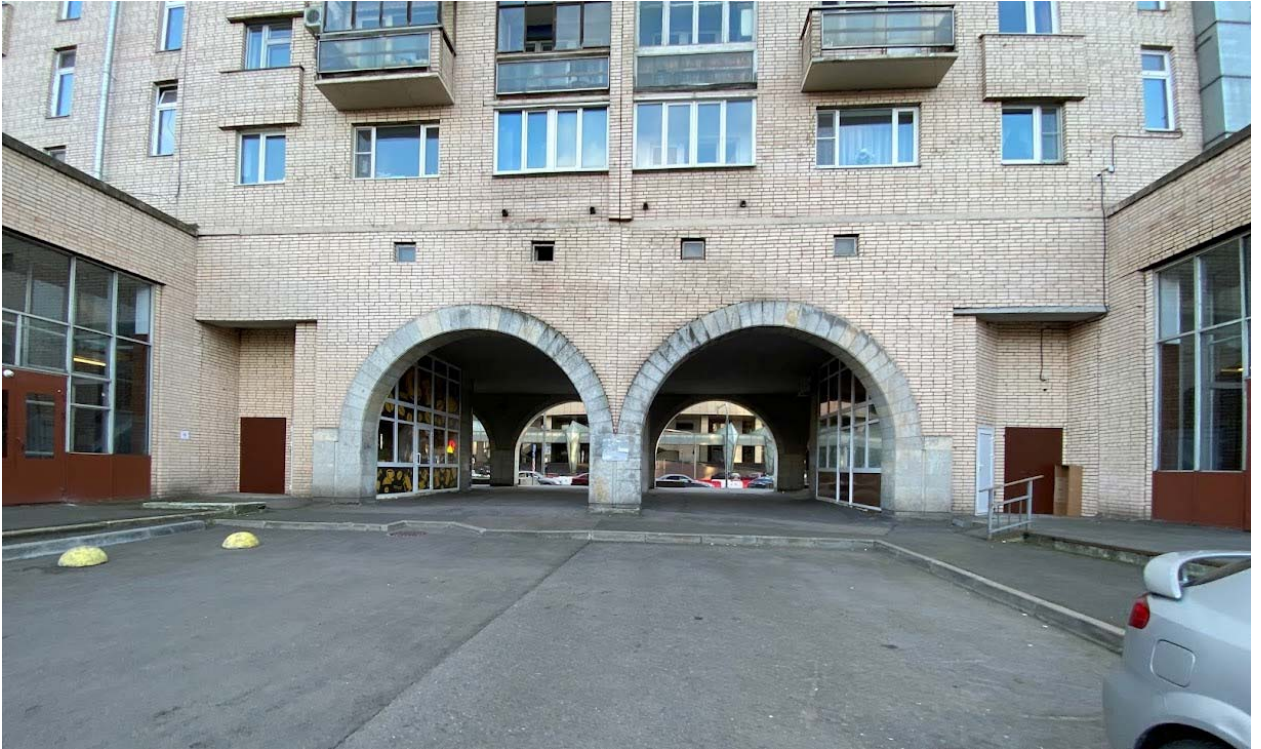
Фото 11. Вид на участок прохождения трассы теплосети под аркой здания д. 1 по Финляндскому пр.
