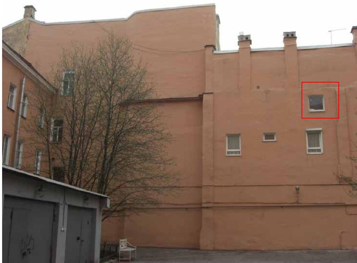
Фото 4, 5. Объект культурного наследия регионального значения «Здание Английского собрания» 1730-е гг., 1750-е гг., 1846г., 1899-1900-е гг., 1940-1950-е гг. расположенный по адресу: г. Санкт-Петербург, ул. Миллионная, д.17, лит А. Брандмауэр дворового флигеля . Общий вид, фрагмент.
