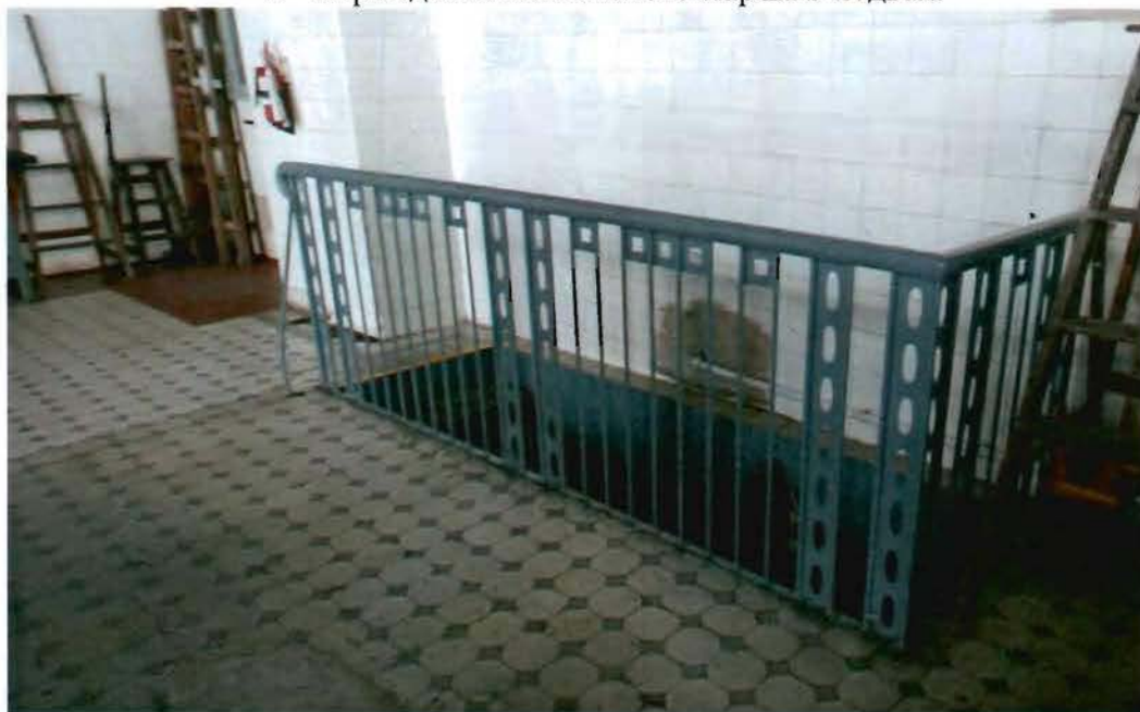
7. Ограждение лестничного марша в подвал.
