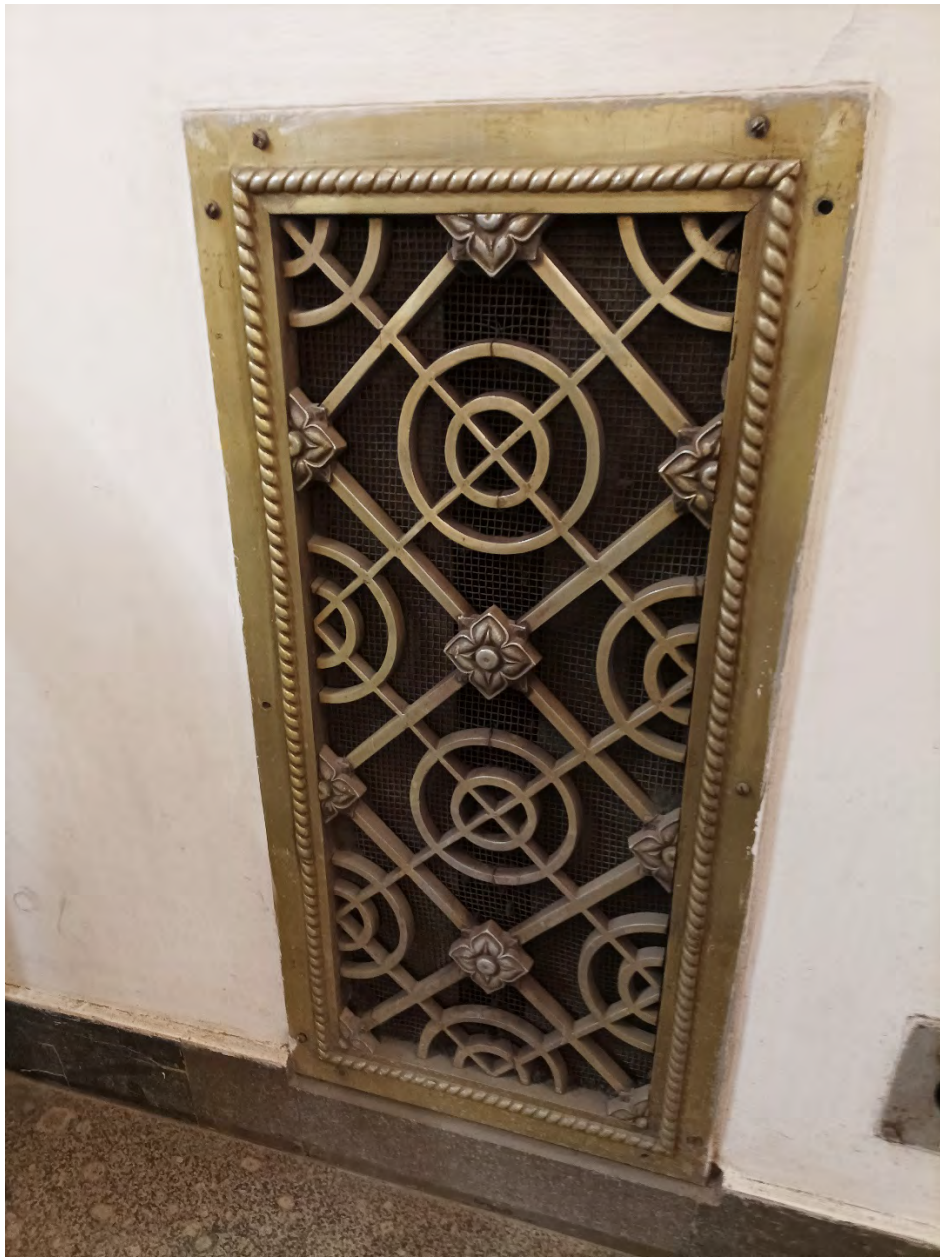
9. Объект культурного наследия регионального значения: «Станция метро «Технологический институт» (с перронным залом)», по адресу: Санкт-Петербург, Московский пр., д. 28, литера А. Вестибюль «Вход». Вентиляционная решетка. Дата съемки: 21.03.2024г.
