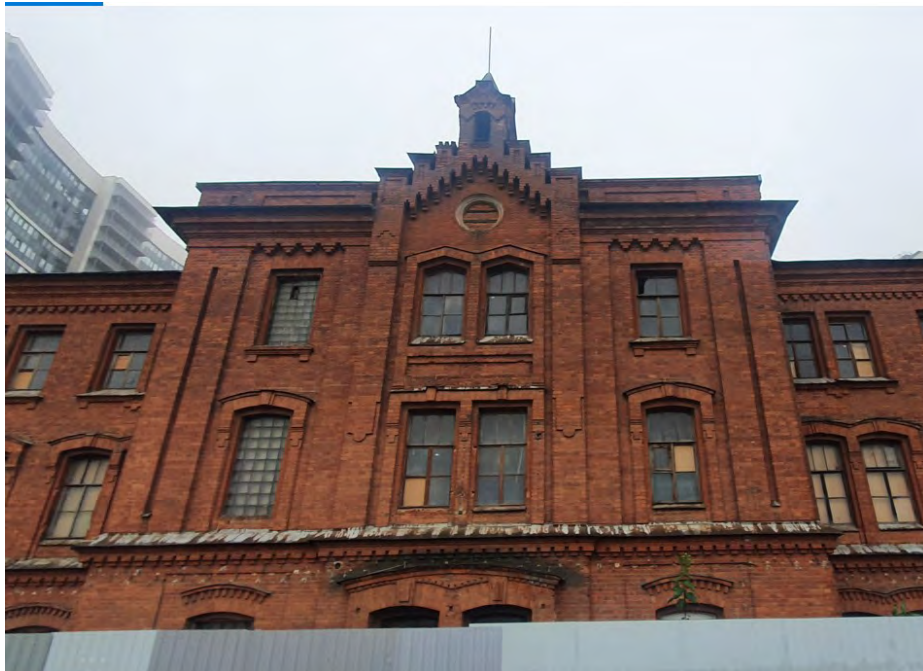
7. ОКН регионального значения «Главный производственный корпус Карточной фабрики» по адресу: г. Санкт-Петербург, пр. Обуховской Обороны, д. 110, лит. Б Центральная часть северного фасада дата съемки: 11.10.2021
