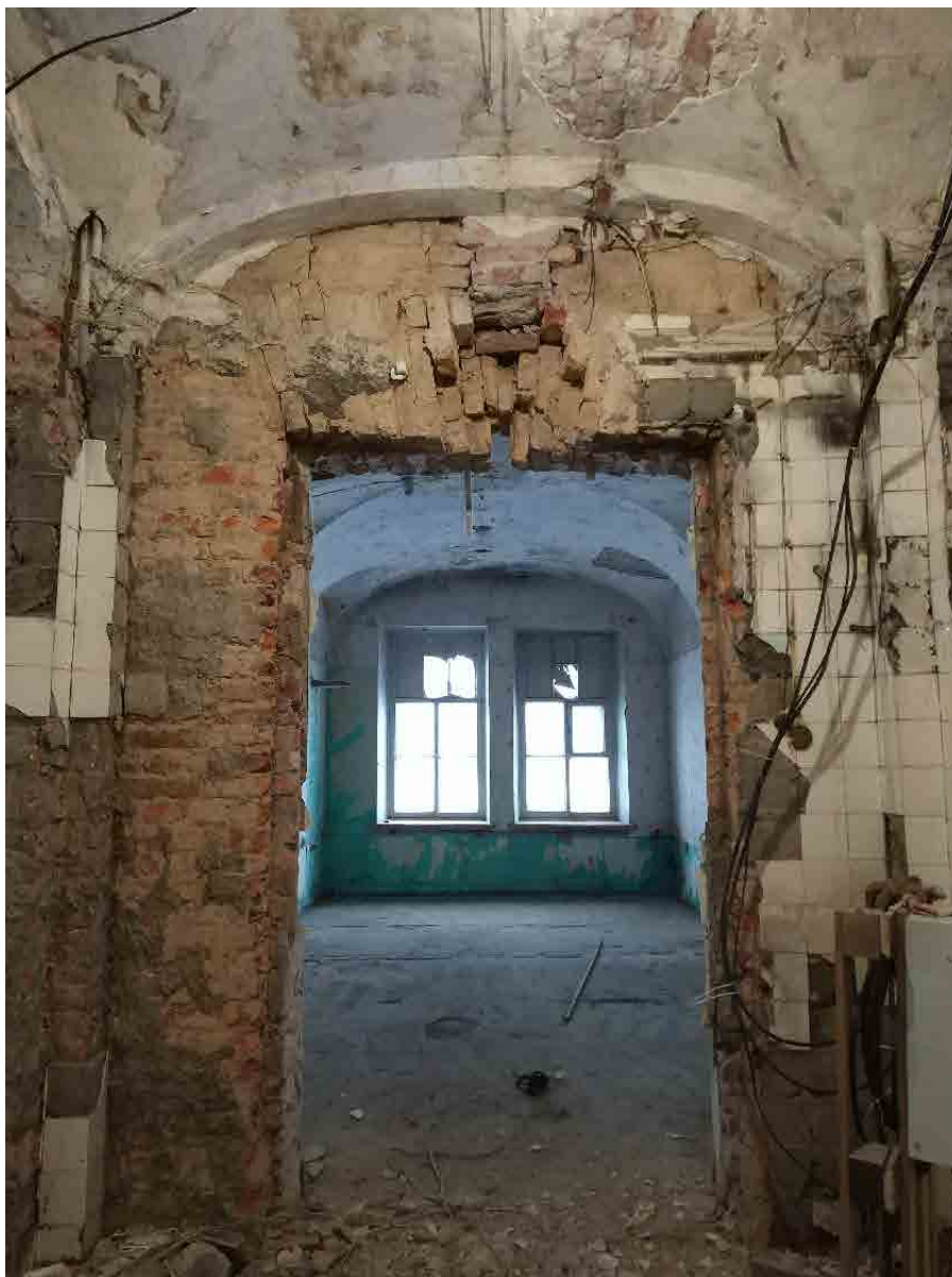
28. ОКН регионального значения «Главный производственный корпус Карточной фабрики» по адресу: г. Санкт-Петербург, пр. Обуховской Обороны, д. 110, лит. Б Коридор 2 этажа. Перемычка дата съемки: 11.10.2021
