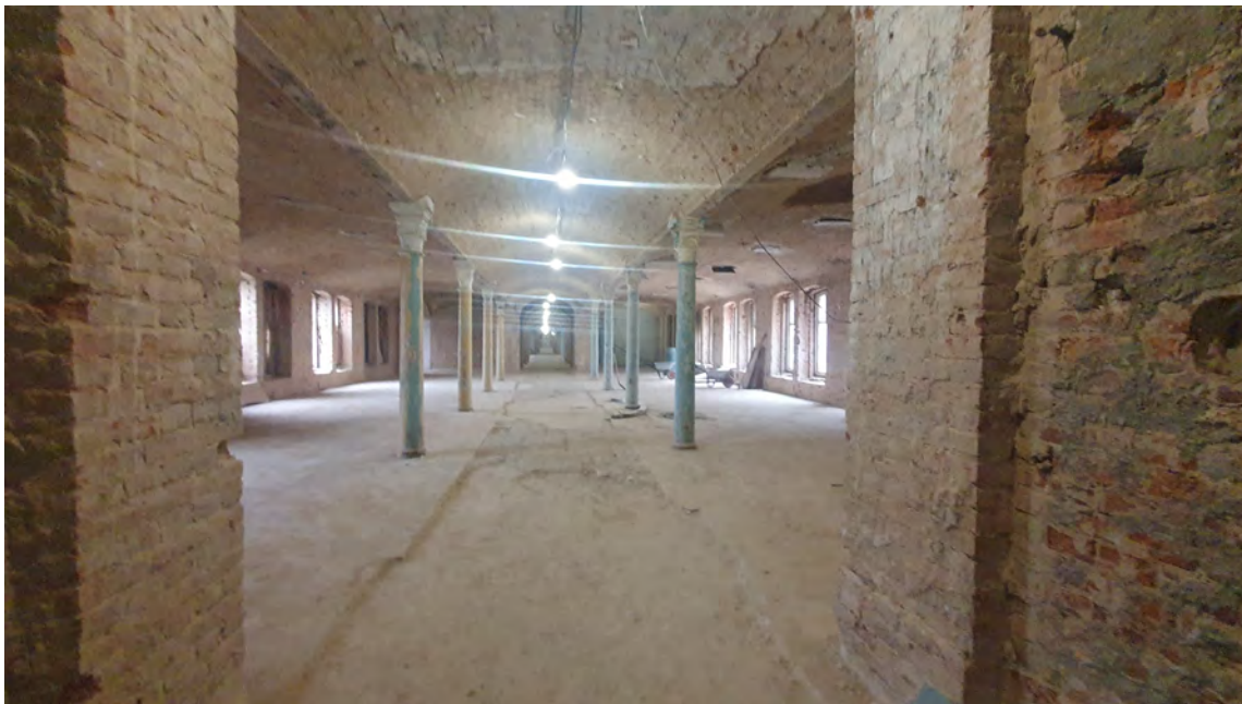
15. ОКН регионального значения «Главный производственный корпус Карточной фабрики» по адресу: г. Санкт-Петербург, пр. Обуховской Обороны, д. 110, лит. Б Коридор 2 этажа дата съемки: 11.10.2021
