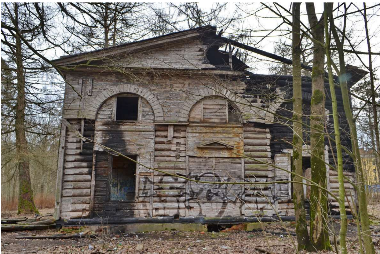
24. Современное состояние Усадьбы Вяземских (после пожара)
