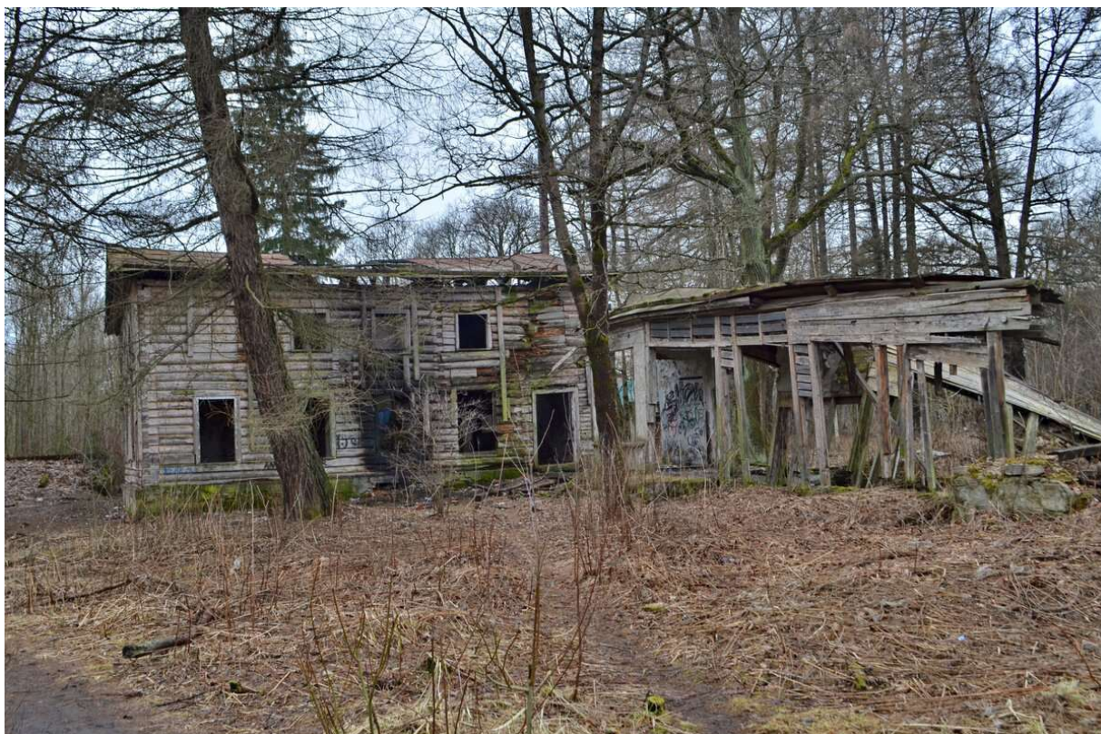
22. Современное состояние Усадьбы Вяземских (после пожара)
