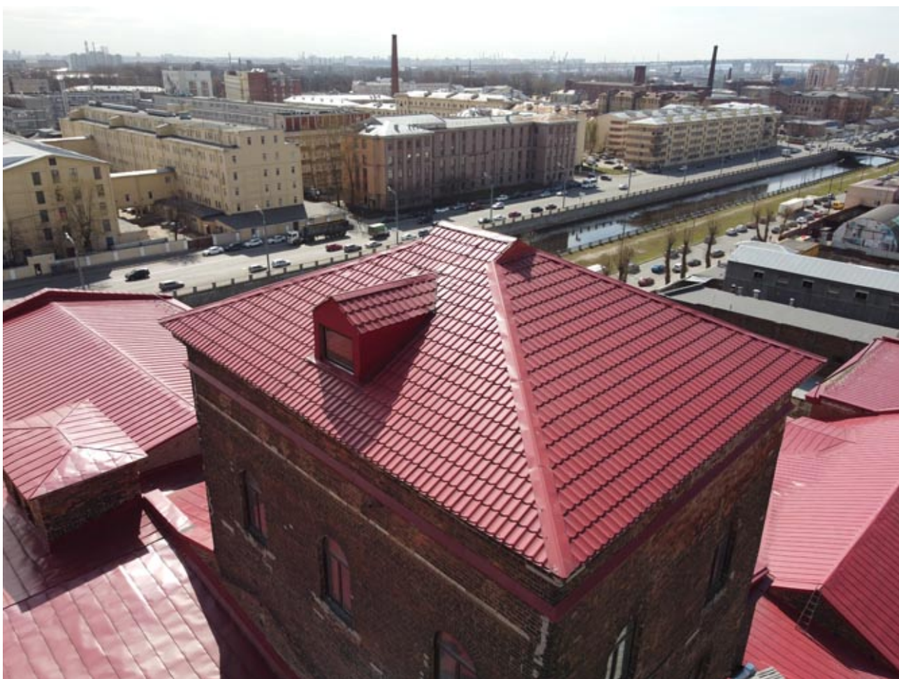
Фото 4. Объект культурного наследия регионального значения "Главное производственное здание Российской бумагопрядильной мануфактуры", расположенное по адресу: Обводного канала набережная д. 223-225, лит. С
