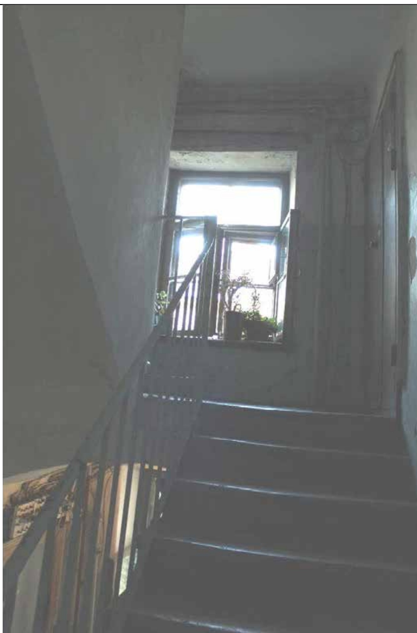
5. Дом А. Ф. Пеля. Шпалерная ул., 5. Южный двор. Юго-западный дворовый флигель. Лестничный марш между 2 и 3 этажами. Фото: эксперт А. А. Кононов, 26.04.2021.
