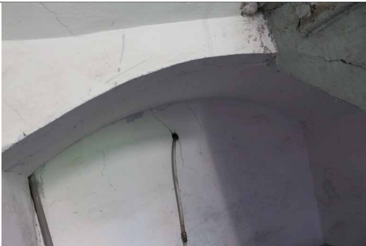
8. Дом А. Ф. Пеля. Шпалерная ул., 5. Южный двор. Юго-западный дворовый флигель. Своды перекрытия 2 этажа. Фото: эксперт А. А. Кононов, 26.04.2021.
