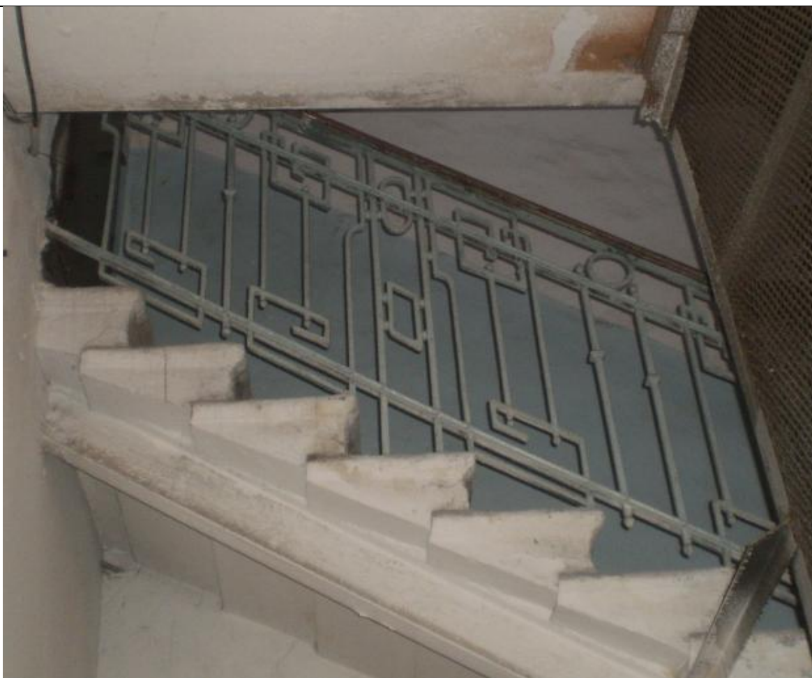
108. Дом по Шпалерной ул., д. 5. Марш на чердак. 2012. Источник: Архитектурный сайт Петербурга citywalls.ru
