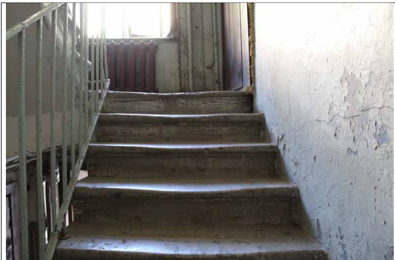
2. Дом А. Ф. Пеля. Шпалерная ул., 5. Южный двор. Юго-западный дворовый флигель. Интерьер. Ступени с валиком. Фото: эксперт А. А. Кононов, 26.04.2021.
