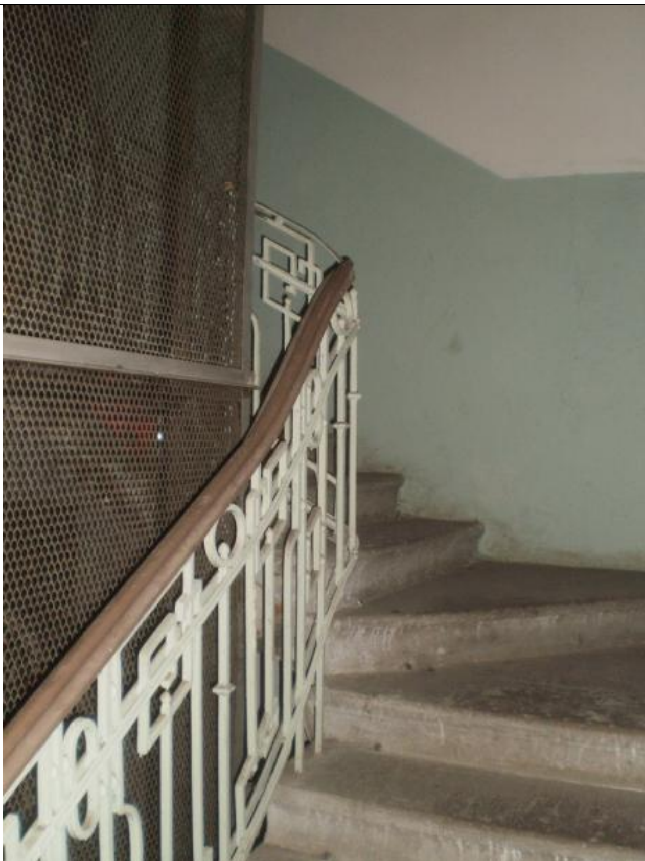
105. Дом по Шпалерной ул., д. 5. Лестничная клетка. 2012. Источник: Архитектурный сайт Петербурга citywalls.ru
