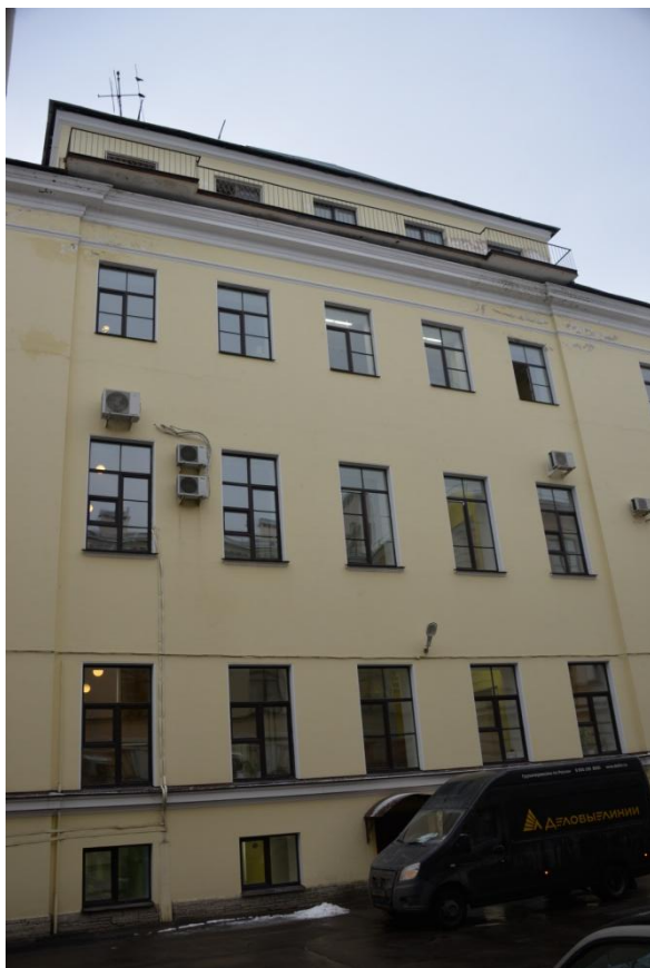
5. Фрагмент западного фасада объекта культурного наследия федерального значения «Дом, где в 1893-1907 гг. работал химик Менделеев Д.И.»
