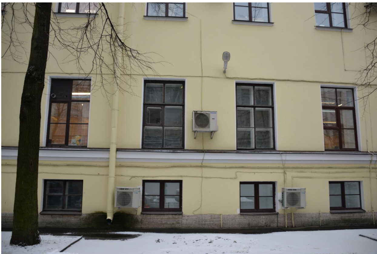
16. Фрагмент северного фасада объекта культурного наследия федерального значения «Дом, где в 1893-1907 гг. работал химик Менделеев Д.И.»
