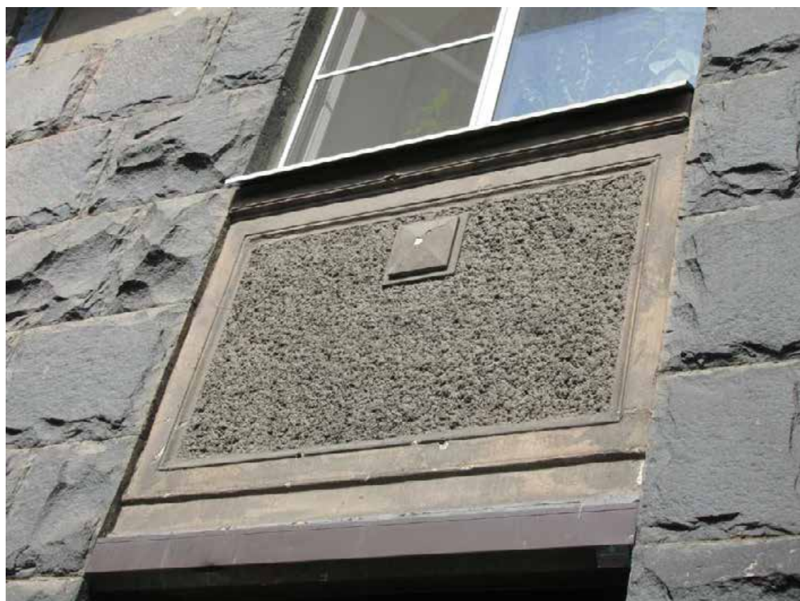
14. 12-я линия В.О., 19. Дом О.М. Фогт и Б.А. Попова. Штукатурный декоративный элемент южной части лицевого фасада между оконными проемами 1-го и 2-го этажей.
