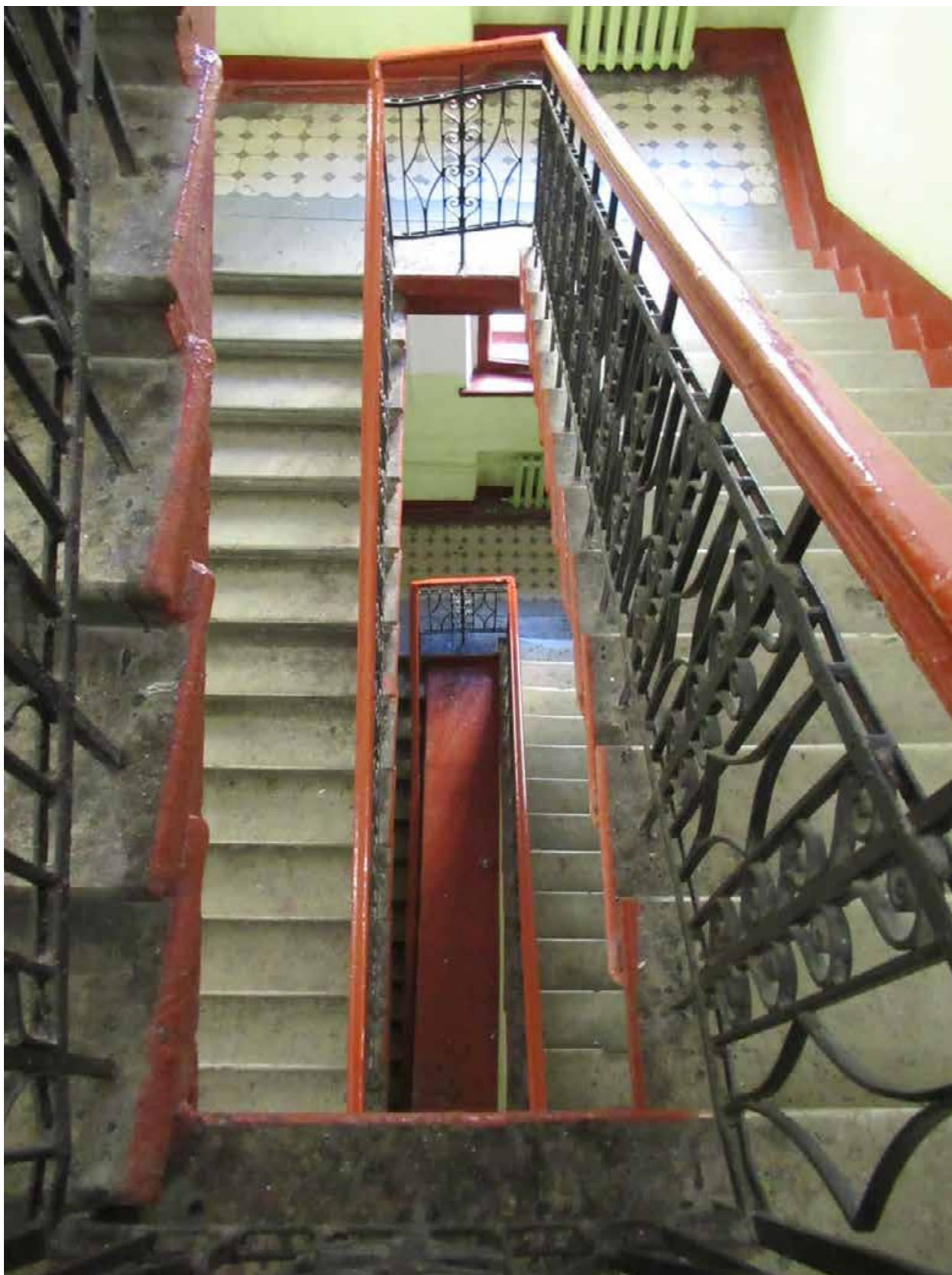
65. 12-я линия В.О., 19. Дом О.М. Фогт и Б.А. Попова. 1ЛК, вид сверху на лестничные пролеты.
