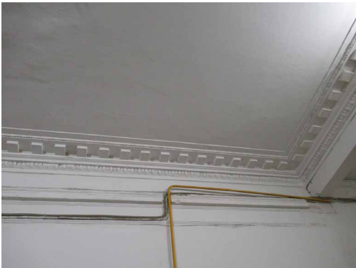
58. 12-я линия В.О., 19. Дом О.М. Фогт и Б.А. Попова. 1ЛК, профилированная штукатурная тяга по периметру потолка вестибюля.
