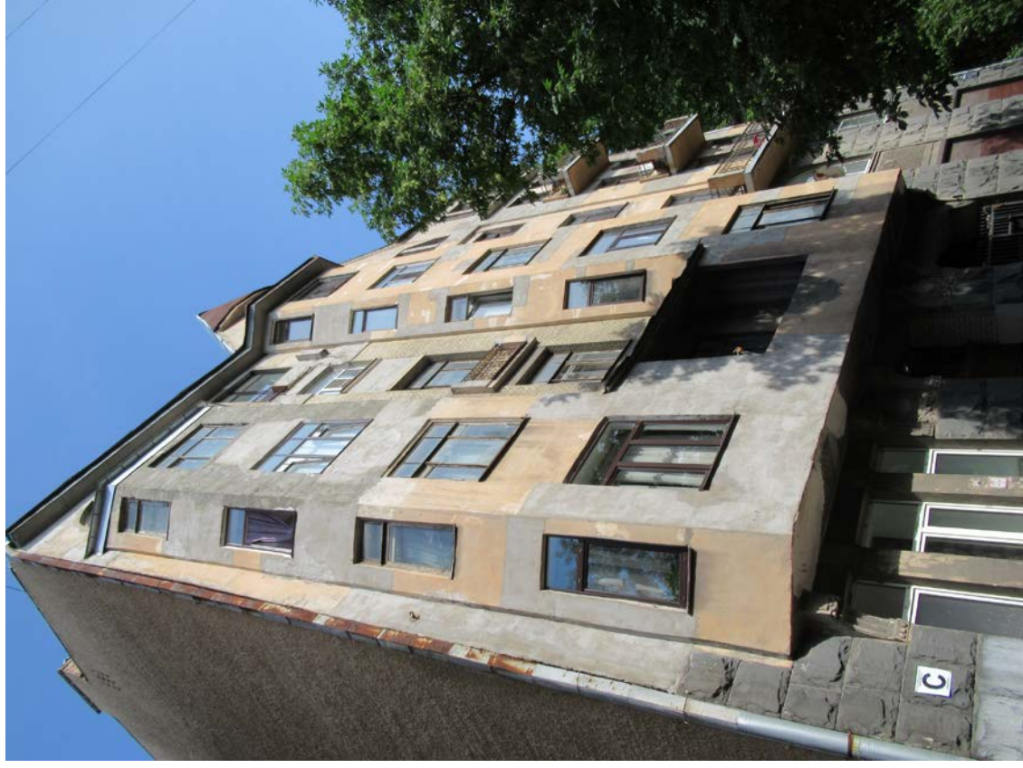
24. 12-я линия В.О., 19. Дом О.М. Фогт и Б.А. Попова. Эркер северной части лицевого фасада, вид сбоку.
