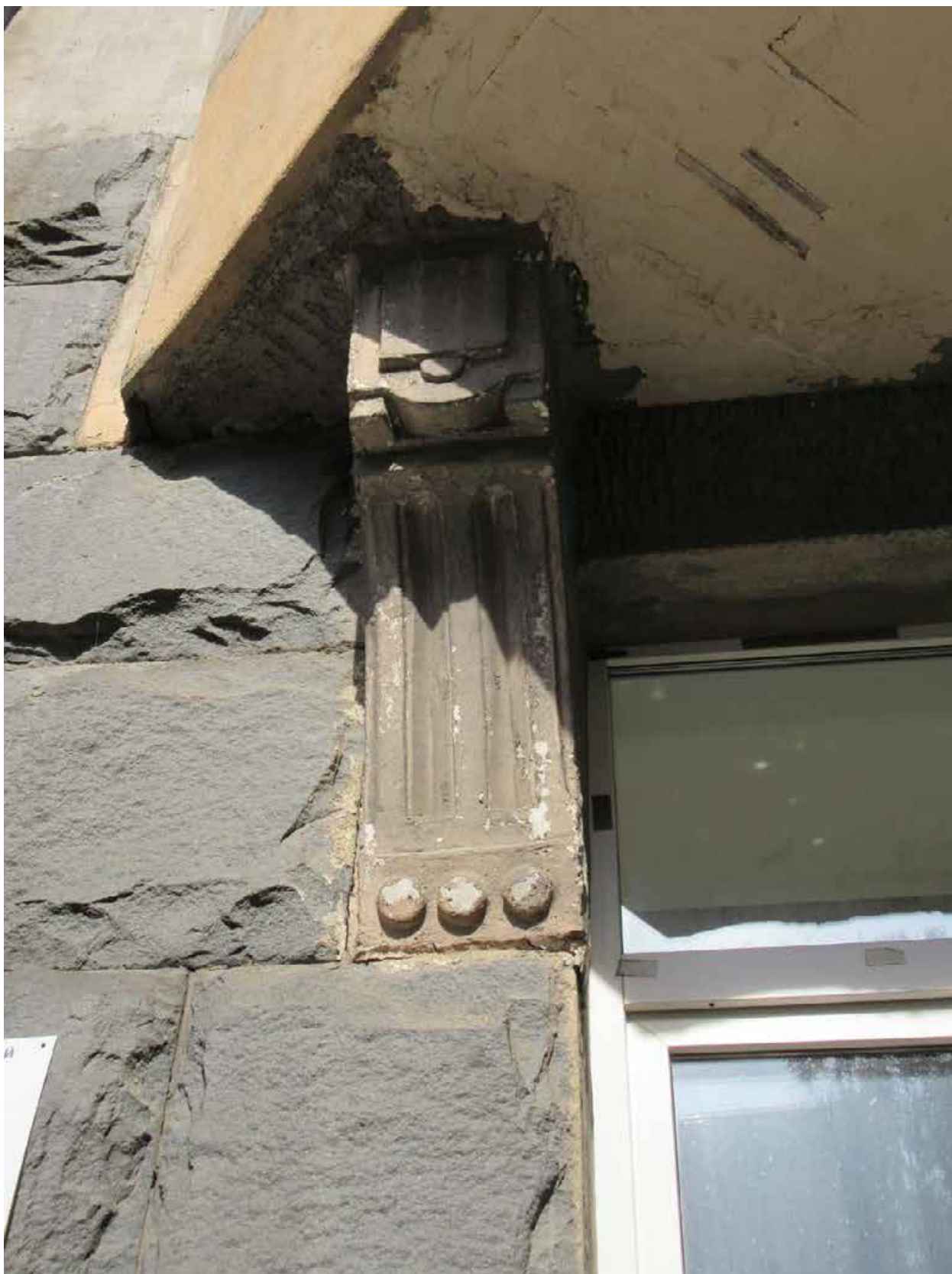
29. 12-я линия В.О., 19. Дом О.М. Фогт и Б.А. Попова. Кронштейн под северным эркером лицевого фасада.
