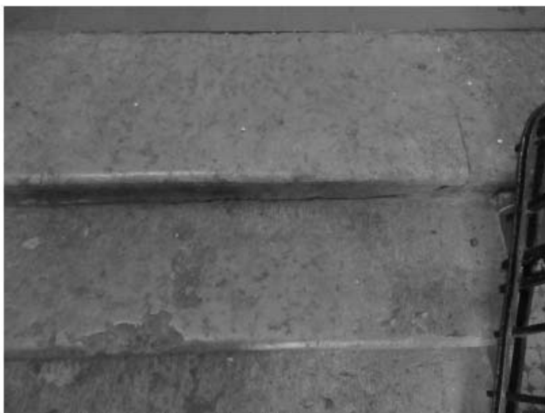
51. 12-я линия В.О., 15, лит. А. Доходный дом Н.В. Смирнова, входящий в состав ОКН «Доходный дом и особняк Н.В. Смирнова». ЗЛК, ступени лещадной плиты.
