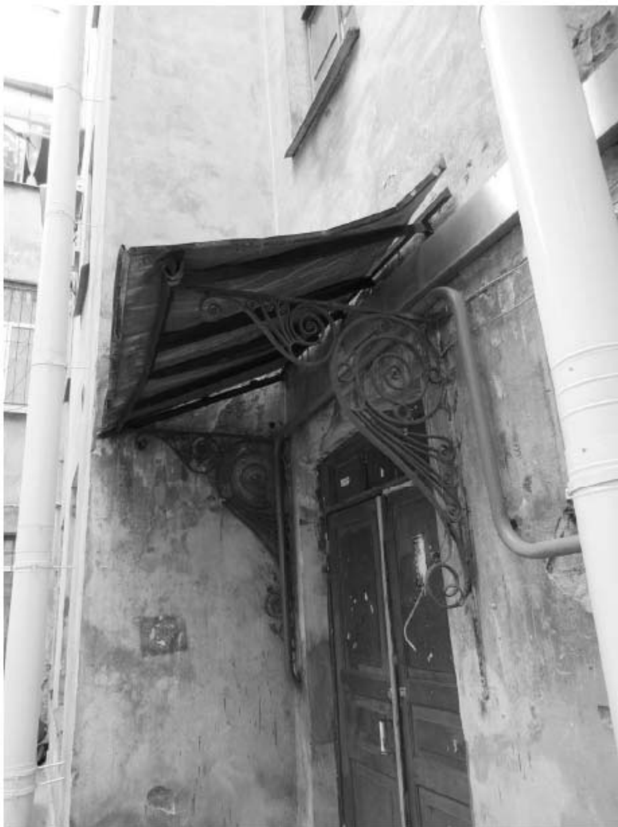
26. 12-я линия В.О., 15, лит. А. Доходный дом Н.В. Смирнова, входящий в состав ОКН «Доходный дом и особняк Н.В. Смирнова». Входной проем на лестницу 2ЛК с историческим деревянным заполнением и металлическими кронштейнами козырька.
