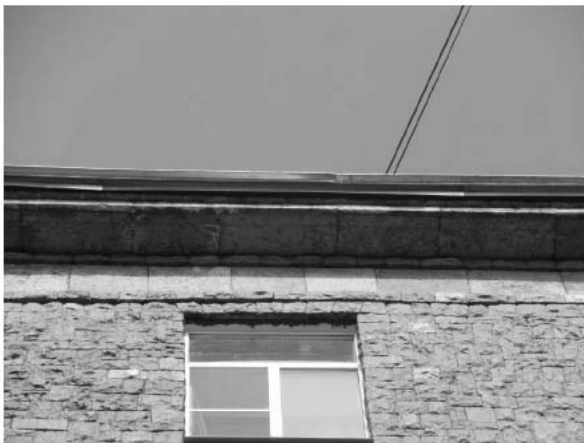
16. 12-я линия В.О., 15, лит. А. Доходный дом Н.В. Смирнова, входящий в состав ОКН «Доходный дом и особняк Н.В. Смирнова». Фрагмент венчающего карниза лицевого фасада.
