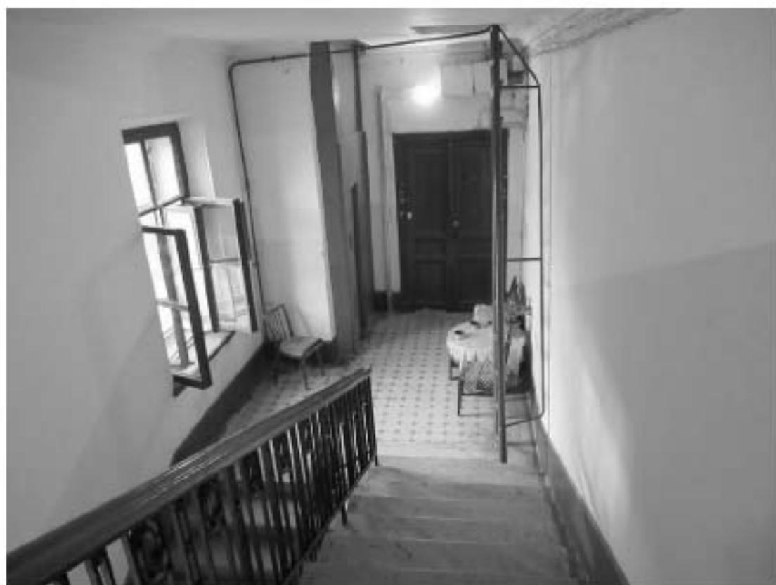
45. 12-я линия В.О., 15, лит. А. Доходный дом Н.В. Смирнова, входящий в состав ОКН «Доходный дом и особняк Н.В. Смирнова». Парадная лестница (4ЛК). Вид сверху на площадку 6-го этажа.
