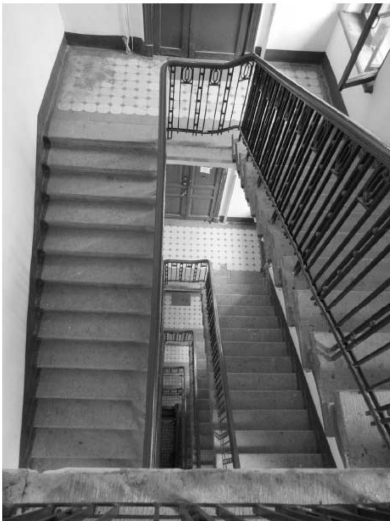
56. 12-я линия В.О., 15, лит. А. Доходный дом Н.В. Смирнова, входящий в состав ОКН «Доходный дом и особняк Н.В. Смирнова». ЗЛК, вид с площадки 7-го этажа на лестничные пролеты.
