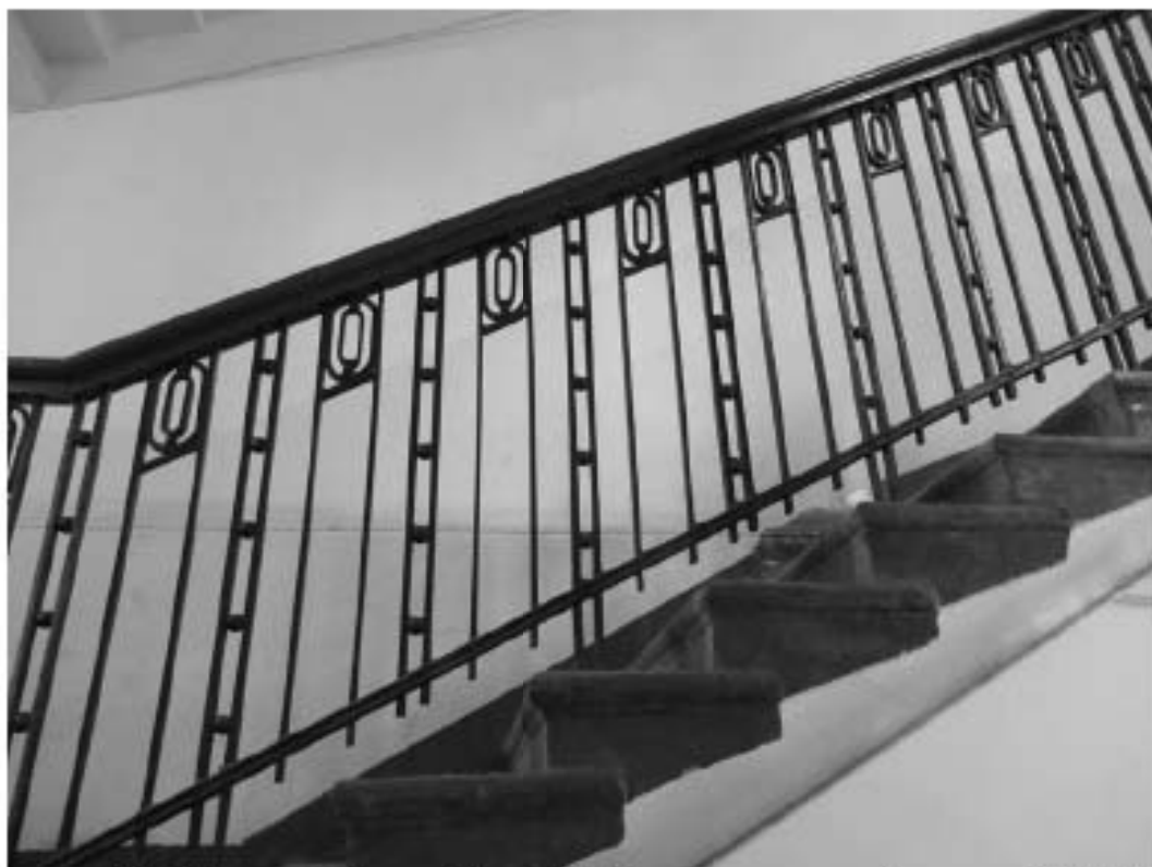
50. 12-я линия В.О., 15, лит. А. Доходный дом Н.В. Смирнова, входящий в состав ОКН «Доходный дом и особняк Н.В. Смирнова». ЗЛК, фрагмент исторического металлического ограждения с деревянными перилами.
