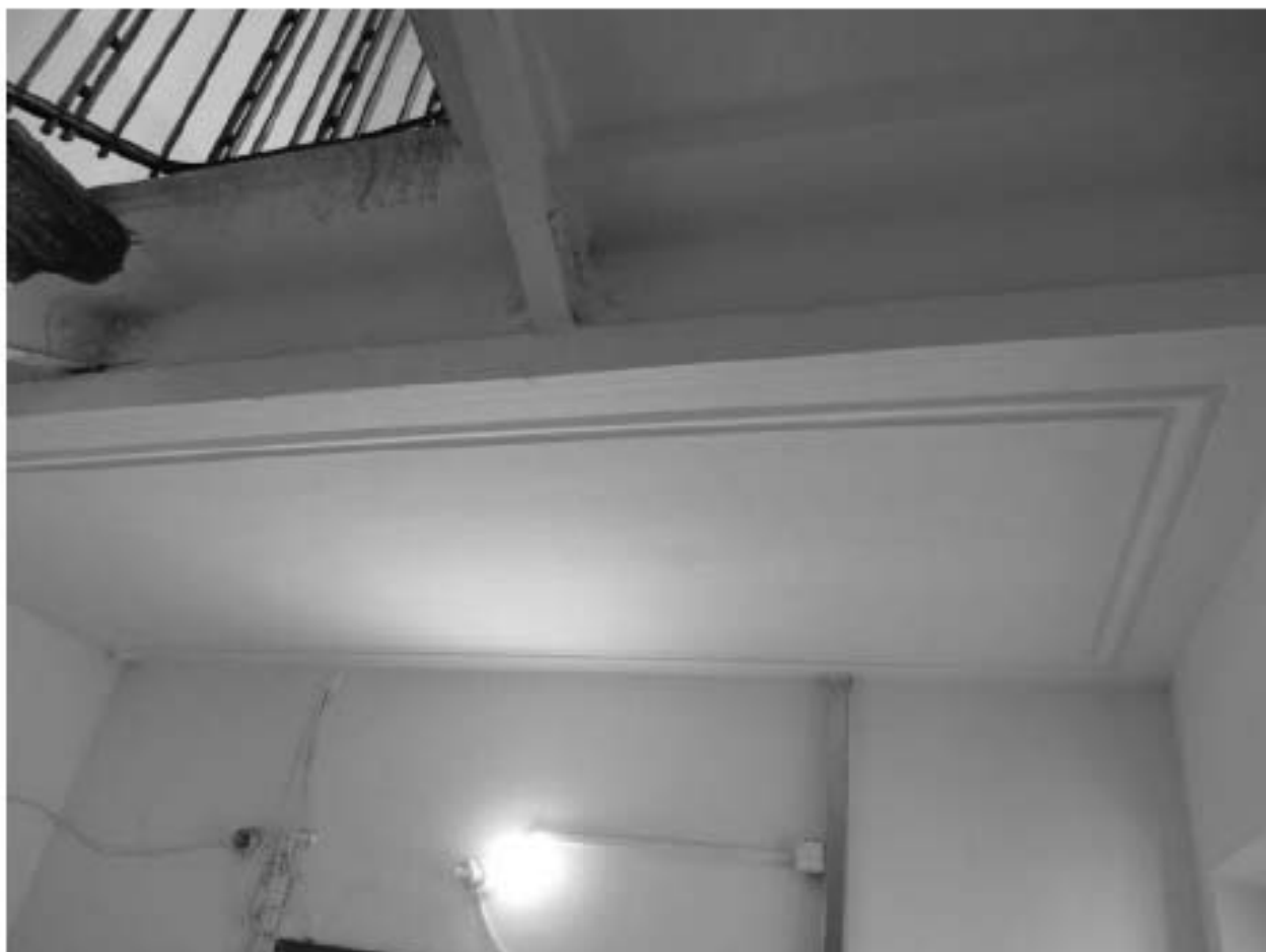
54. 12-я линия В.О., 15, лит. А. Доходный дом Н.В. Смирнова, входящий в состав ОКН «Доходный дом и особняк Н.В. Смирнова». 3ЛК, потолок лестничной клетки.
