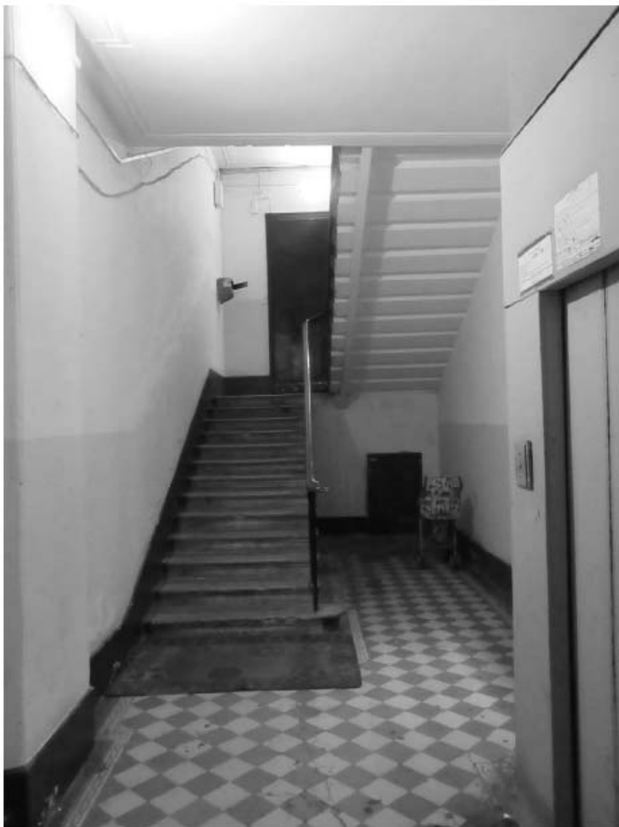
39. 12-я линия В.О., 15, лит. А. Доходный дом Н.В. Смирнова, входящий в состав ОКН «Доходный дом и особняк Н.В. Смирнова». Парадная лестница (4ЛК). Лестничные косоуры, вид из тамбура.
