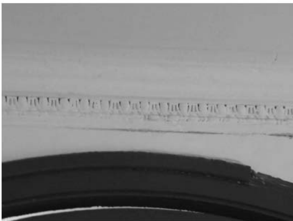
35. 12-я линия В.О., 15, лит. А. Доходный дом Н.В. Смирнова, входящий в состав ОКН «Доходный дом и особняк Н.В. Смирнова». Парадная лестница (4ЛК). Фрагмент паутини вестибюля.
