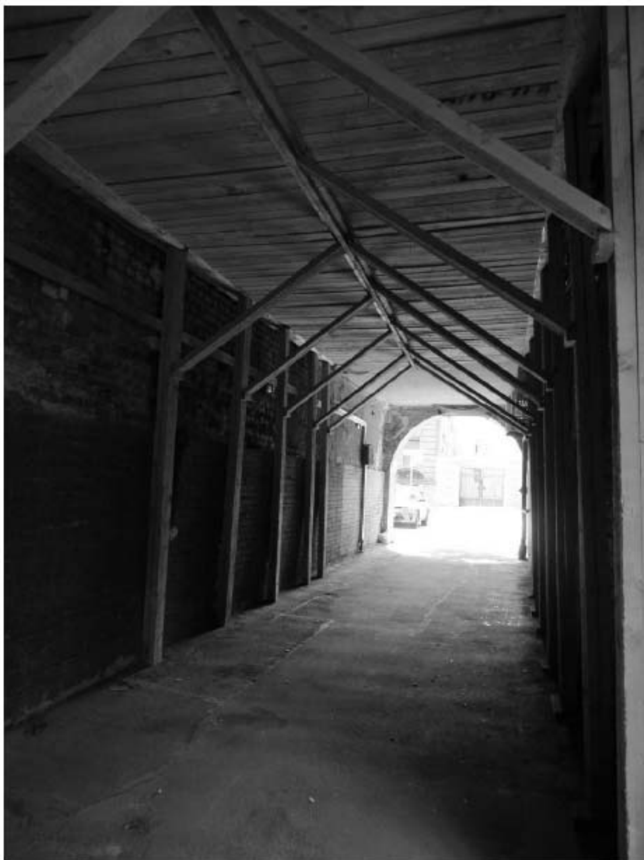
18. 12-я линия В.О., 15, лит. А. Доходный дом Н.В. Смирнова, входящий в состав ОКН «Доходный дом и особняк Н.В. Смирнова». Воротный проезд лицевого корпуса, вид со стороны внутреннего двора.
