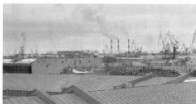
12. Фрагмент крыши объекта культурного наследия. Состояние кровли
