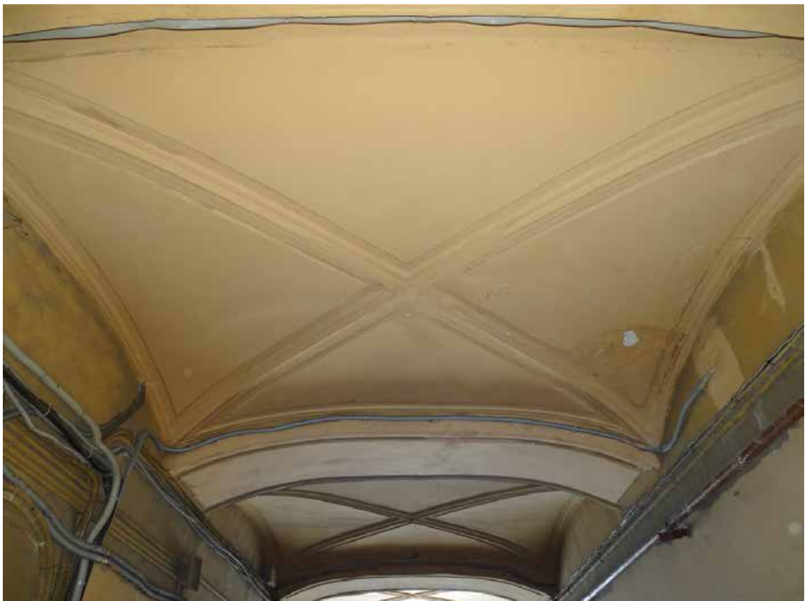
Фото 50. Здание по адресу: г. Санкт-Петербург, Средний пр. В. О., д. 11, литер А. Воротный проезд. Оформление перекрытия. Съемка 19.04.2021 г. Трушковский В.Э.
