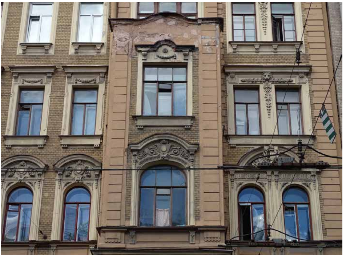
Фото 4. Здание по адресу: г. Санкт-Петербург, Средний пр. В. О., д. 11, литер А. Фрагмент лицевого фасада. Эркер.3-й, 4-й этаж. Съемка 19.04.2021 г. Трушковский В.Э.
