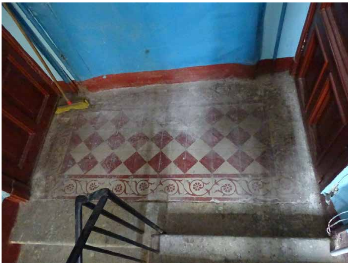
Фото 150. Лестница № 4. Вид на площадку 4-го этажа. Покрытие пола. Съемка 19.04.2021 г. Трушковский В.Э.
