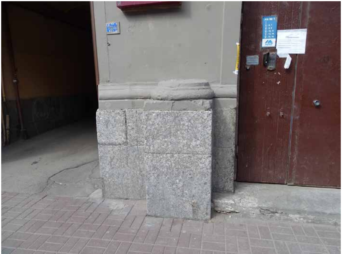
Фото 15. Здание по адресу: г. Санкт-Петербург, Средний пр. В. О., д. 11, литер А. Фрагмент лицевого фасада. Гранитный цоколь. Съемка 19.04.2021 г. Трушковский В.Э.
