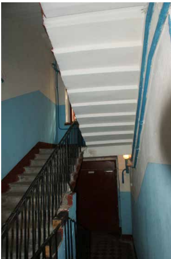
Фото 128. Лестница № 4. 1-й этаж. Вестибюль. Вид на входную дверь. Съемка 19.04.2021 г. Трушковский В.Э.
