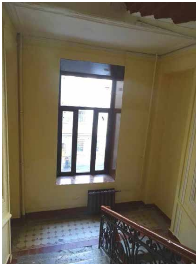
Фото 22. Лестница № 1. Вид на площадку между 2-м и 3-м этажом. Съемка 19.04.2021 г. Трушковский В.Э.
