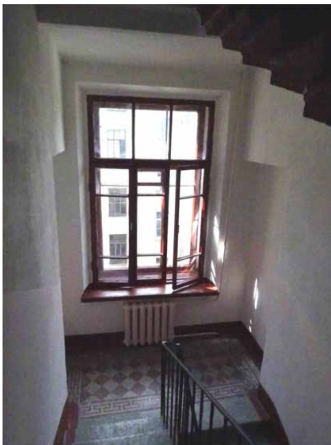
Фото 66. Лестница № 2. Вид на площадку между 4-м и 5-м этажом. Съемка 19.04.2021 г. Трушковский В.Э.
