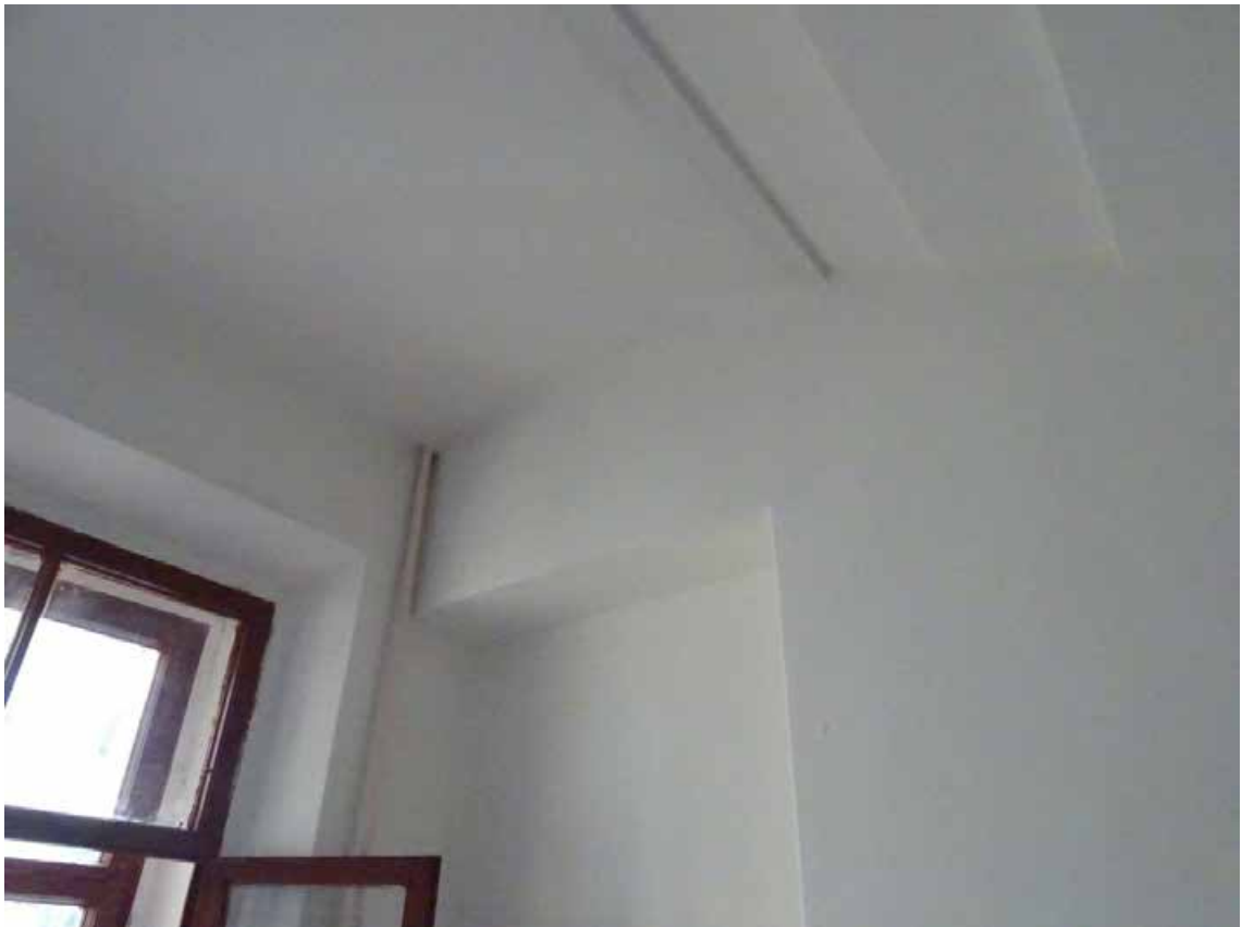
Фото 64. Лестница № 2. Площадка между 3-м и 4-м этажом. Съемка 19.04.2021 г. Трушковский В.Э.
