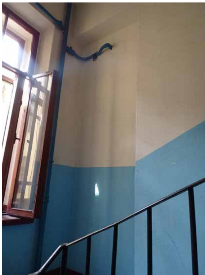
Фото 148. Лестница № 4. Площадка между 3-м и 4-м этажом. Съемка 19.04.2021 г. Трушковский В.Э.
