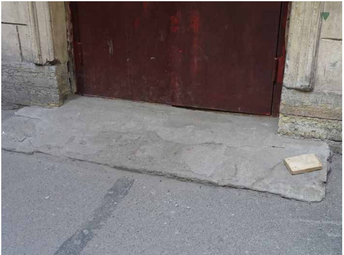
Фото 21. Здание по адресу: г. Санкт-Петербург, Средний пр. В. О., д. 11, литер А. Юго-восточный внутренний двор. Съемка 19.04.2021 г. Трушковский В.Э.
