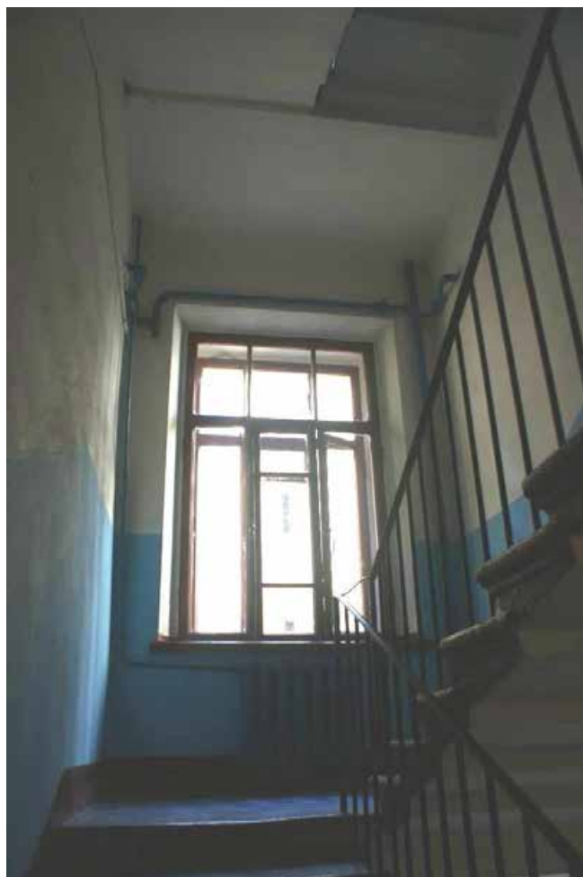
Фото 140. Лестница № 4. Вид на площадку между 2-м и 3-м этажом. Съемка 19.04.2021 г. Трушковский В.Э.
