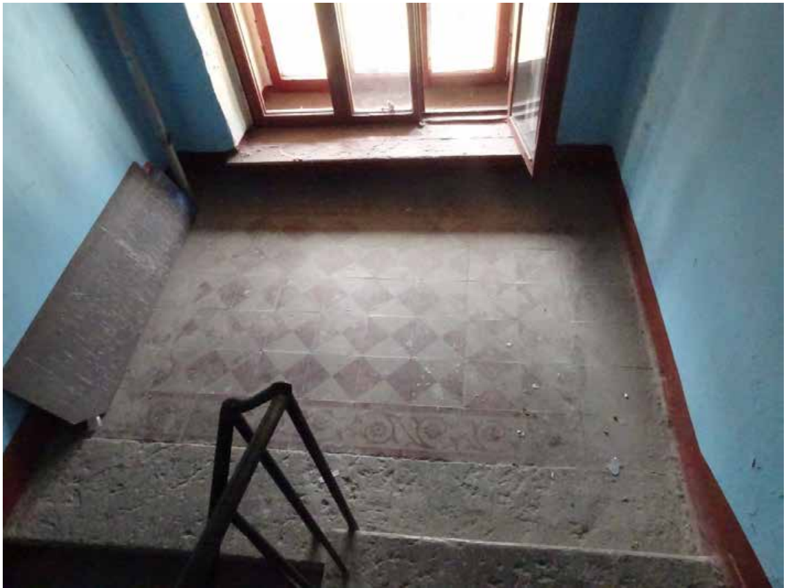
Фото 160. Лестница № 4. Площадка между 6-м и чердачным этажом. Покрытие пола. Съемка 19.04.2021 г. Трушковский В.Э.
