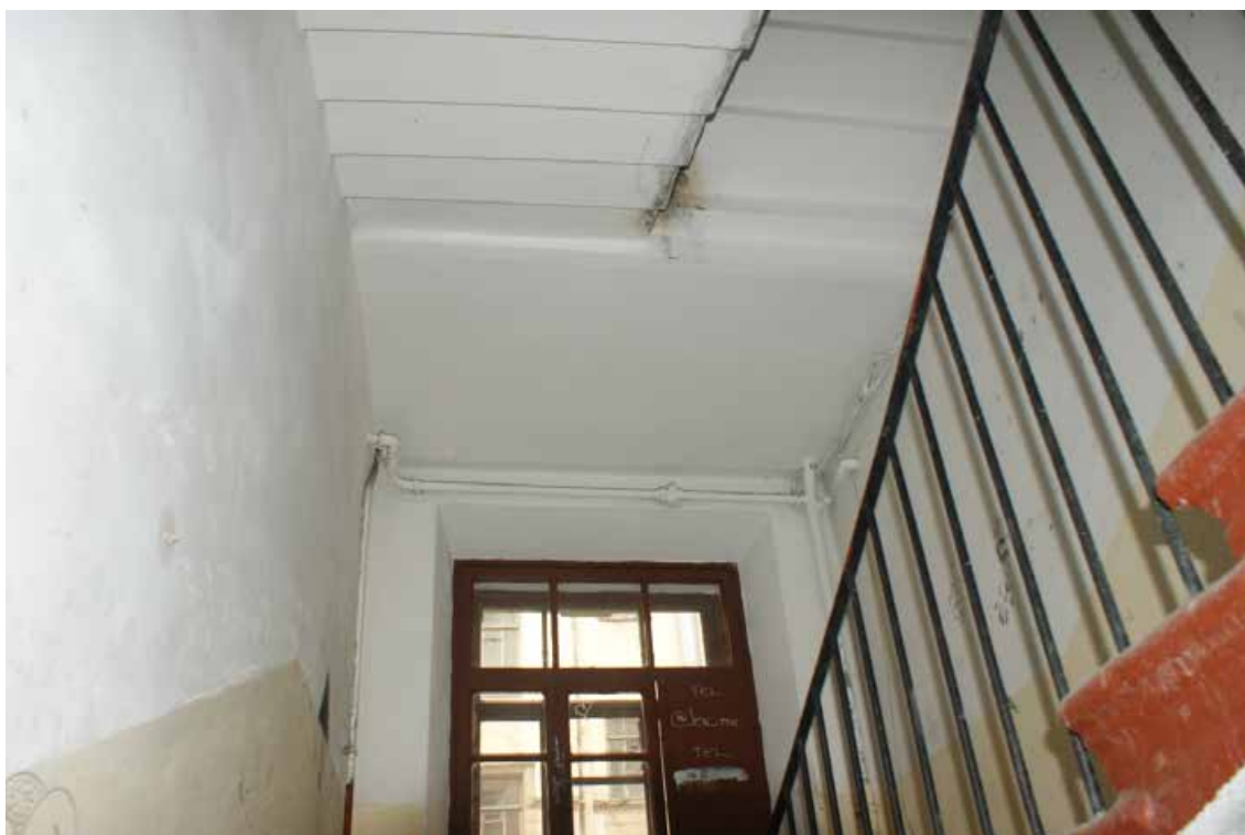
Фото 193. Лестница № 6. Вид на площадку между 1-м и 2-м этажом. Съемка 19.04.2021 г. Трушковский В.Э.
