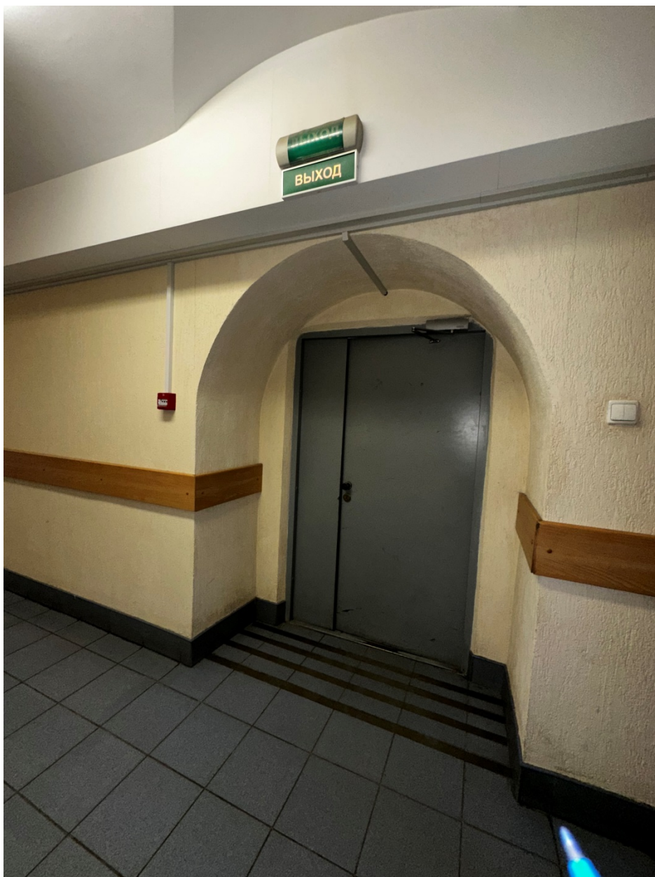
Фото 34. 2-ой этаж. Пом. 2.28. Проем между пом. 2.28 и лестничной клеткой ЛК-2. Дата съемки: 28.02.2025 г. Автор съемки: Глинская Н.Б.
