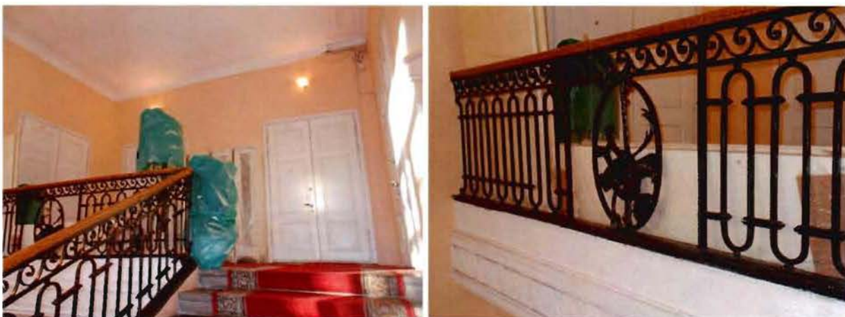
73, 74. Интерьеры и техническое состояние квартир (кв. 46, 47, 48)
