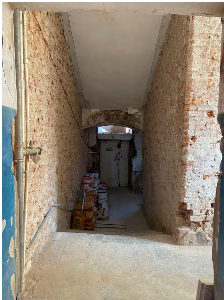
Фото №11. Лестница по левой оси с первого этажа на улицу. Сентябрь 2024г.
