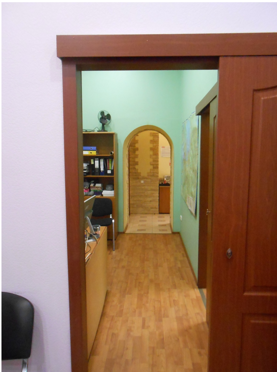
17. «Дом Н.В.Дмитриева» Санкт-Петербург, ул. Чайковского, дом 34, литера А. Фрагмент пом. 4-Н. Фото: 15.01.2025.
