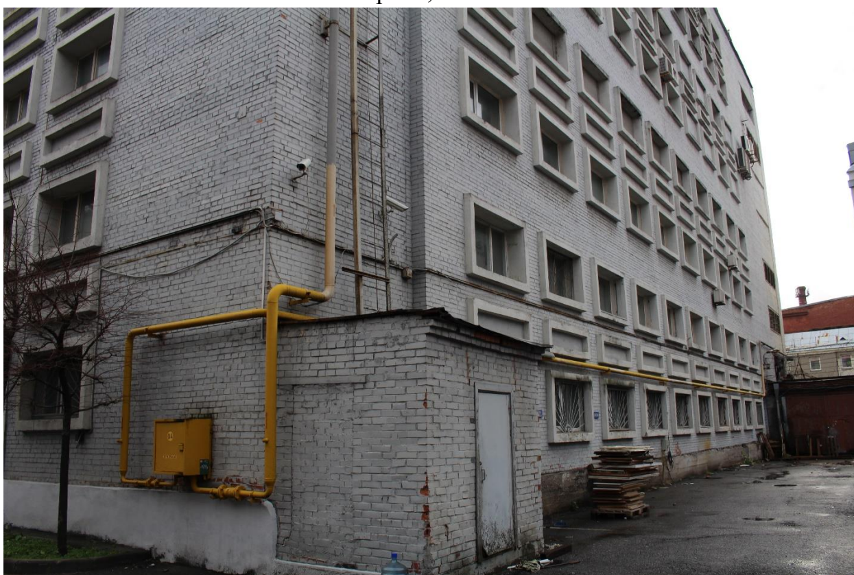
Фото 22. Вид на западный фасад нежилого здания по адресу: ул. Фокина, д. 1, корп. 1, лит. А.
