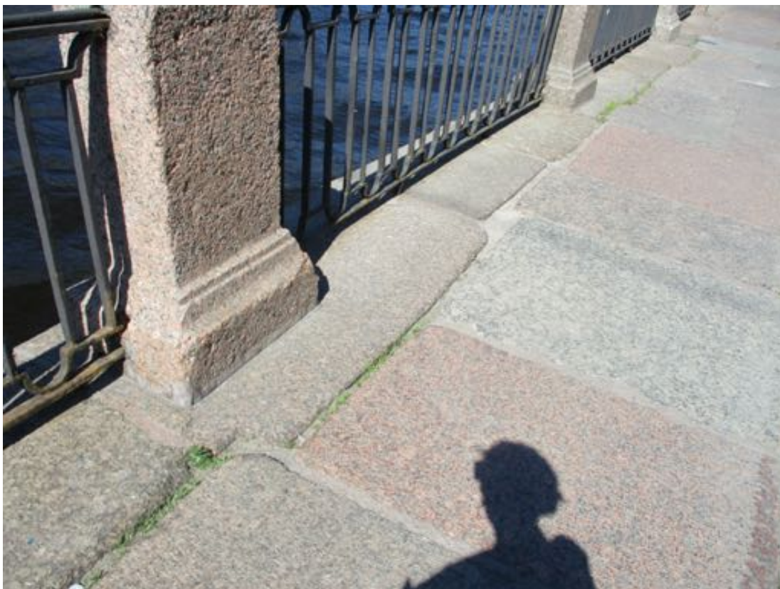
Фото 4. Гранитные плиты мощения и ограждение набережной из парапетных тумб и металлических звеньев между ними.
