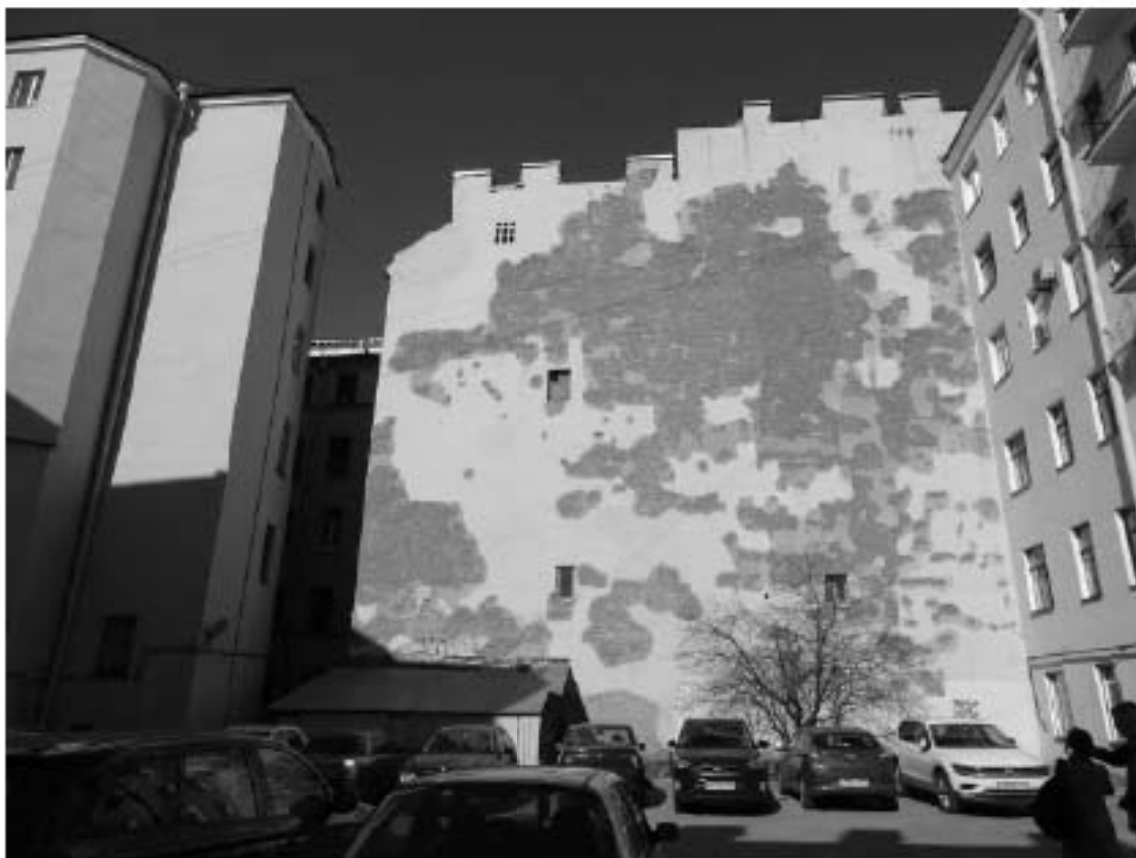
Фото 15. Здание по адресу: г. Санкт-Петербург, Большой проспект П.С., дом 45, литера А. Юго-западный дворовой фасад. Съемка 19.04.2021 г. Михайловская Г. В.
