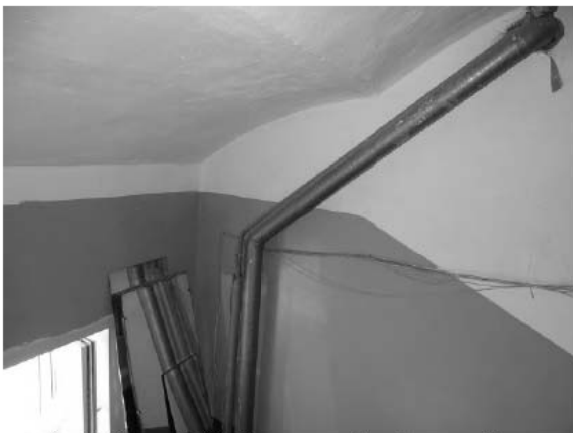
Фото 61. Лестница № 2(2): Площадка между 3-м и 4-м этажом. Своды. Съемка 19.04.2021 г. Михайловская Г. В.
