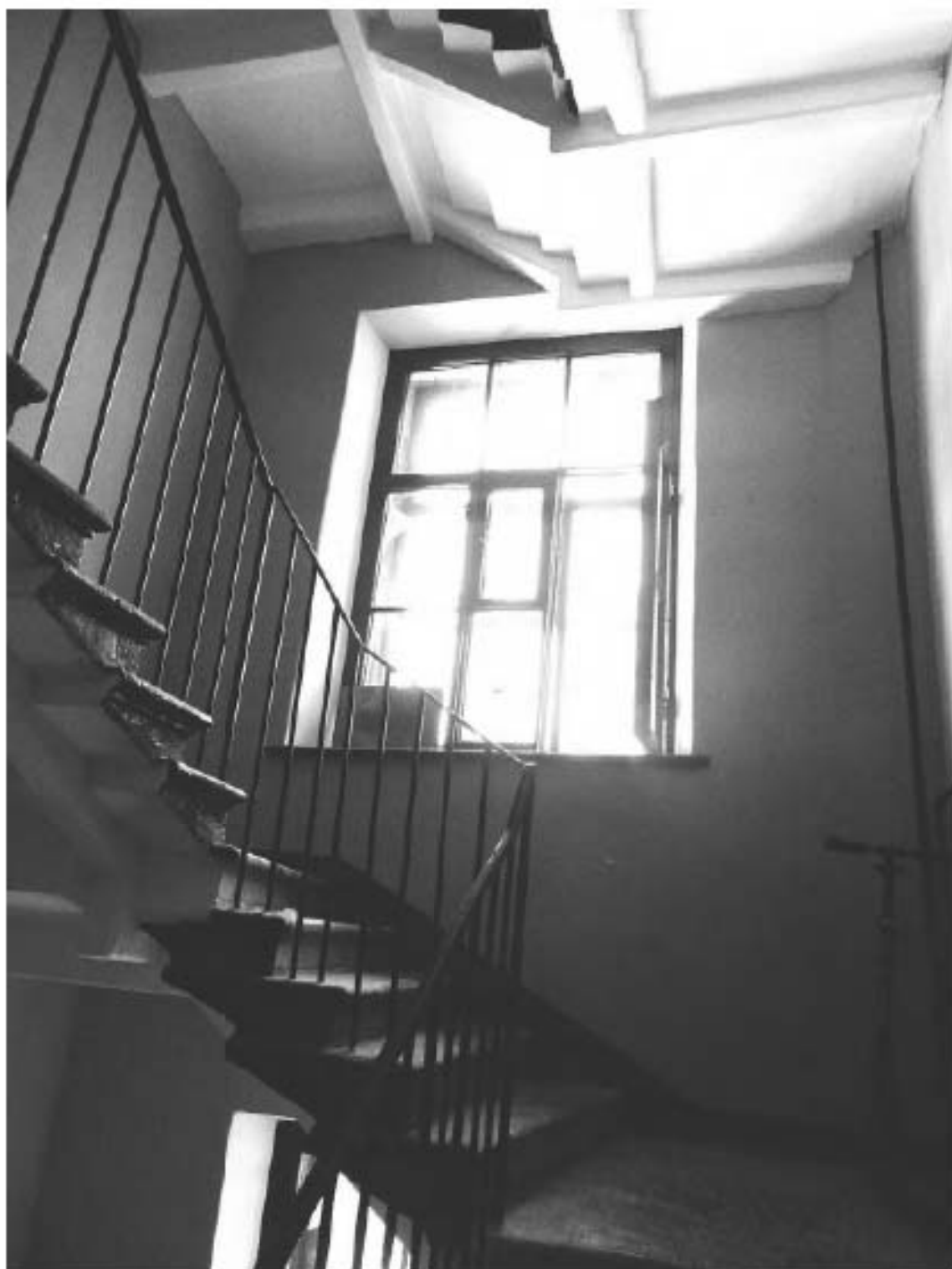
Фото 165. Лестница №6: Площадка м/у 4-м и 5-м этажом. Съемка 19.04.2021 г. Михайловская Г. В.
