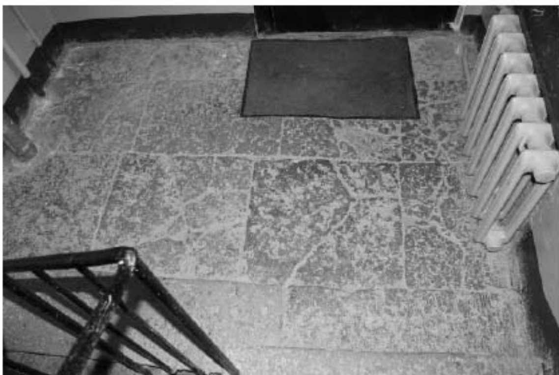
Фото 84. Лестница № 2(3): Площадка между 3-м и 4-м этажом. Покрытие пола. Съемка 19.04.2021 г. Михайловская Г. В.
