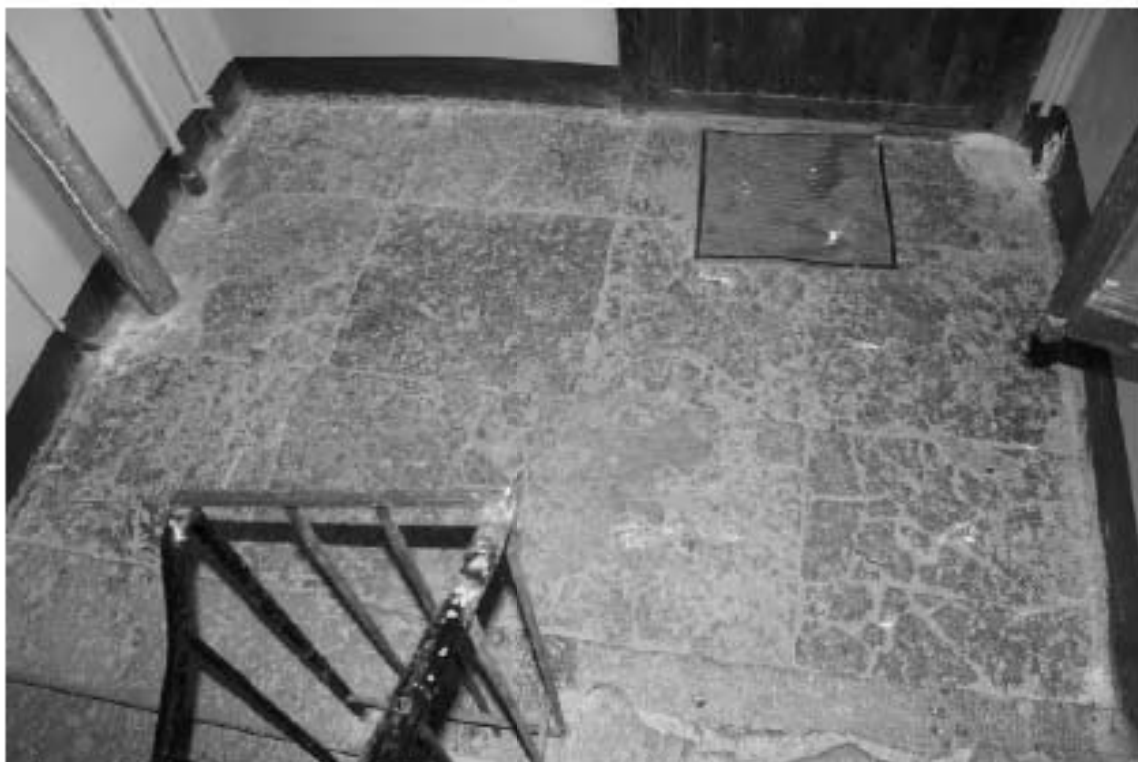
Фото 90. Лестница № 2(3): Площадка между 4-м и 5-м этажом. Покрытие пола. Съемка 19.04.2021 г. Михайловская Г. В.
