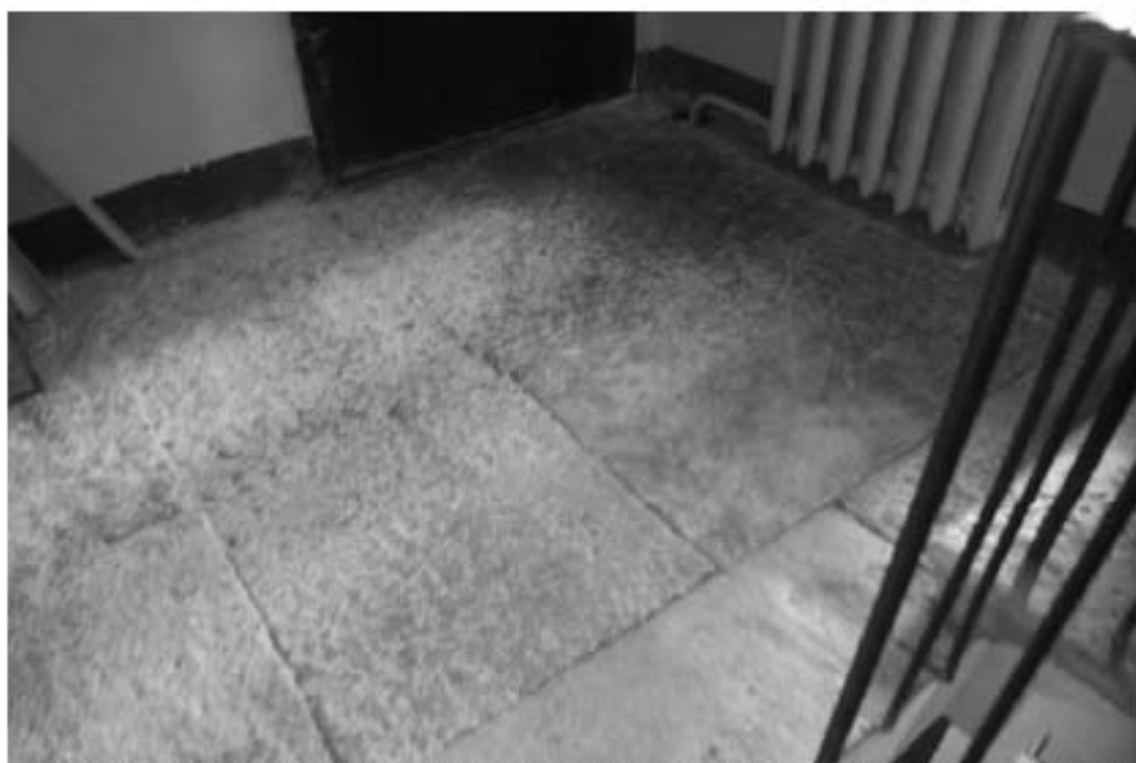
Фото 71. Лестница № 2(3): Площадка между 1-м и 2-м этажом. Покрытие пола. Съемка 19.04.2021 г. Михайловская Г. В.
