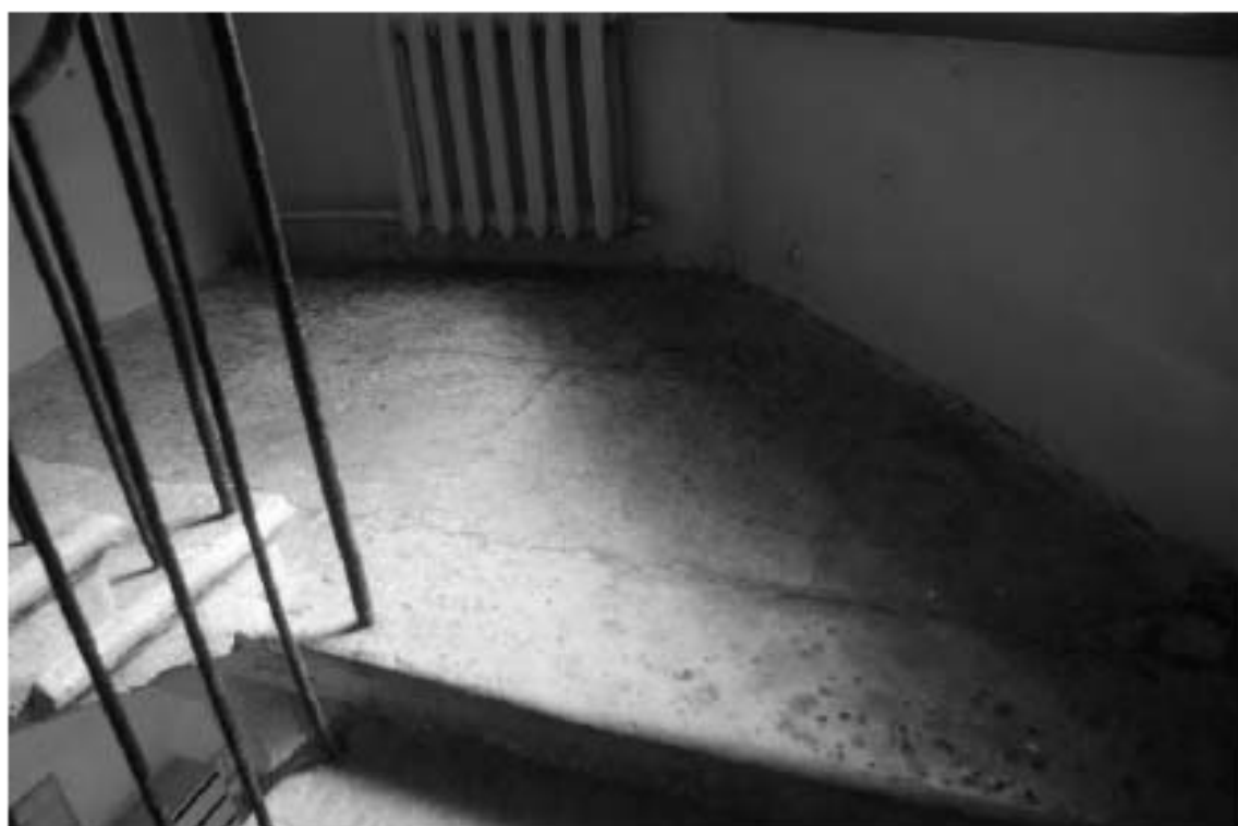
Фото 96. Лестница №4: Площадка м/у 1-м и 2-м этажом. Известняковые плиты. Съемка 19.04.2021 г. Михайловская Г. В.
