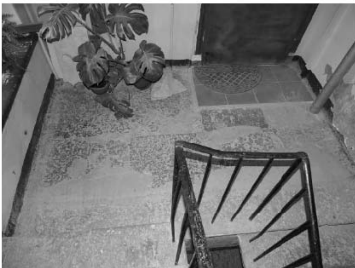
Фото 128. Лестница № 2(3): Площадка между 5-м и 6-м этажом. Покрытие пола. Съемка 19.04.2021 г. Михайловская Г. В.
