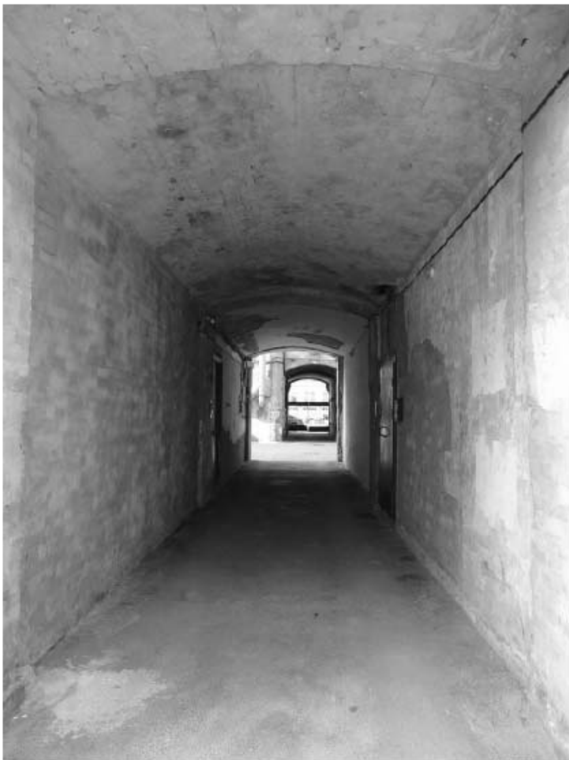
Фото 22. Здание по адресу: г. Санкт-Петербург, Большой проспект П.С., дом 45, литера А. Южный внутренний двор. Арочный проезд. Съемка 19.04.2021 г. Михайловская Г. В.
