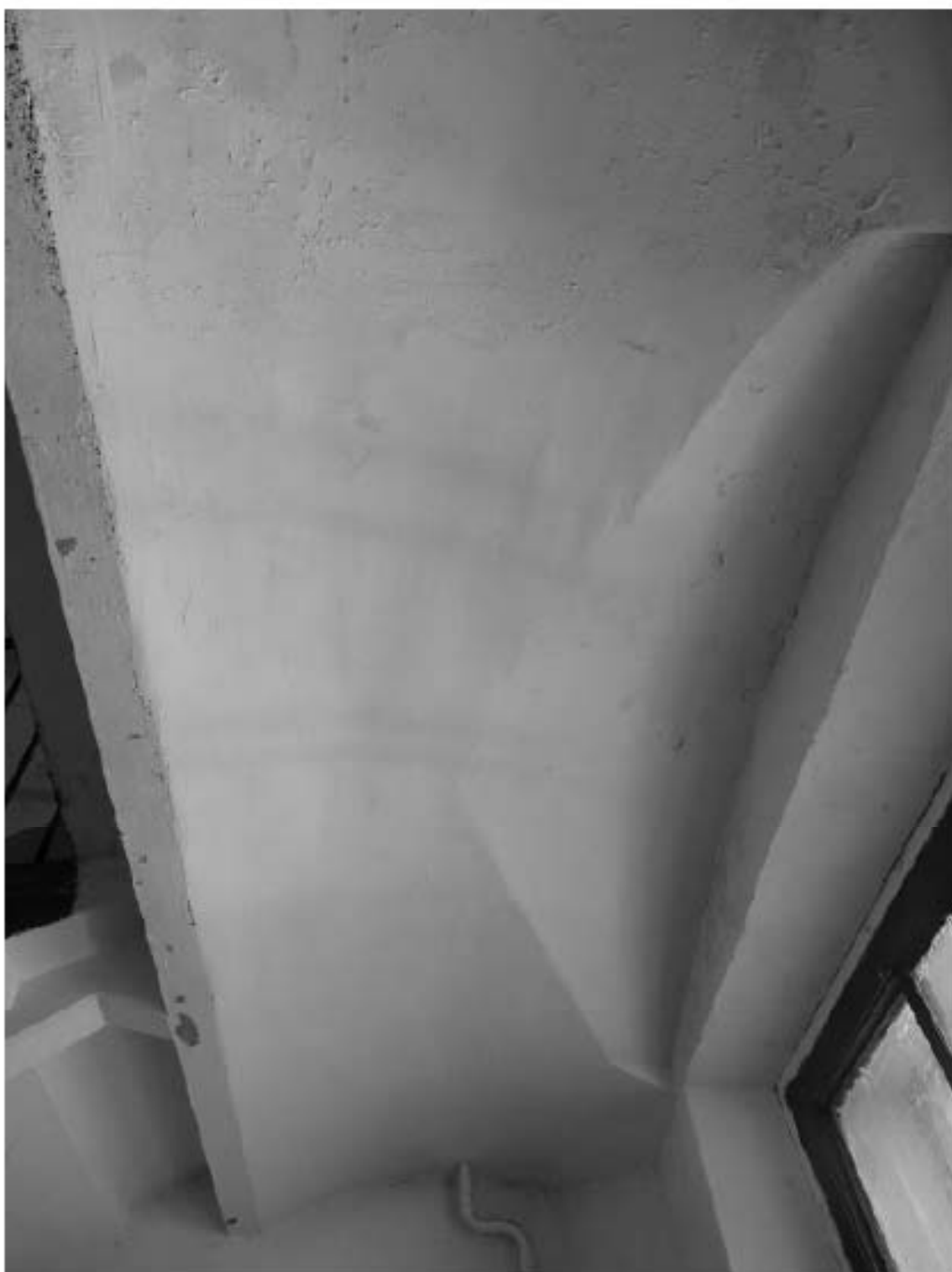
Фото 145. Лестница №4: Площадка м/у 5-м и 6-м этажом. Съемка 19.04.2021 г. Михайловская Г. В.
