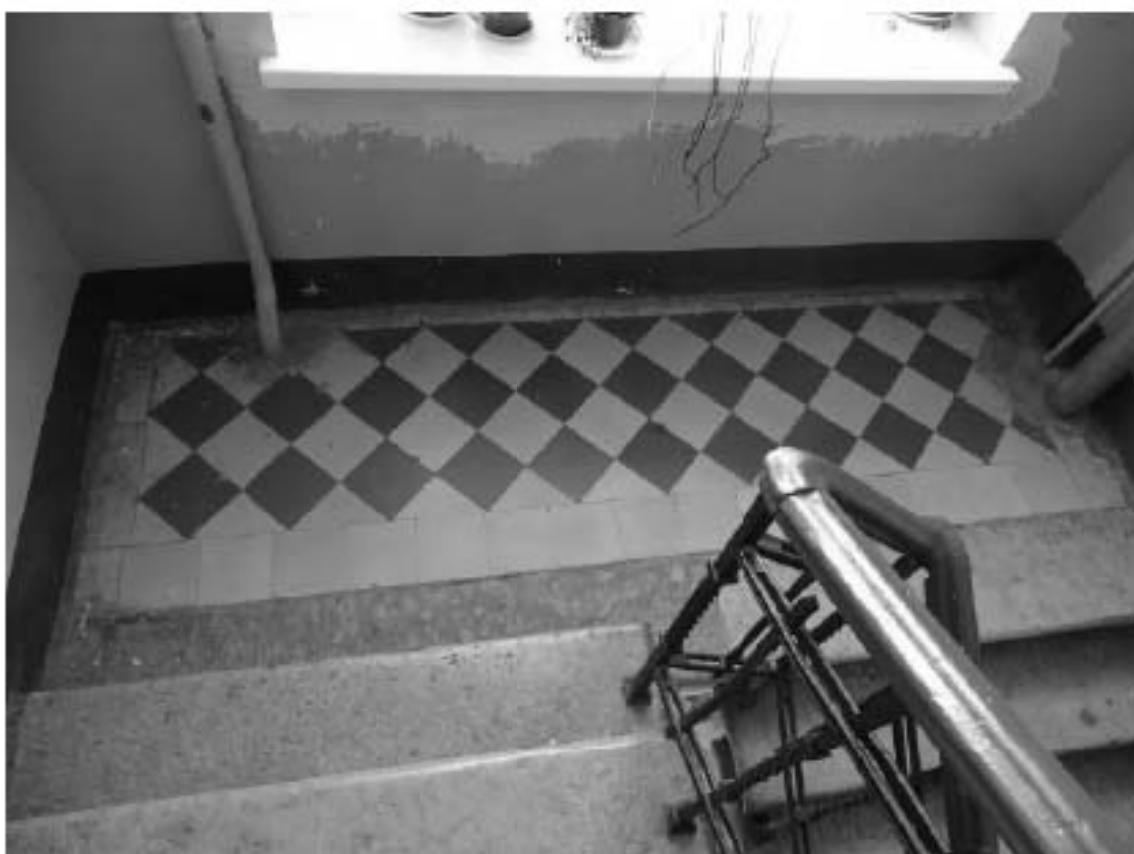
Фото 57. Лестница № 2(2): Площадка между 3-м и 4-м этажом. Покрытие пола. Съемка 19.04.2021 г. Михайловская Г. В.
