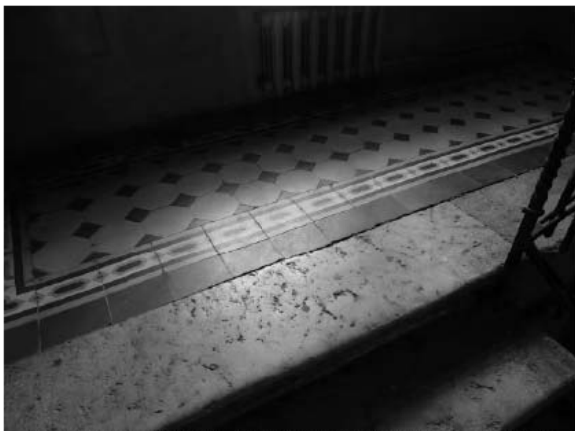
Фото 63. Лестница № 1: Площадка между 1-м и 2-м этажом. Покрытие пола. Съемка 19.04.2021 г. Михайловская Г. В.
