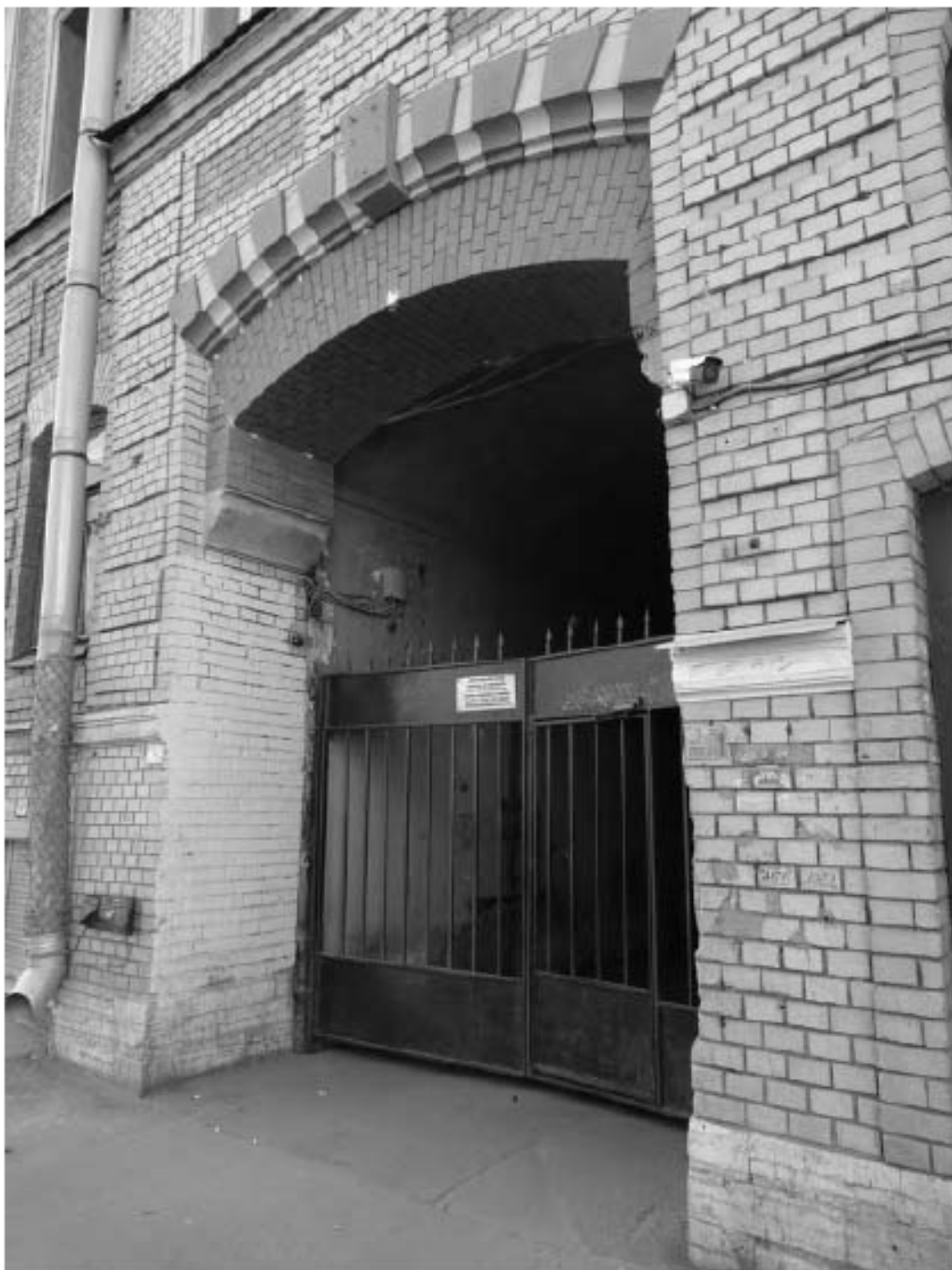
Фото 28. Здание по адресу: г. Санкт-Петербург, Большая Пушкарская улица, дом 38, литера А. Лицевой корпус. Въездная арка. Съемка 19.04.2021 г. Михайловская Г. В.
