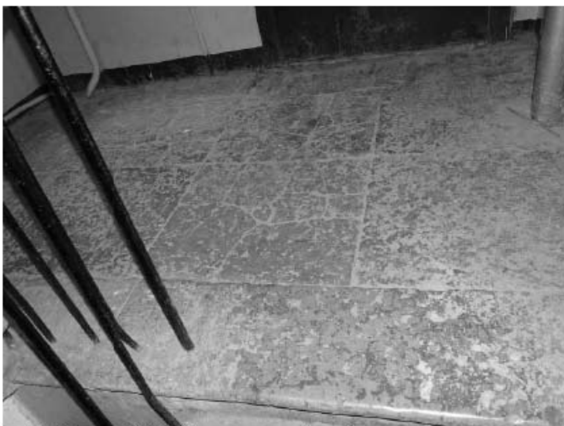
Фото 115. Лестница № 2(3): Площадка между 3-м и 4-м этажом. Известняковые плиты. Съемка 19.04.2021 г. Михайловская Г. В.
