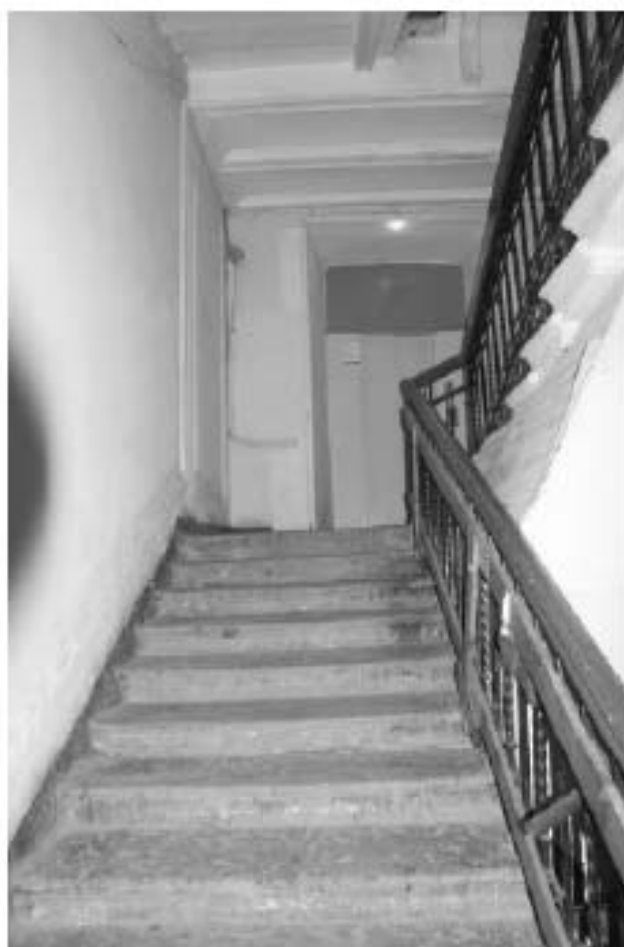
Фото 131. Лестница №2(1): Площадка м/у 1-м и 2-м этажом. Съемка 19.04.2021 г. Михайловская Г. В.
