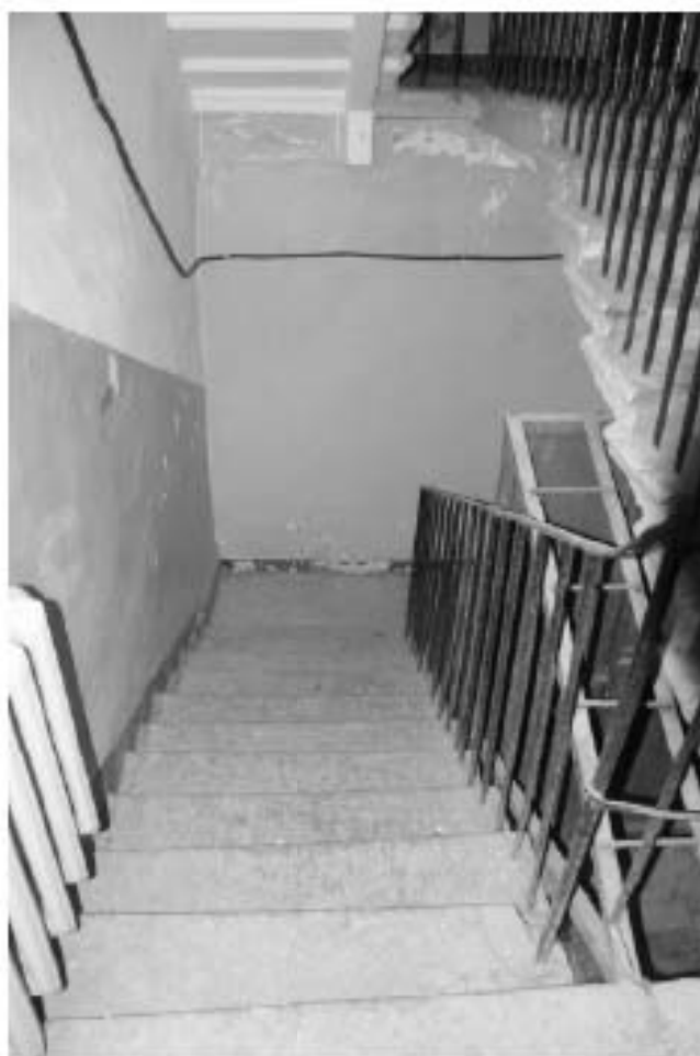
Фото 96. Лестница № 2(3): Лестница № 2(3):Площадка между 1-м и подвальным этажом. Съемка 19.04.2021 г. Михайловская Г. В.
