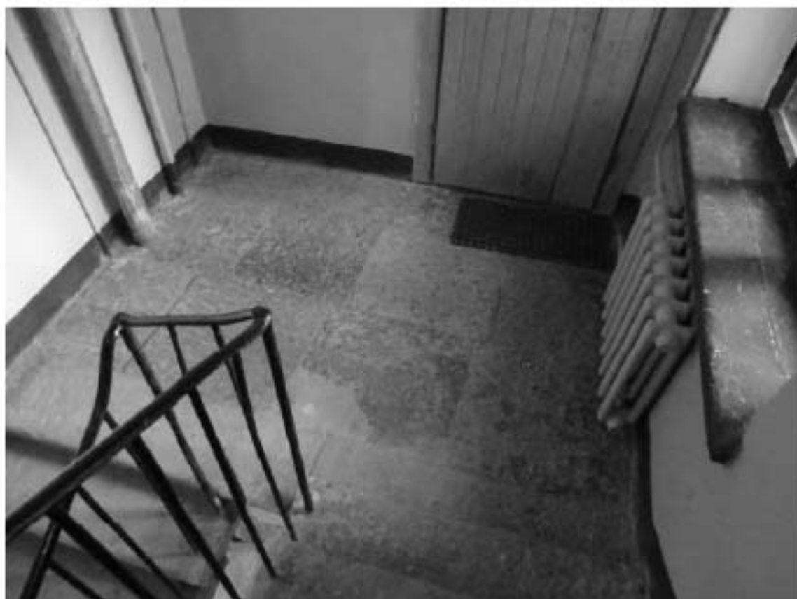
Фото 77. Лестница № 2(3): Площадка между 2-м и 3-м этажом. Покрытие пола. Съемка 19.04.2021 г. Михайловская Г. В.
