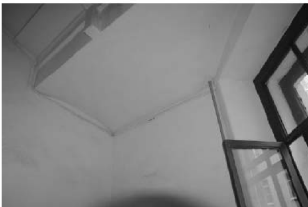
Фото 97. Лестница №4: Площадка м/у 1-м и 2-м этажом. Свод. Съемка 19.04.2021 г. Михайловская Г. В.
