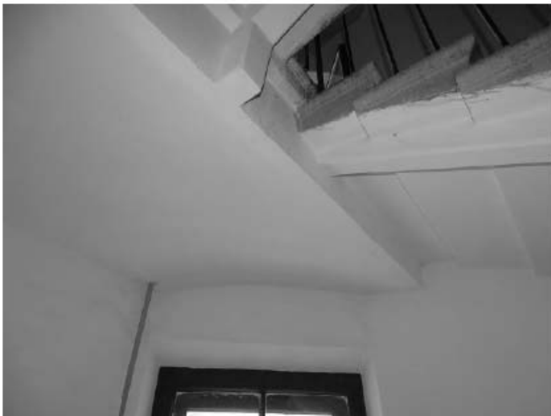
Фото 113. Лестница №4: Площадка м/у 3-м и 4-м этажом. Свод. Съемка 19.04.2021 г. Михайловская Г. В.
