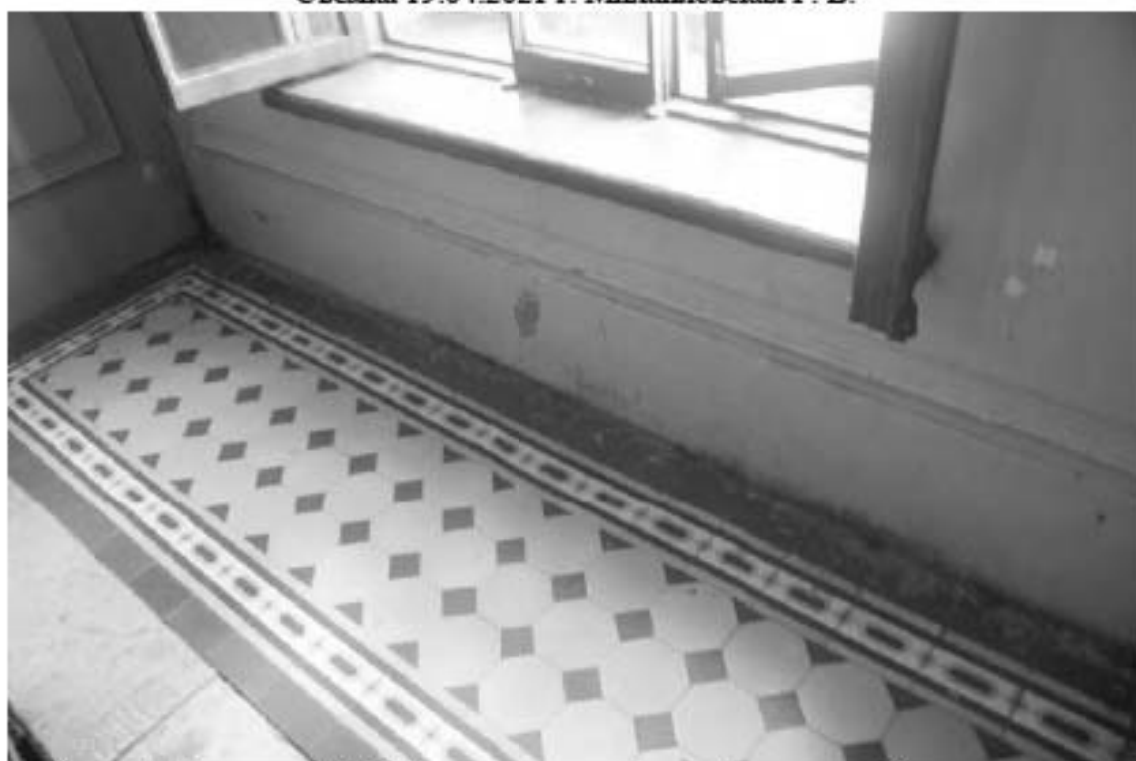
Фото 78. Лестница № 1: Площадка между 3-м и 4-м этажом. Покрытие пола. Съемка 19.04.2021 г. Михайловская Г. В.
