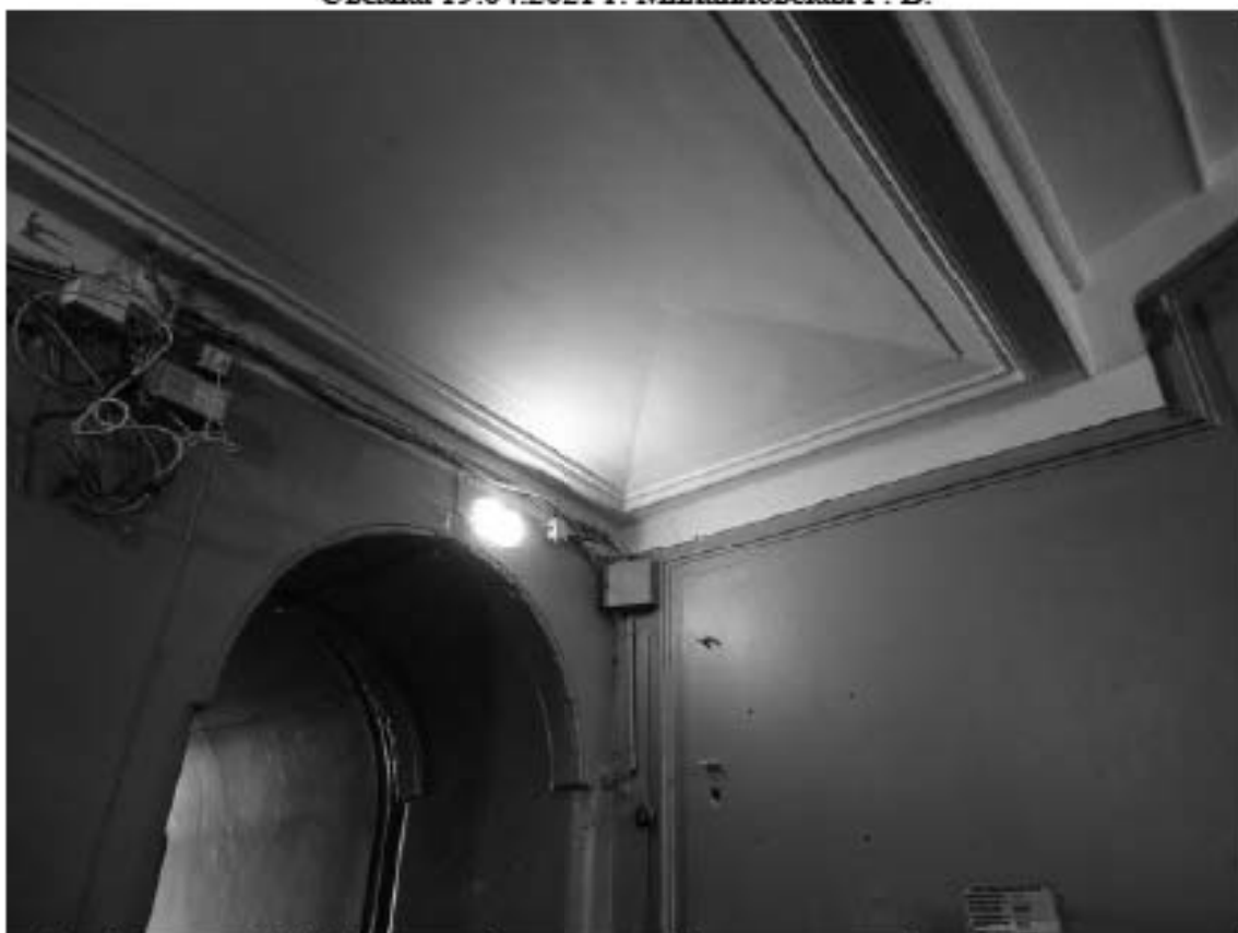
Фото 53. Лестница № 1: Площадка 1-го этажа. Декоративное оформление стен и потолка . Съемка 19.04.2021 г. Михайловская Г. В.
