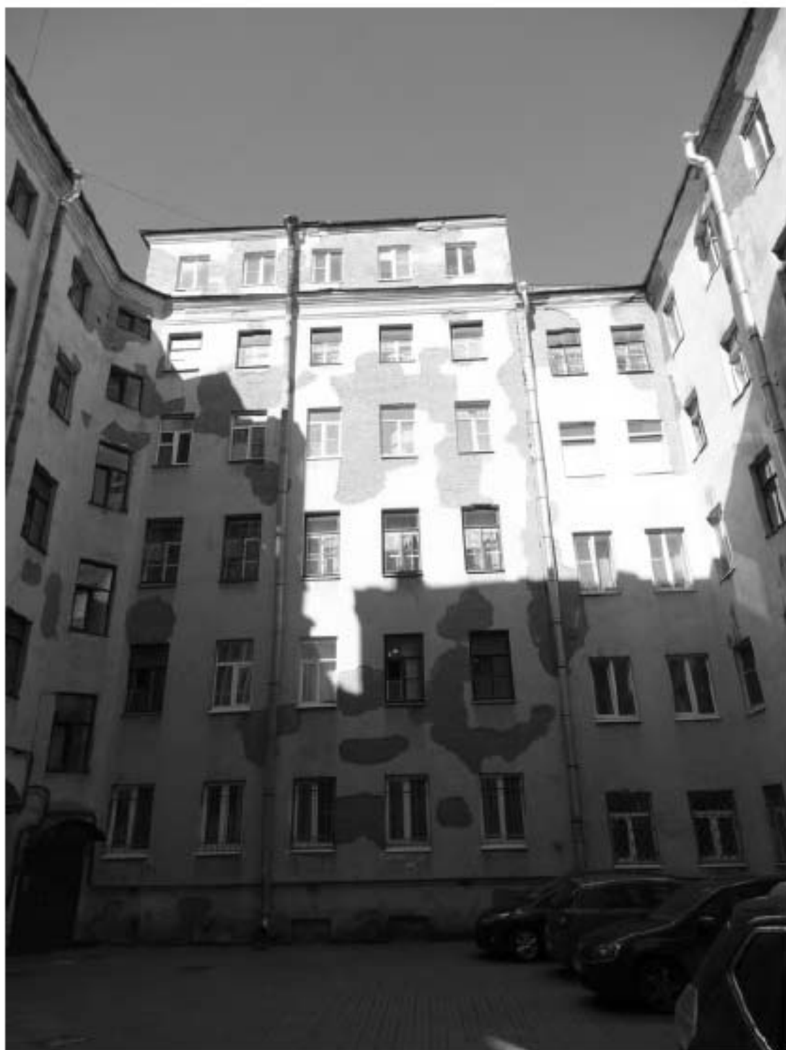
Фото 18. Здание по адресу: г. Санкт-Петербург, Большой проспект П.С., дом 45, литера А. Южный внутренний двор. Съемка 19.04.2021 г. Михайловская Г. В.
