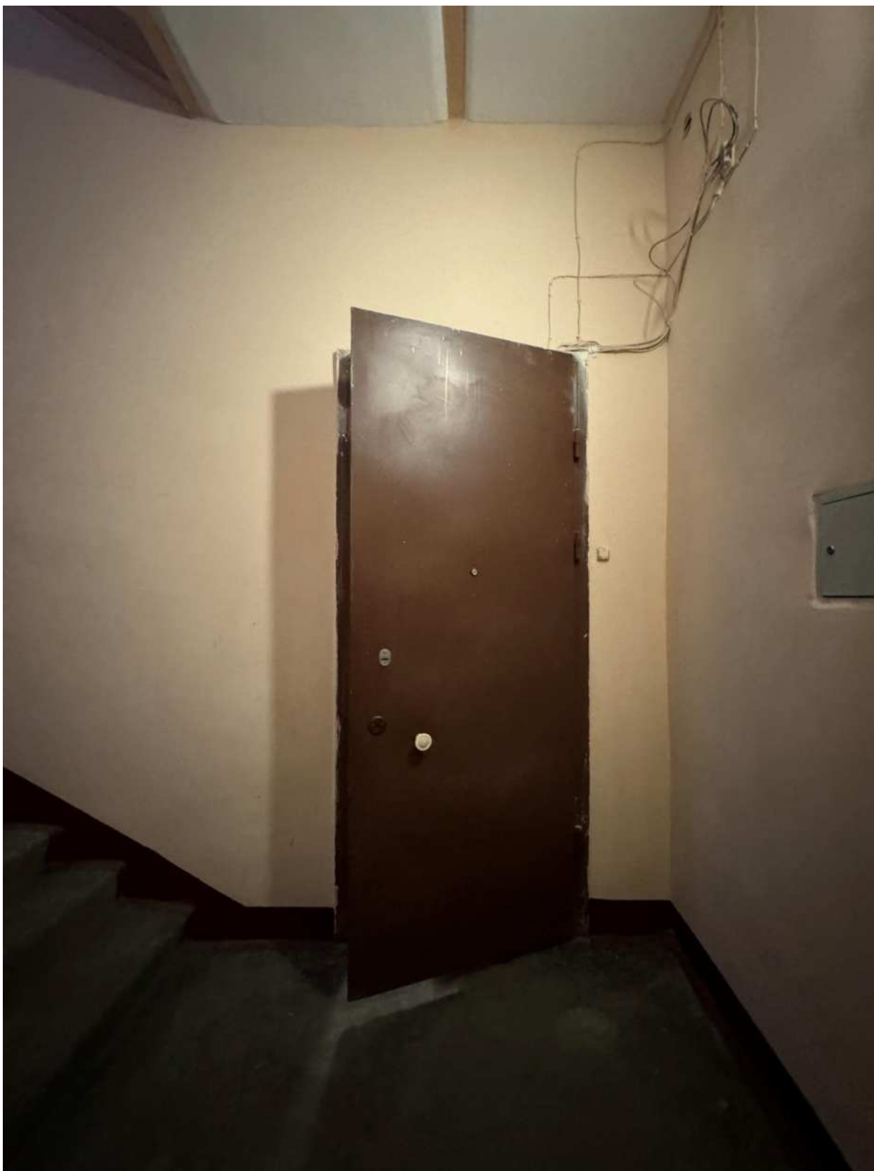
Фото 39. Дверное заполнение с лестницы смежной с помещением 9-Н объекта культурного наследия.
