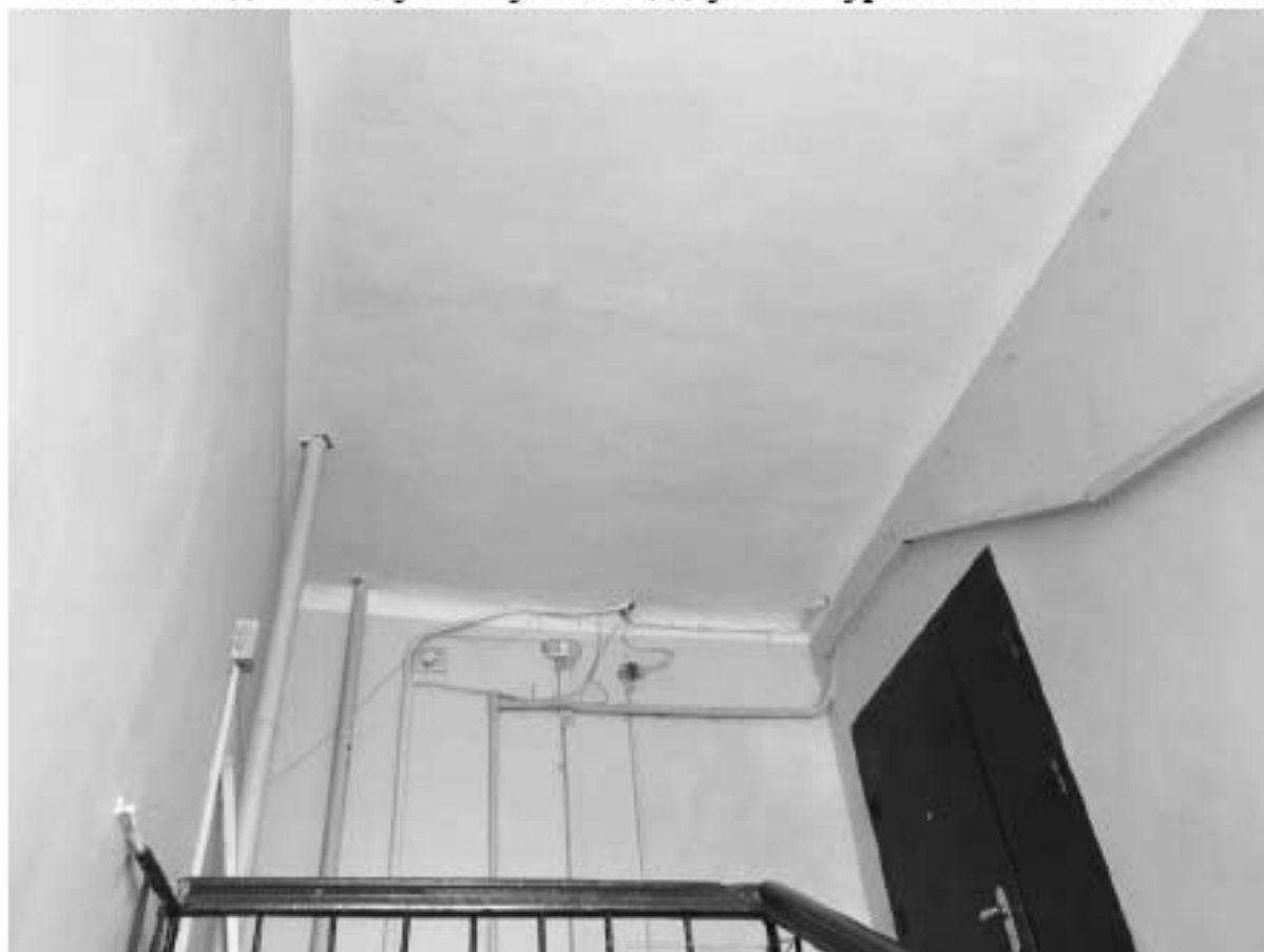
Фото 312. Вид на потолок лестничной площадки 1ЛК в уровне 5-го этажа.
