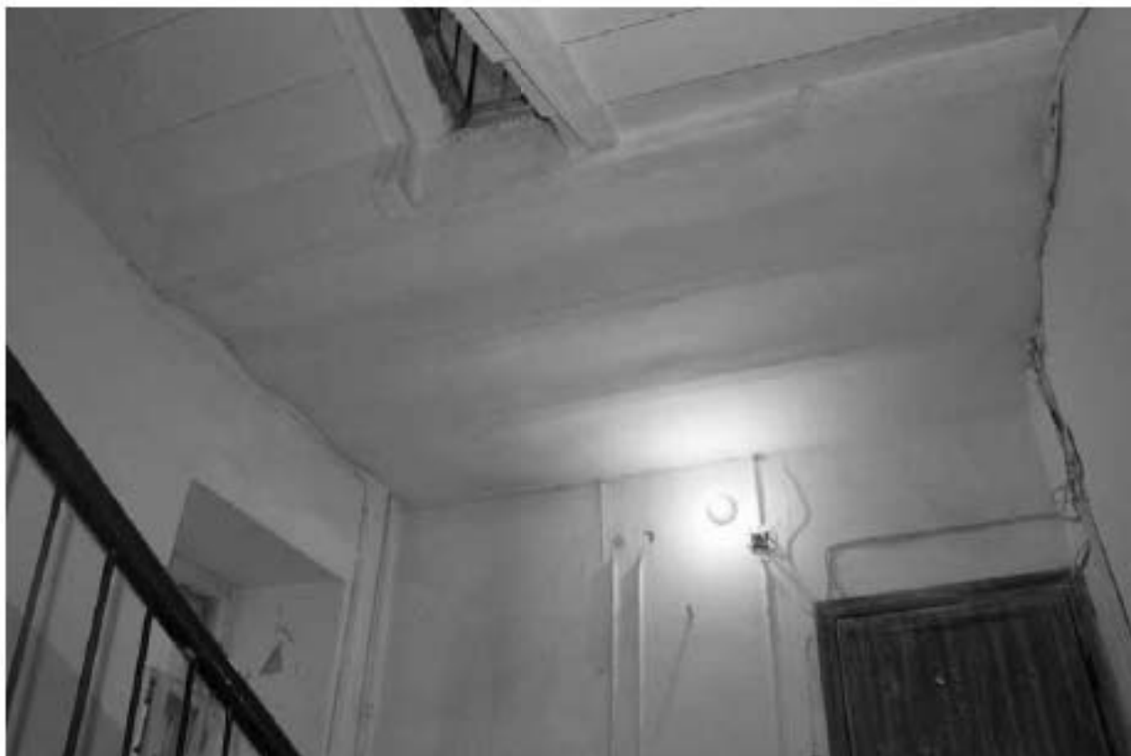
Фото 255. Вид на потолок междуэтажной площадки Л-5 в уровне 1-го – 2-го этажей.
