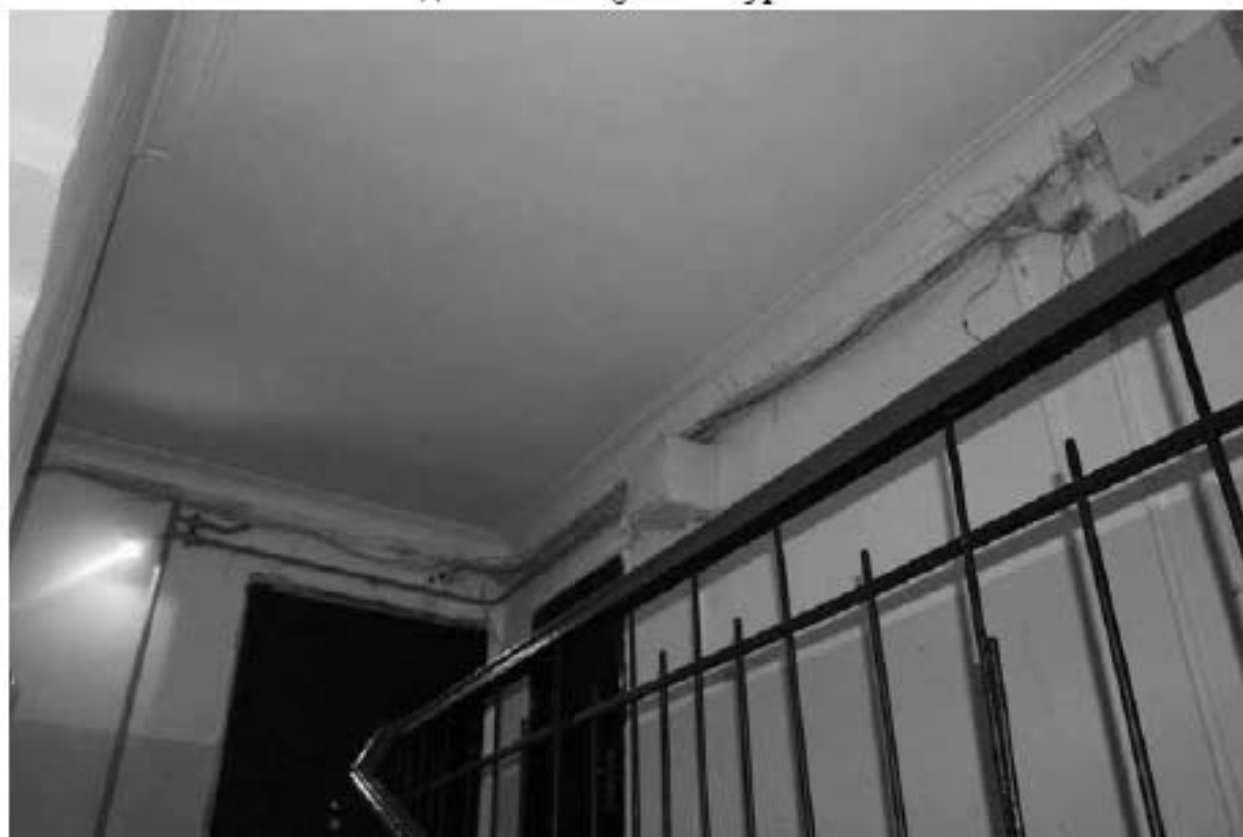
Фото 84. Вид на потолок лестничной площадки 1ЛК в уровне 6-го этажа.
