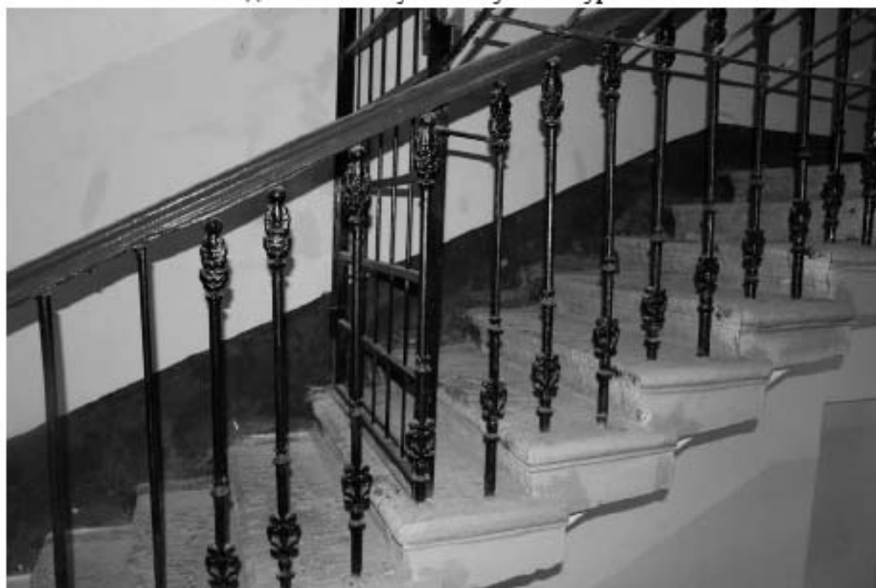
Фото 166. Вид на сохранившийся фрагмент ограждения лестничных маршей ЗЛК.
