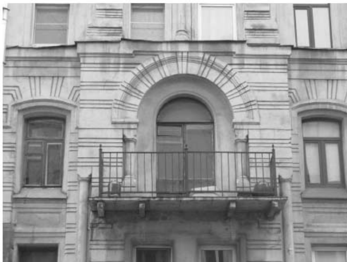
Фото 178. Вид на балкон в уровне 3-го этажа на южном фасаде южного корпуса.
