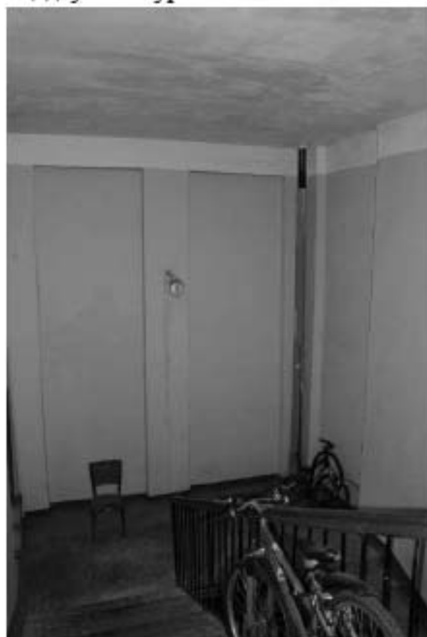
Фото 245. Вид на потолок лестничной клетки Л-2 в уровне 5-го этажа.
