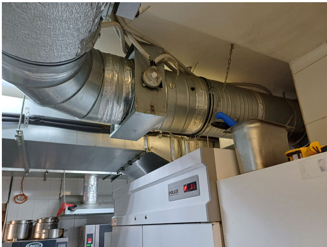
Илл. 9. Помещение 1-Н. Кухня. Съемка 18.10.2024 г. Полетайкин В.В.
