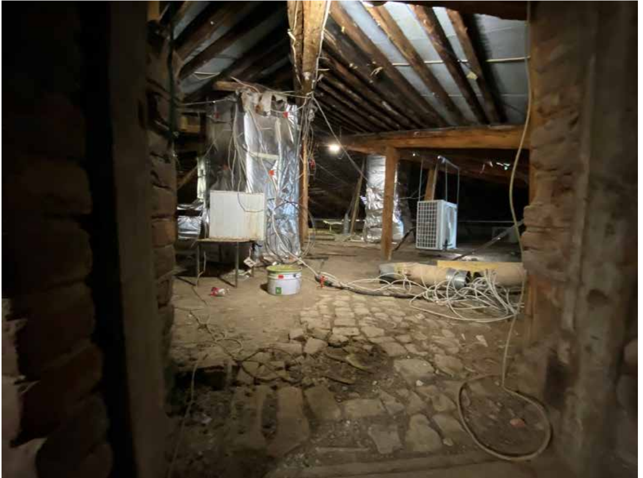
Фото 208. Чердак. Оборудование, размещенное на чердаке.
