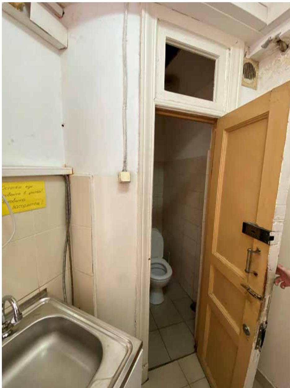
Фото 80. 1этаж. Помещение 1-Н(11) 1-Н(12)
