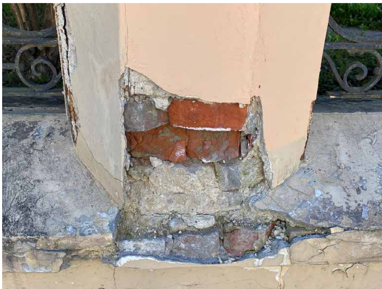
Фото 8. Дефект столба садового ограждения со стороны Оранжерейной улицы.
