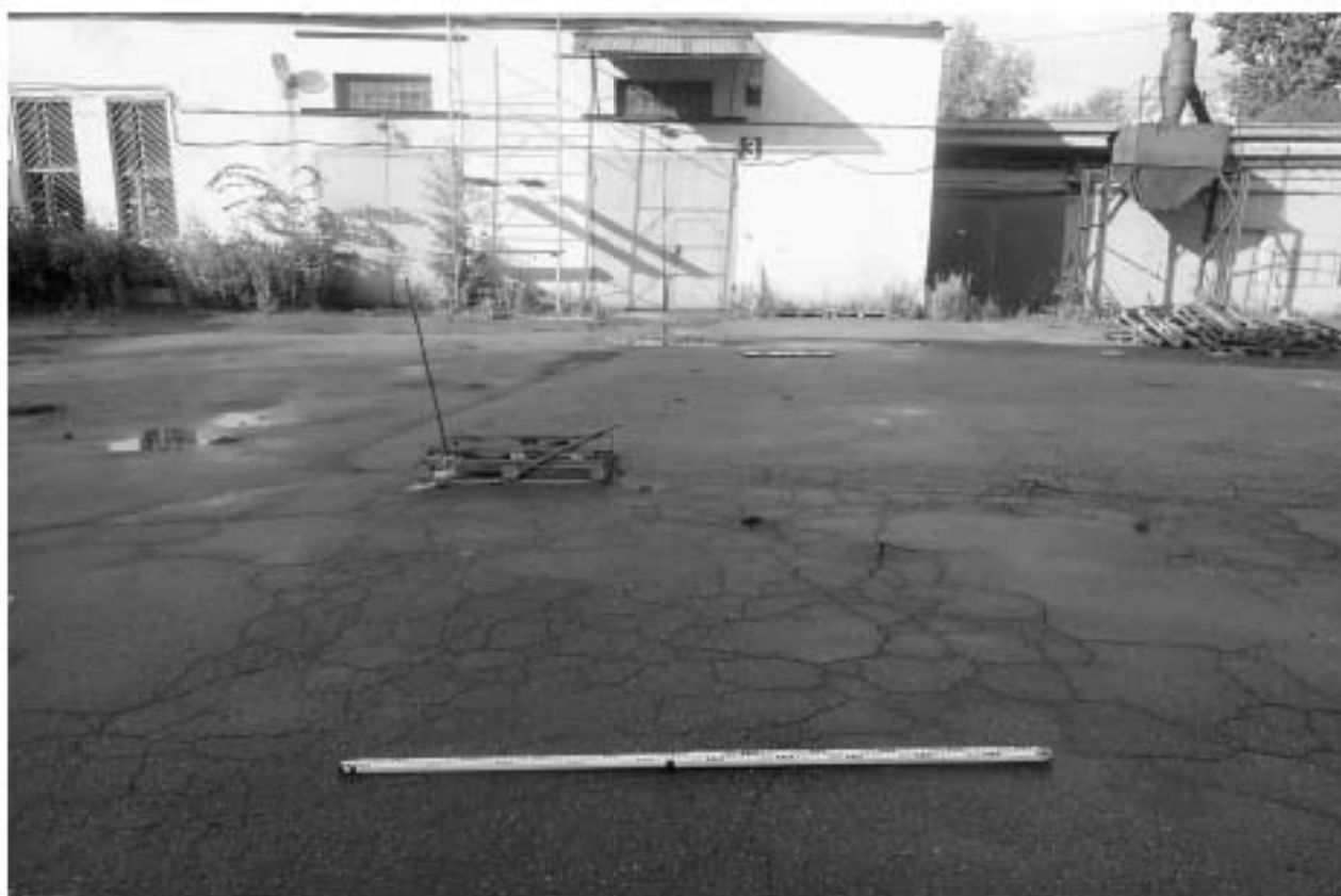
Илл. 43. г. Санкт-Петербург. ул. Коли Томчака, д. 21, литера В, кад. №78:14:0007532:30. Шурф №2. До начала работ. Вид с юга.
