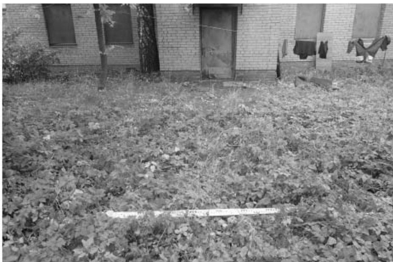
Илл. 26. г. Санкт-Петербург, ул. Коли Томчака, д. 21, литера В, кад. № 78:14:0007532:30. Шурф № 1. До начала работ. Вид с юга.
