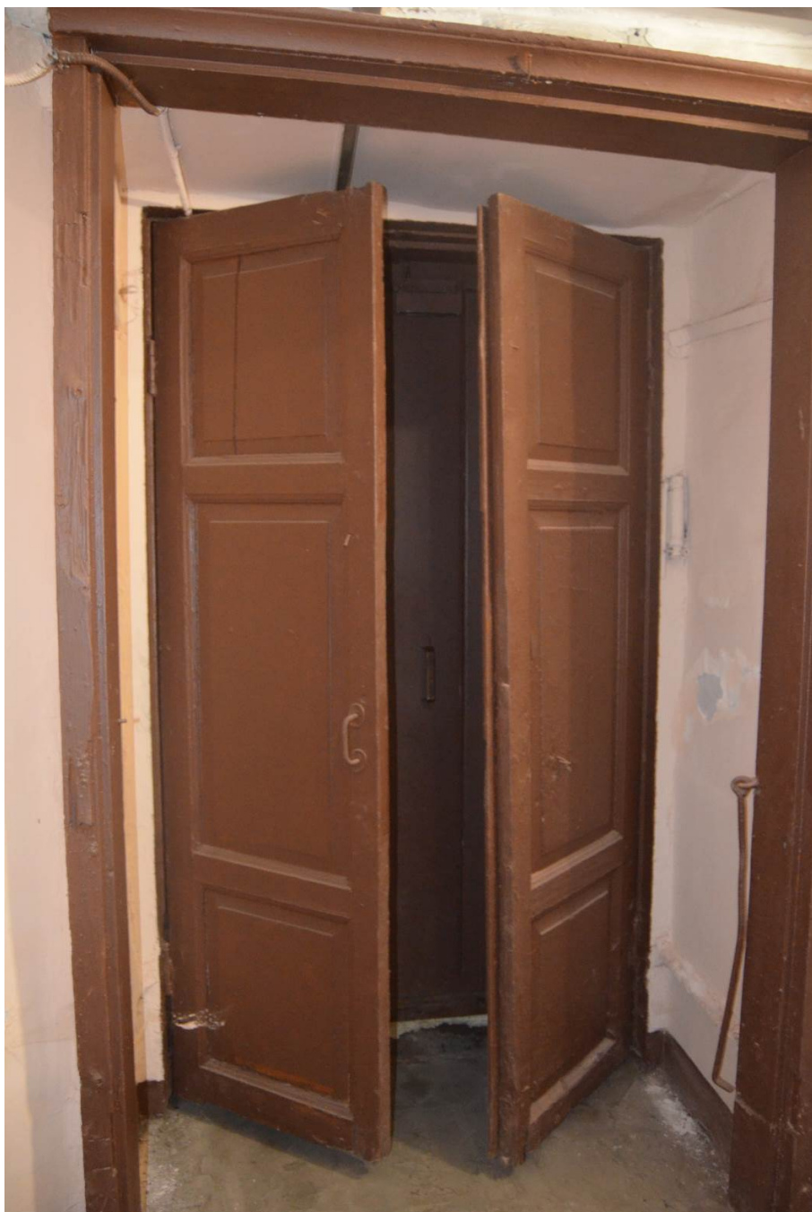
48. Выявленный объект культурного наследия «Дом Сироткиных». Лестница северного дворового флигеля (Л4). Исторический деревянный тамбур. Вид с северо-востока. Съемка 26.04.2021
