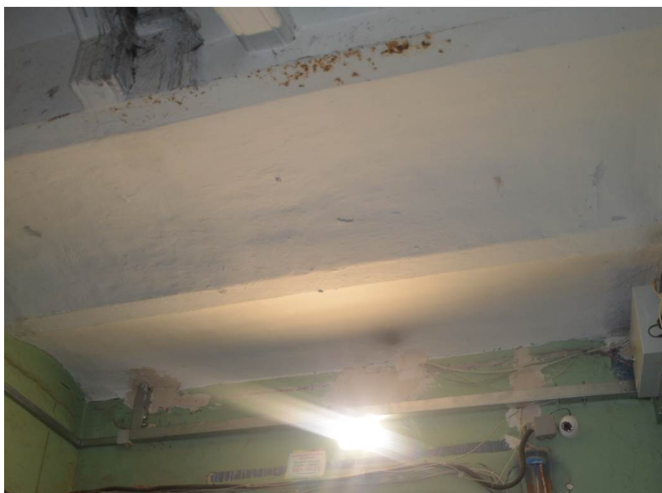
42. Выявленный объект культурного наследия «Дом Сироткиных». Лестница юго-восточного дворового флигеля (ЛЗ). Мозаичное оформление пола площадки первого этажа. Конструкция сводов этажных площадок. Вид с запада. Съемка 26.04.2021.
