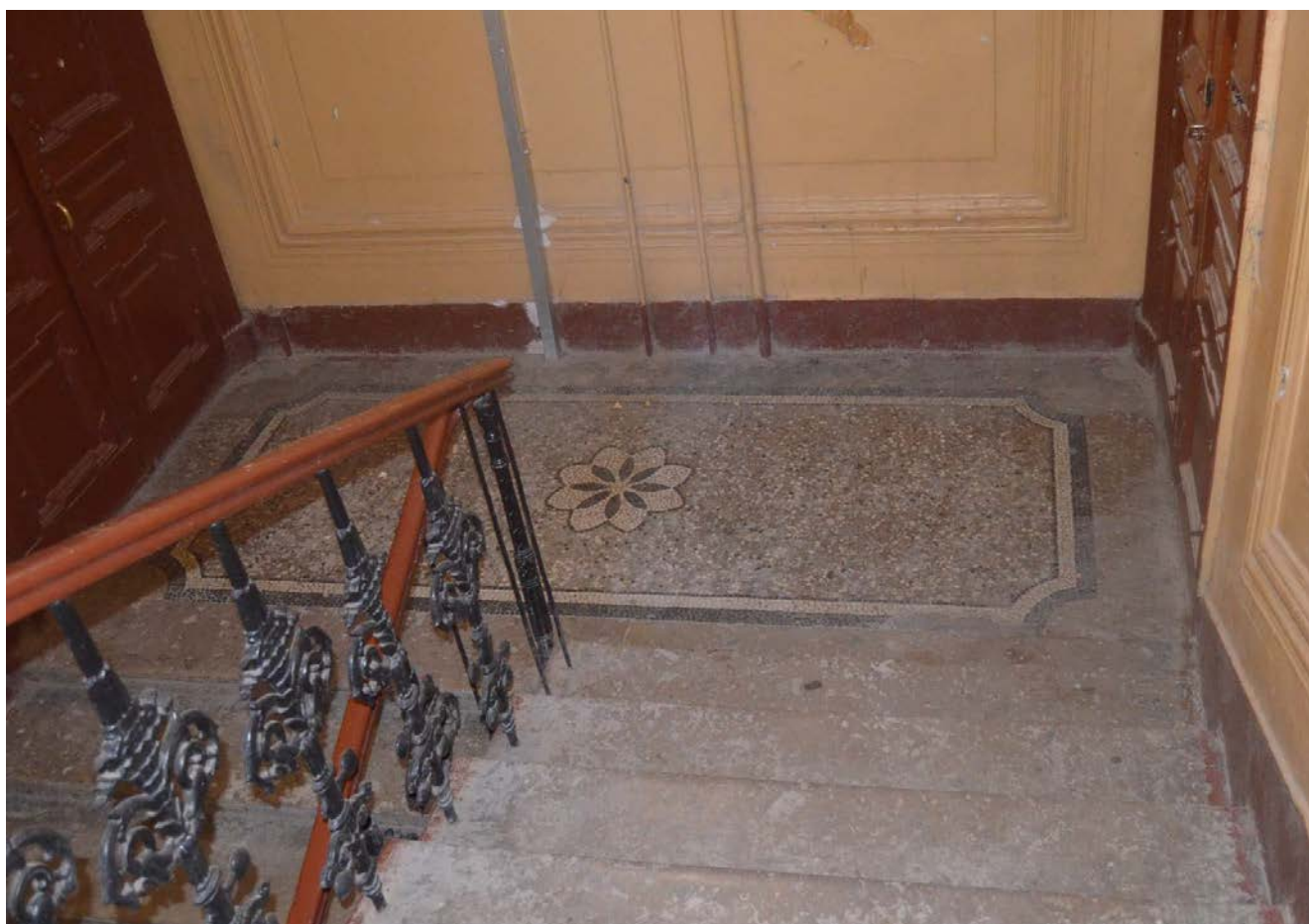
32. Выявленный объект культурного наследия «Дом Сироткиных». Парадная лестница (Л1). Мозаичная отделка пола этажной площадки третьего этажа. Вид с юга. Съемка 26.04.2021
