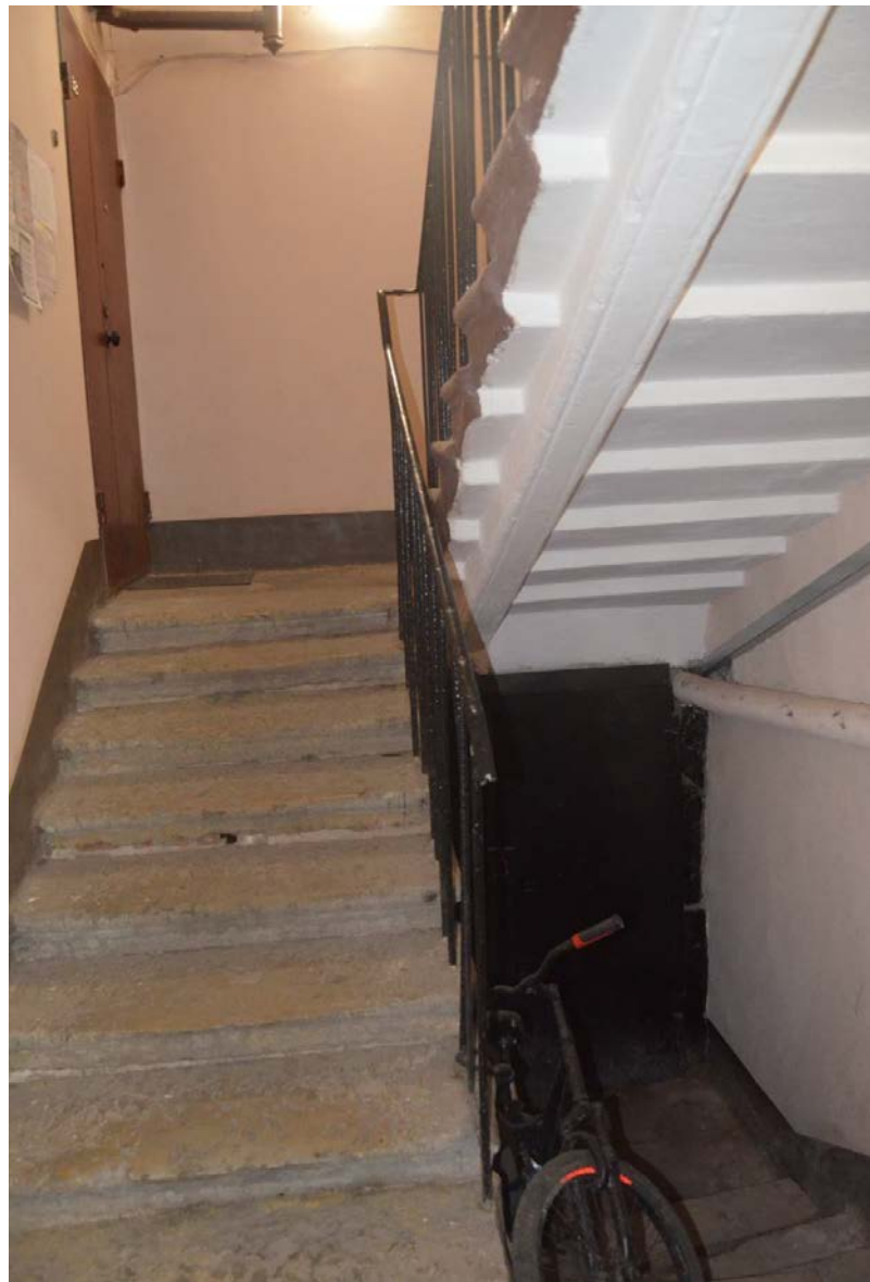
36. Выявленный объект культурного наследия «Дом Сироткиных». Лестница южного дворового флигеля (Л2). Конструкции лестничных маршей. Вид с северо-востока. Съемка 26.04.2021
