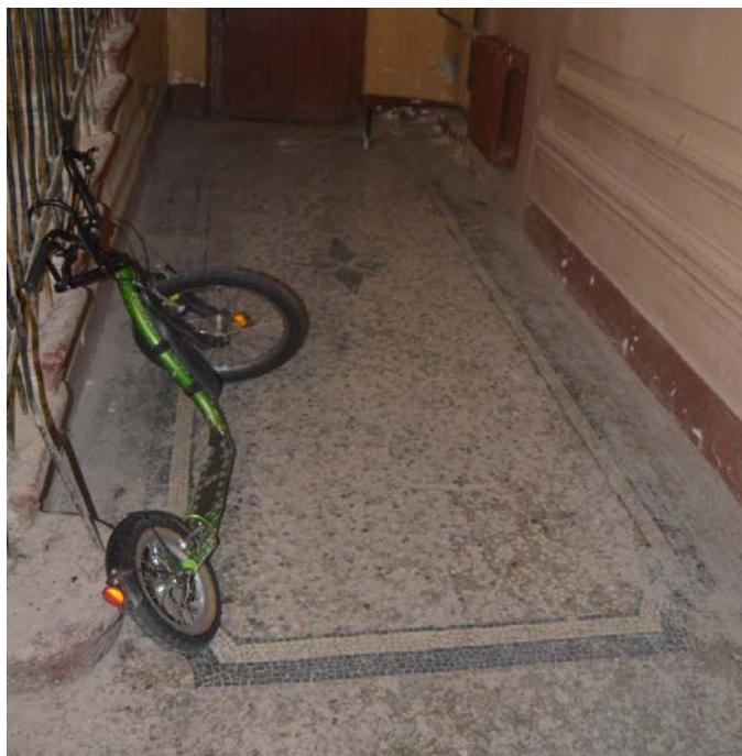
25. Выявленный объект культурного наследия «Дом Сироткиных». Парадная лестница (Л1). Мозаичная отделка пола первого этажа объема лестничной клетки. Вид с юго-востока и северо-запада. Съемка 26.04.2021
