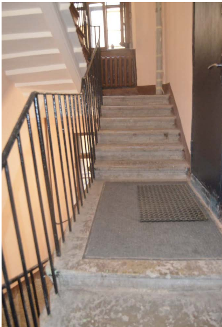
50. Выявленный объект культурного наследия «Дом Сироткиных». Лестница северного дворового флигеля (Л4). Конструкция лестничных маршей в уровне третьего этажа. Вид с северо-востока. Съемка 26.04.2021.
