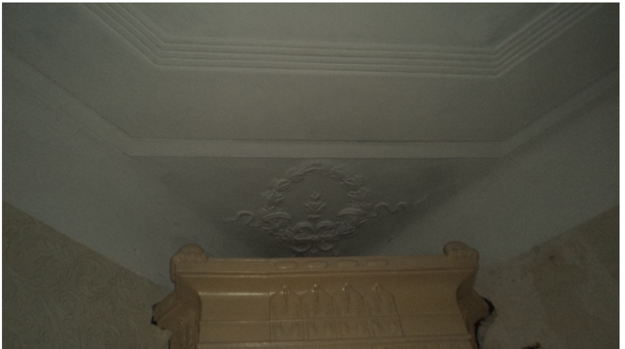
14. Выявленный объект культурного наследия «Дом П.Н. Батуева» (г. Санкт-Петербург, Грибоедова кан.наб., д. 144). Помещение квартиры № 16. Печь.
