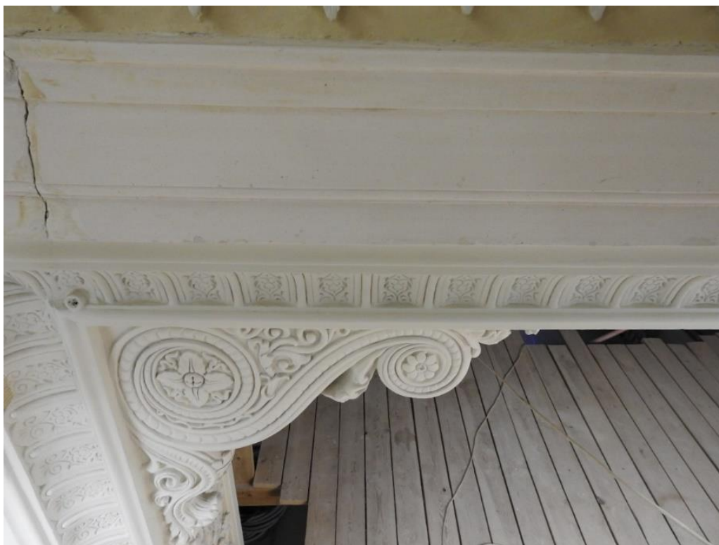
46. «Дворец Шереметевых» (г. Санкт Петербург, наб. р. Фонтанки, д. 34, лит. А). Белый зал. Западная стена. Фрагмент портала. Кронштейн. Фото 10.11.2021 г.
