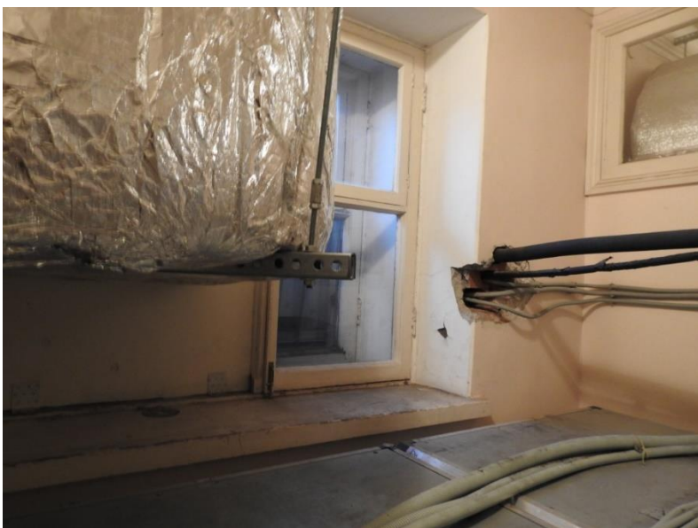
14. «Дворец Шереметевых» (г. Санкт Петербург, наб. р. Фонтанки, д. 34, лит. А). Артистические. Помещение № 5. Общий вид южной стены. Фото 10.11.2021 г.
