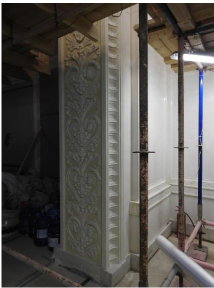
34. «Дворец Шереметевых» (г. Санкт Петербург, наб. р. Фонтанки, д. 34, лит. А). Белый зал. Портал между Аванзалом и Белым залом. Фрагмент откоса. Фото 10.11.2021 г.
