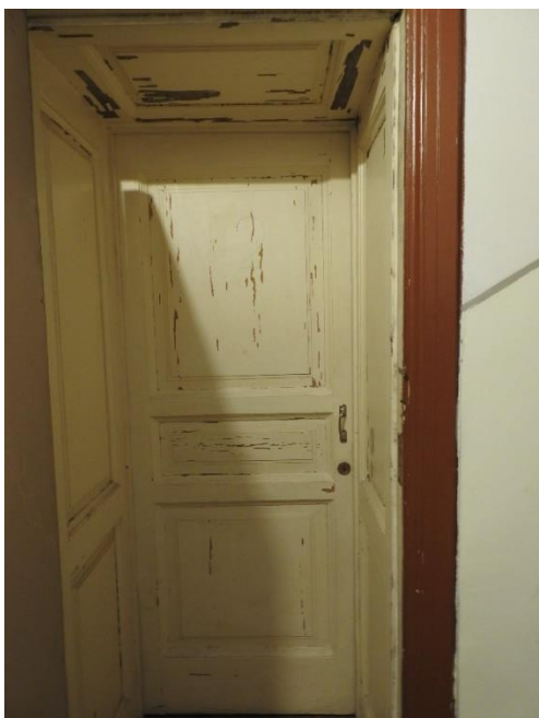
5. «Дворец Шереметевых» (г. Санкт Петербург, наб. р. Фонтанки, д. 34, лит. А). Артистические. Тамбур дверного проёма. Вид с лестничной площадки. Обшит профилированными панелями. Фото 10.11.2021 г.
