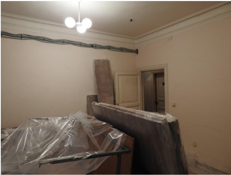
11. «Дворец Шереметевых» (г. Санкт Петербург, наб. р. Фонтанки, д. 34, лит. А). Артистические. Помещение № 2. Общий вид. Вид на юго-восточный угол. Фото 10.11.2021 г.
