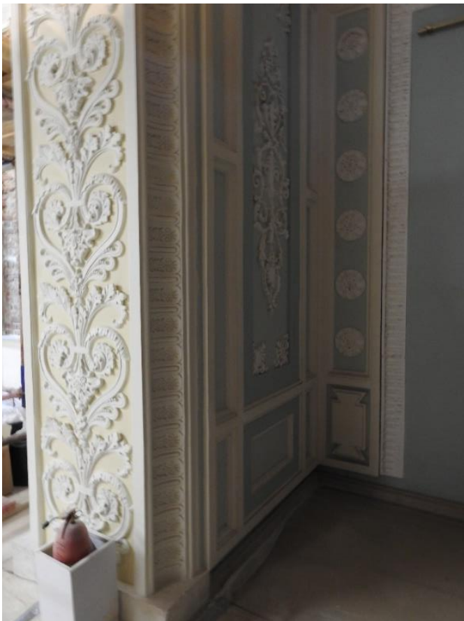
44. «Дворец Шереметевых» (г. Санкт Петербург, наб. р. Фонтанки, д. 34, лит. А). Аванзал. Портал между Аванзалом и Балым залом. Фрагмент откоса. Фото 10.11.2021 г.
