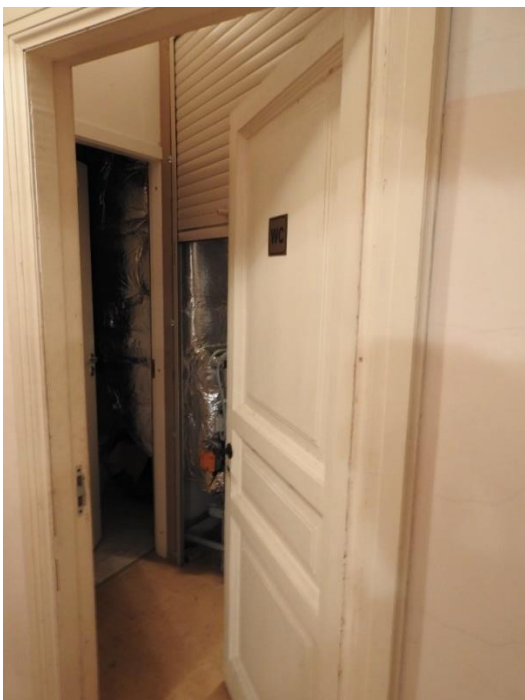
13. «Дворец Шереметевых» (г. Санкт Петербург, наб. р. Фонтанки, д. 34, лит. А). Артистические. Дверной проём в пом. 5-6. Вид из коридора (пом. 1). Фото 10.11.2021 г.
