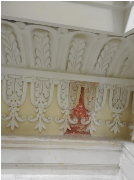
56. «Дворец Шереметевых» (г. Санкт Петербург, наб. р. Фонтанки, д. 34, лит. А). Белый зал. Северо-западный угол. Фрагмент карниза с участком пробных расчисток. Фото 10.11.2021 г.
