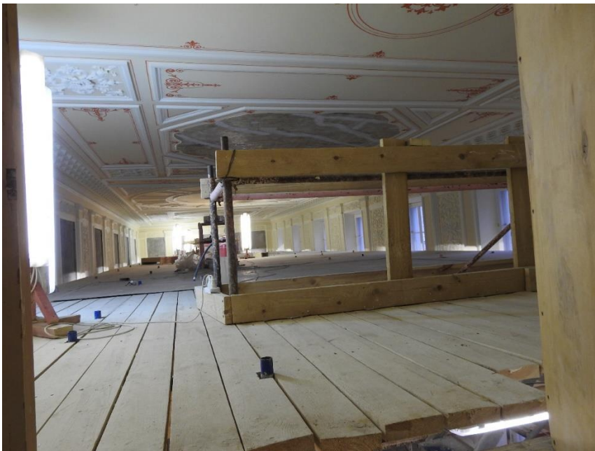
20. «Дворец Шереметевых» (г. Санкт Петербург, наб. р. Фонтанки, д. 34, лит. А). Артистические. Помещение № 4. Вид на Белый зал из окна. Фото 10.11.2021 г.
