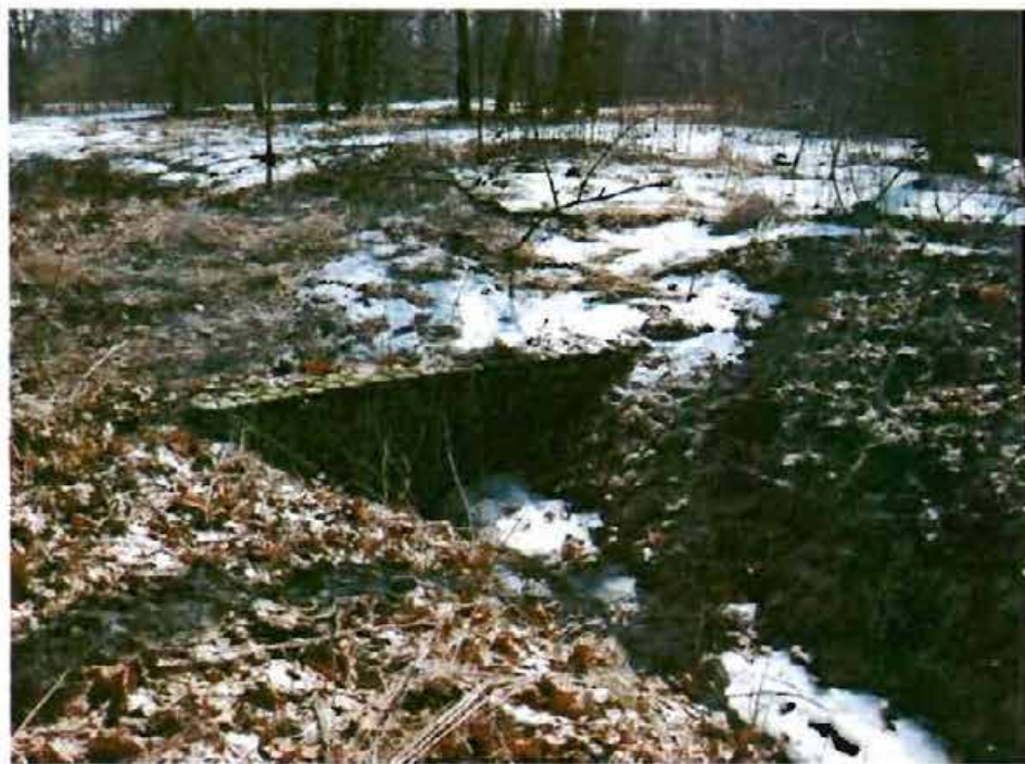
1,2. Юго-восточная часть объекта культурного наследия федерального значения «Парк». Мелиоративный канал, оголовок трубоперехода
