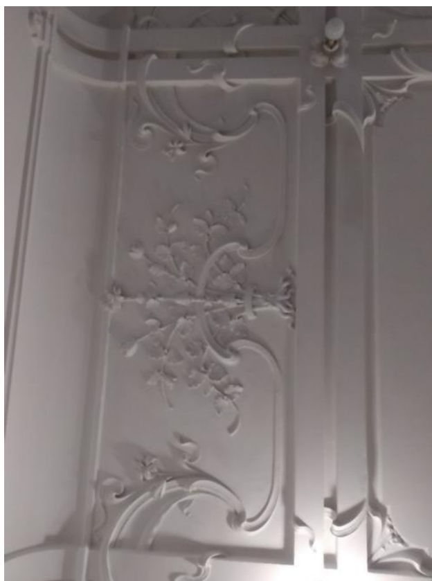
Фото 19. Фрагмент потолка в пом. № 2.
