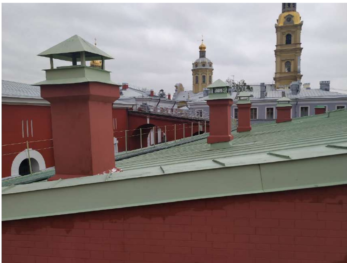
Фото 26. Кирпичные вентканалы. 29 ноября 2024г.
