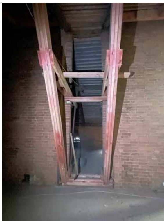
Фото 43. Чердак в границах проектирования.
