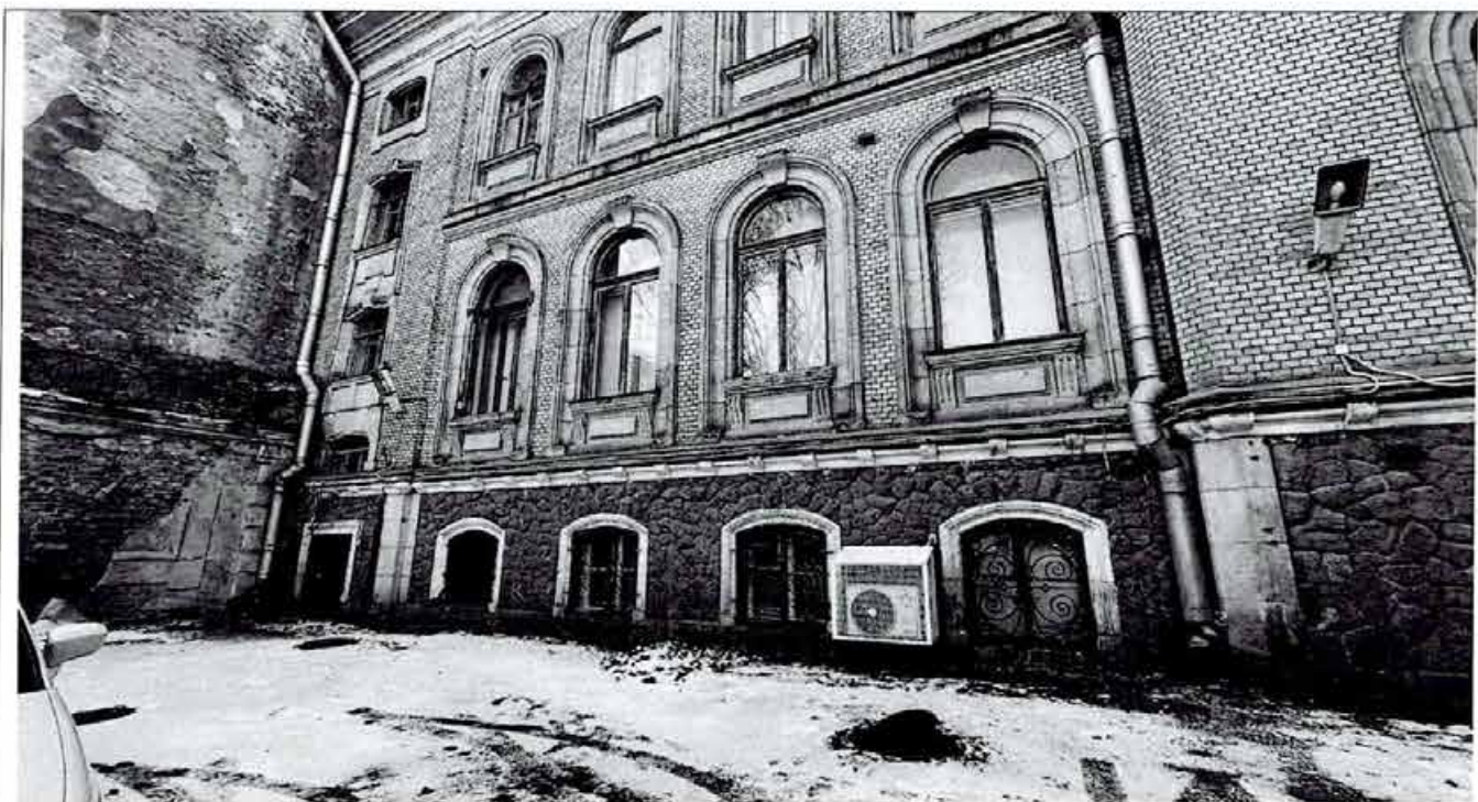
8. Фрагмент дворового фасада. На дворовом фасаде в уровне цокольного - 1-го этажей и на каркасе с установкой на асфальт имеются 4 наружных блока системы кондиционирования
