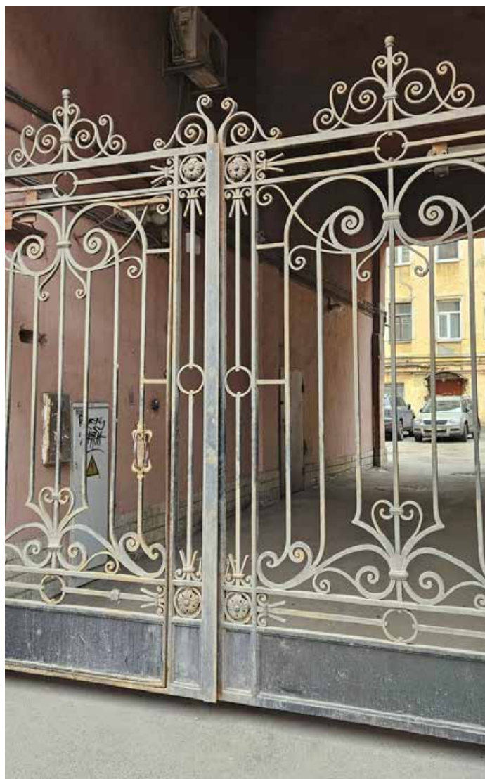
5. Выявленный объект культурного наследия «Дом П.И. Лихачева», Владимирский пр., д.3. Воротное заполнение.
