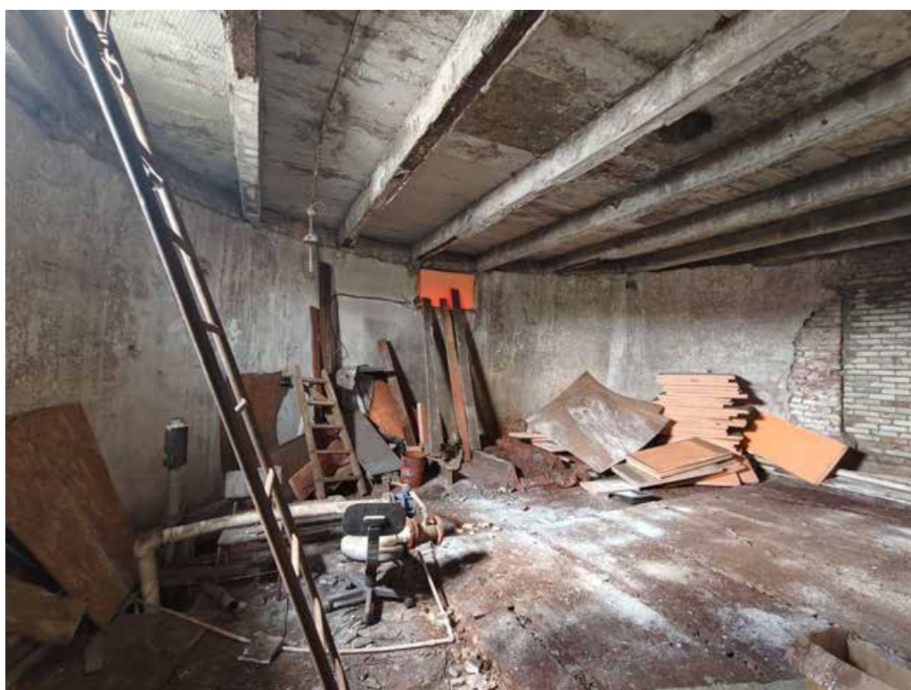
Фото 18. Интерьер котельной здания на территории объекта культурного наследия регионального значения «Круглая баня»
