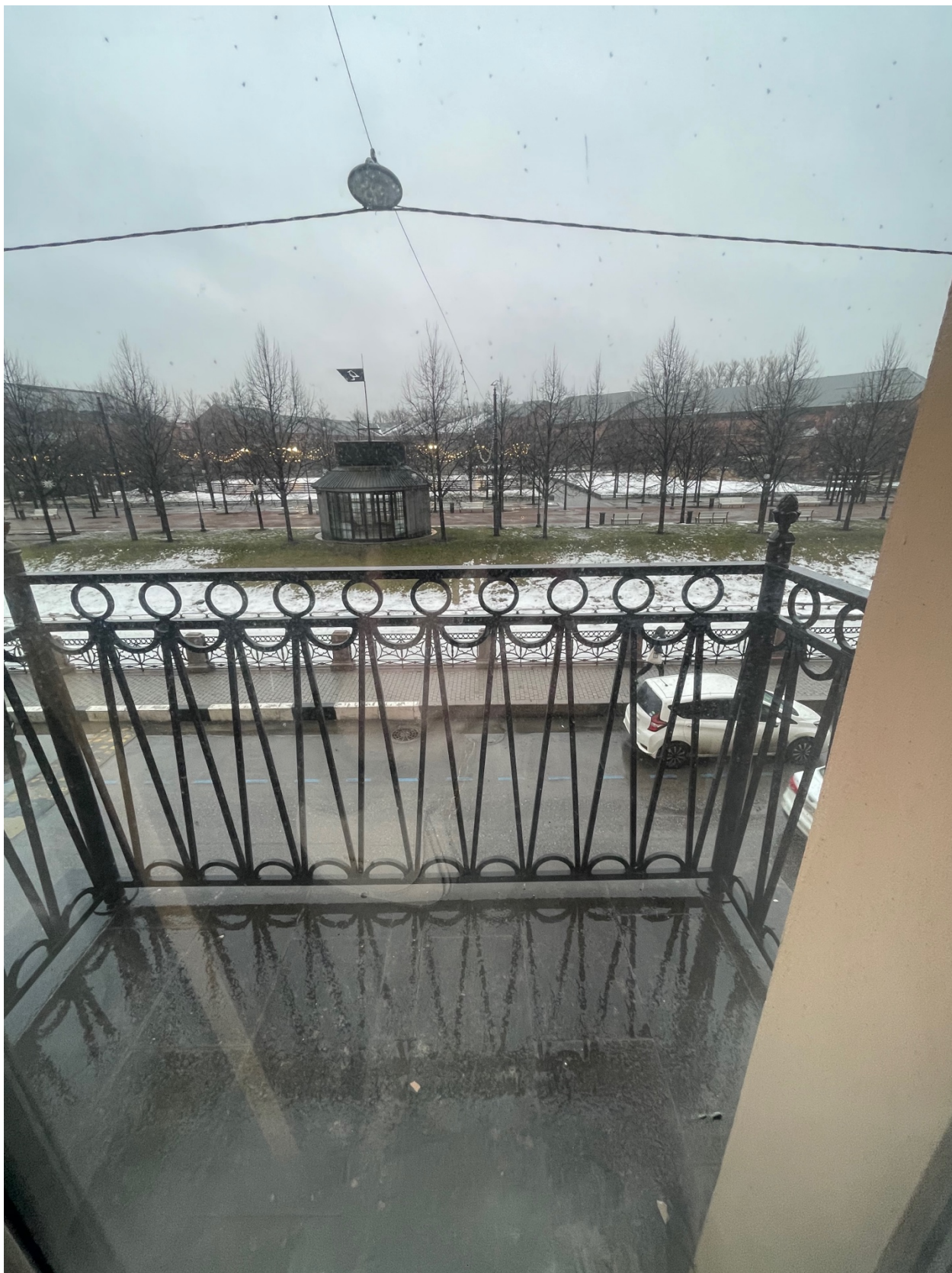
19.Балкон со стороны лицевого фасада, помещение 97-Н.
