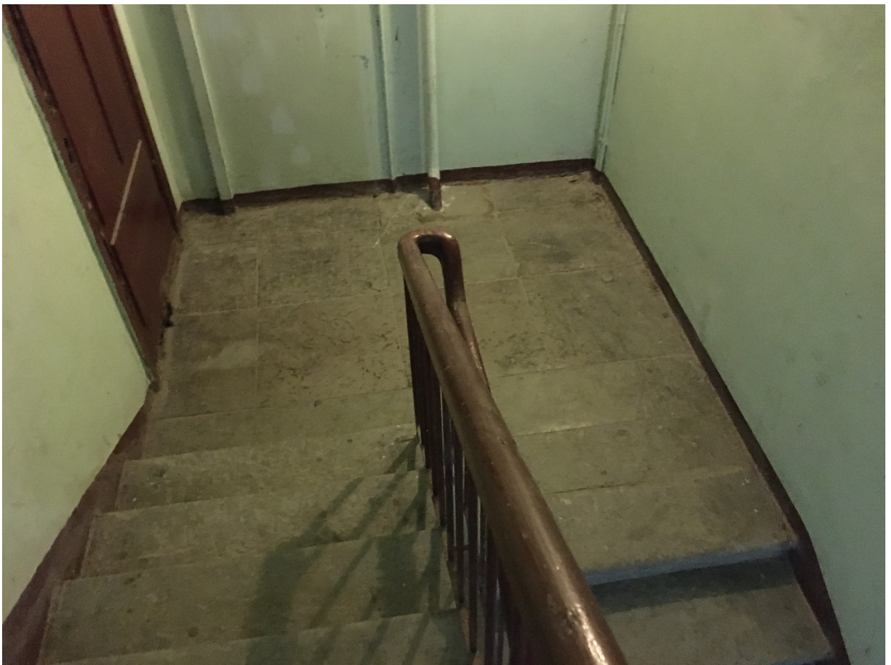
Лестница 2ЛК. Площадка между 2 и 3 этажами. Покрытие пола.
