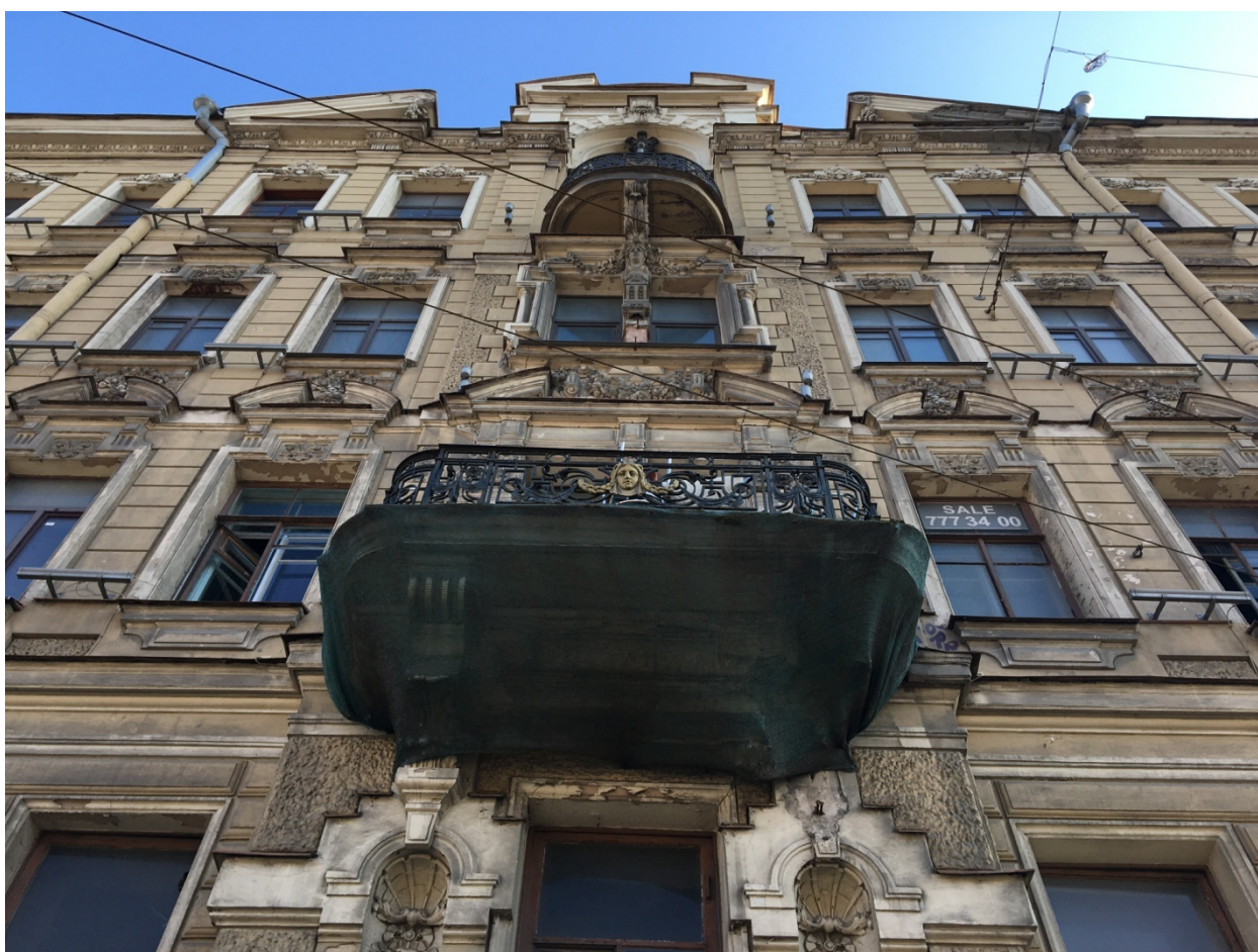
4. Лицевой фасад по Невскому проспекту выявленного объекта культурного наследия «Дом И.И. Ростовцева», расположенного по адресу: г. Санкт-Петербург, Невский пр., 45; Рубинштейна ул., 2. Фрагмент.
