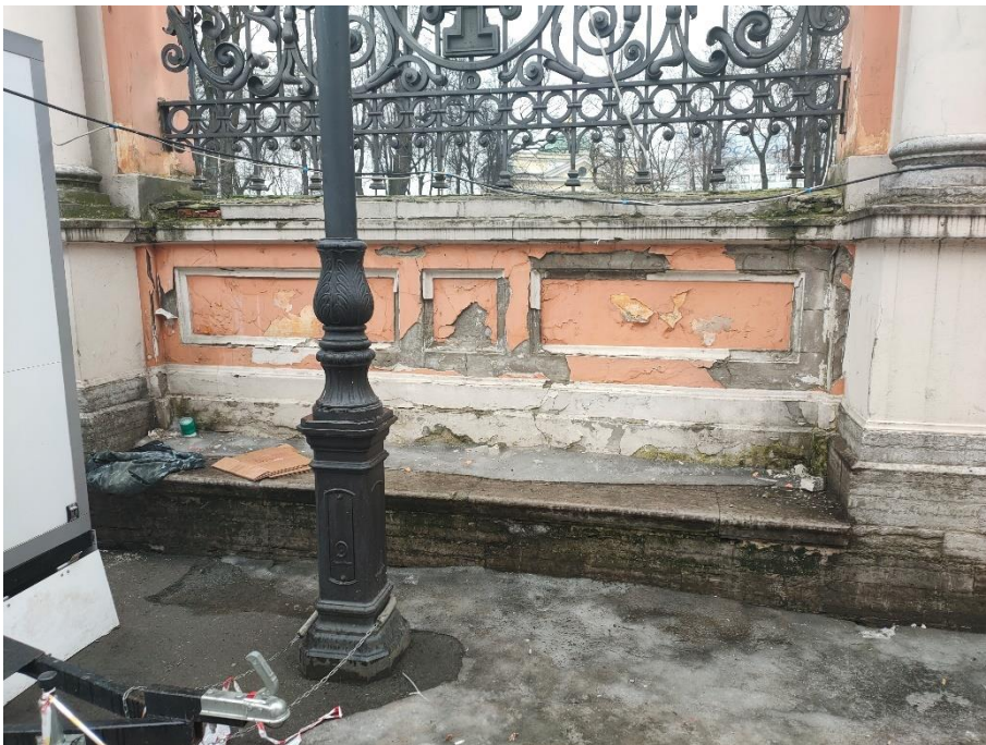
36. «Ворота восточного двора с двумя оградами по набережной реки Монастырки», входящие в состав объекта «Алекса́ндро-Невская Лавра», наб. р. Монастырки. Фрагмент ограды с внутренней стороны. Фото 15.03.2021 г.
