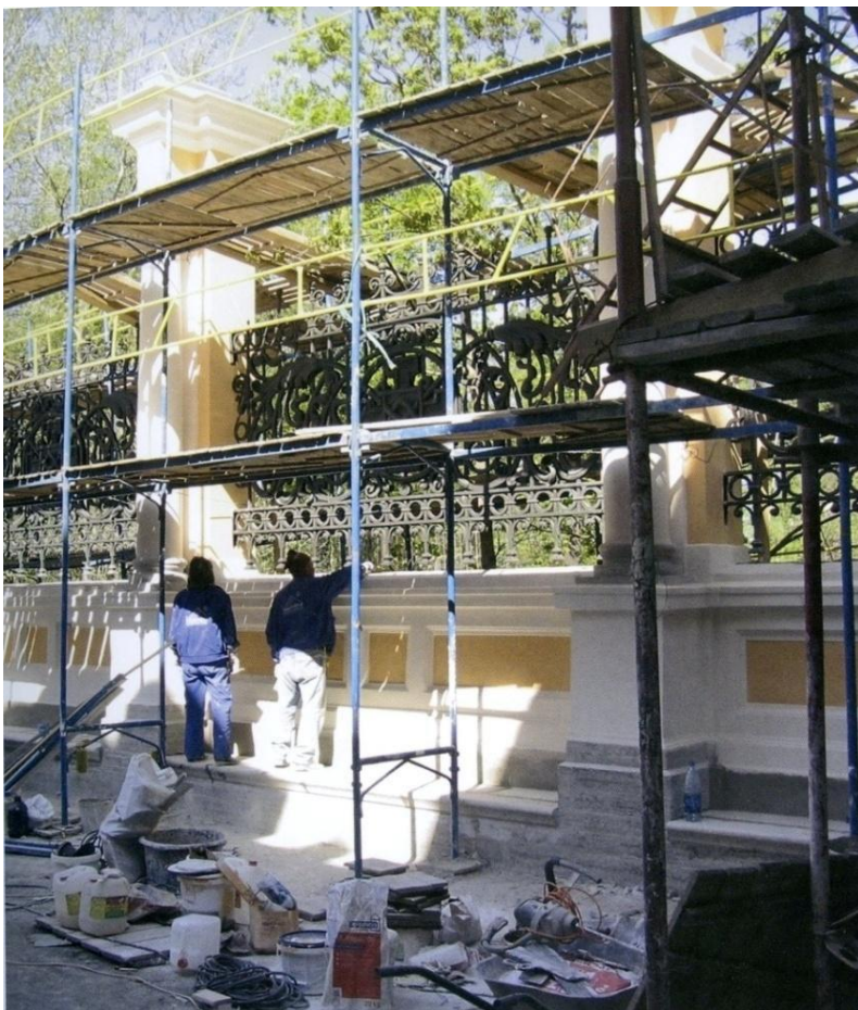
64. Неизвестный автор. Ограда в период ремонта (после установки металлических звеньев). Фотография. 2009 г.
