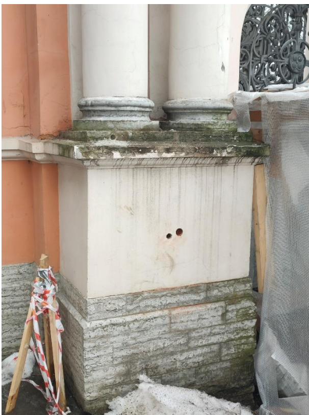
15. «Ворота восточного двора с двумя оградами по набережной реки Монастырки», входящие в состав объекта «Алекса́ндро-Невская Лавра», наб. р. Монастырки. Фрагмент ворот. Фото 15.03.2021 г.
