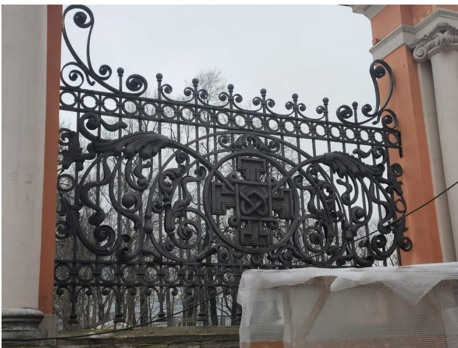
26. «Ворота восточного двора с двумя оградами по набережной реки Монастырки», входящие в состав объекта «Александро-Невская Лавра», наб. р. Монастырки. Фрагмент ограды с внутренней стороны. Фото 15.03.2021 г.
