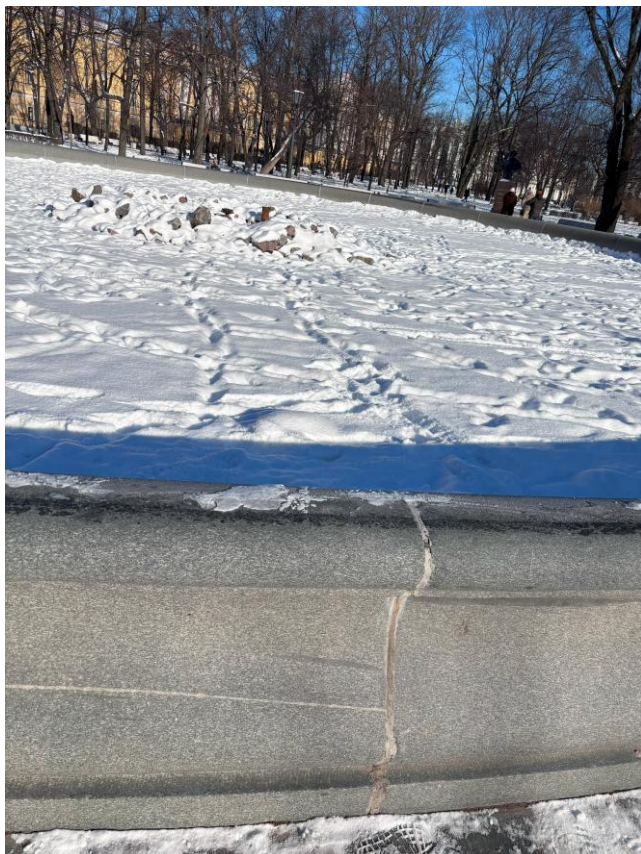
Фото 3. Состояние гранитных блоков чаши фонтана.
