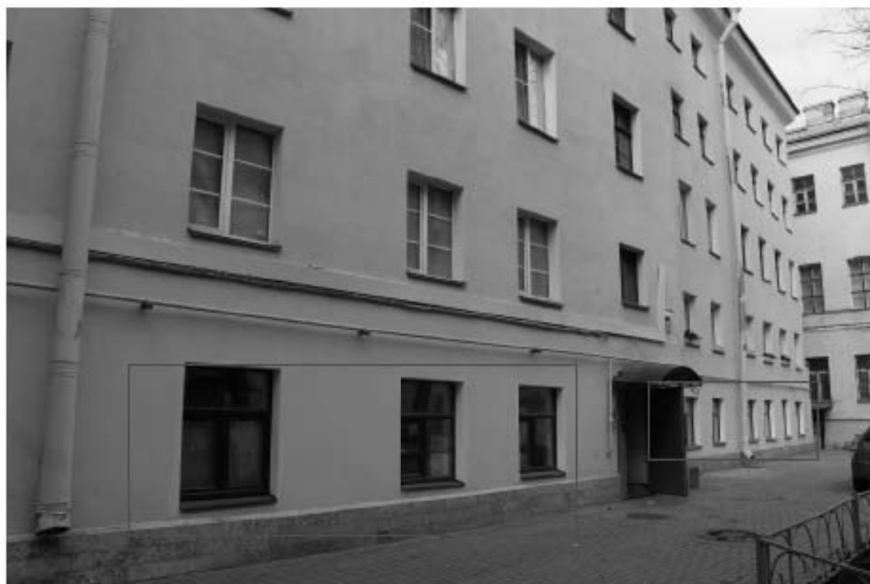
Фото 7. Вид на фасад западного дворового корпуса объекта культурного наследия регионального значения «Дом, где жили в 1872-1875 гг. композитор Мусоргский Модест Петрович и в 1867-1868 гг. композитор Кюи Цезарь Антонович». Красным отмечены оконные проемы нежилого помещения 6-Н.
