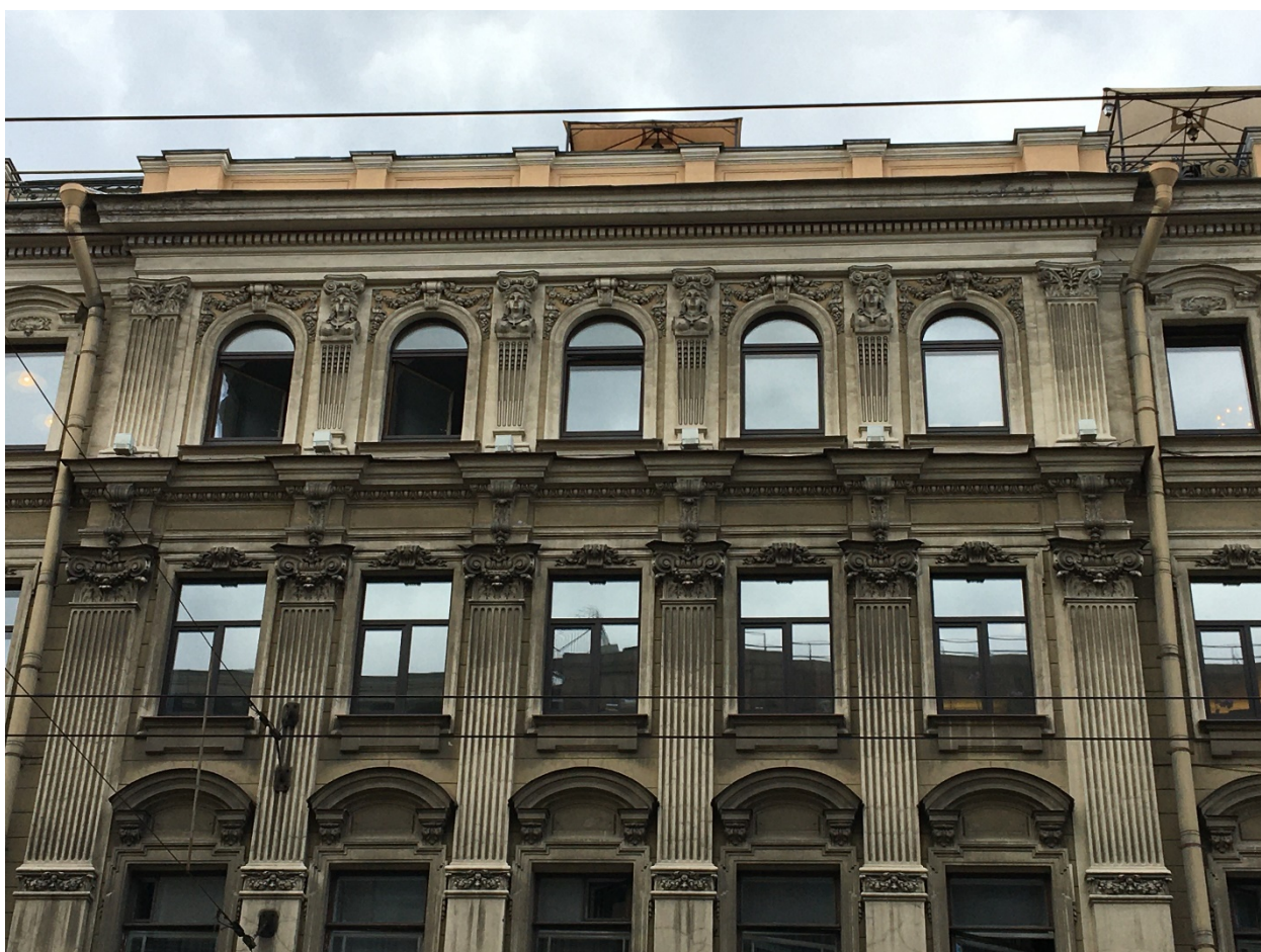
5. Лицевой фасад выявленного объекта культурного наследия «Дом А.И. Трейберга», расположенного по адресу: г. Санкт-Петербург, Невский пр., 11; Морская Малая ул., 2; Кирпичный пер., 2 по Невскому проспекту. Фрагмент.
