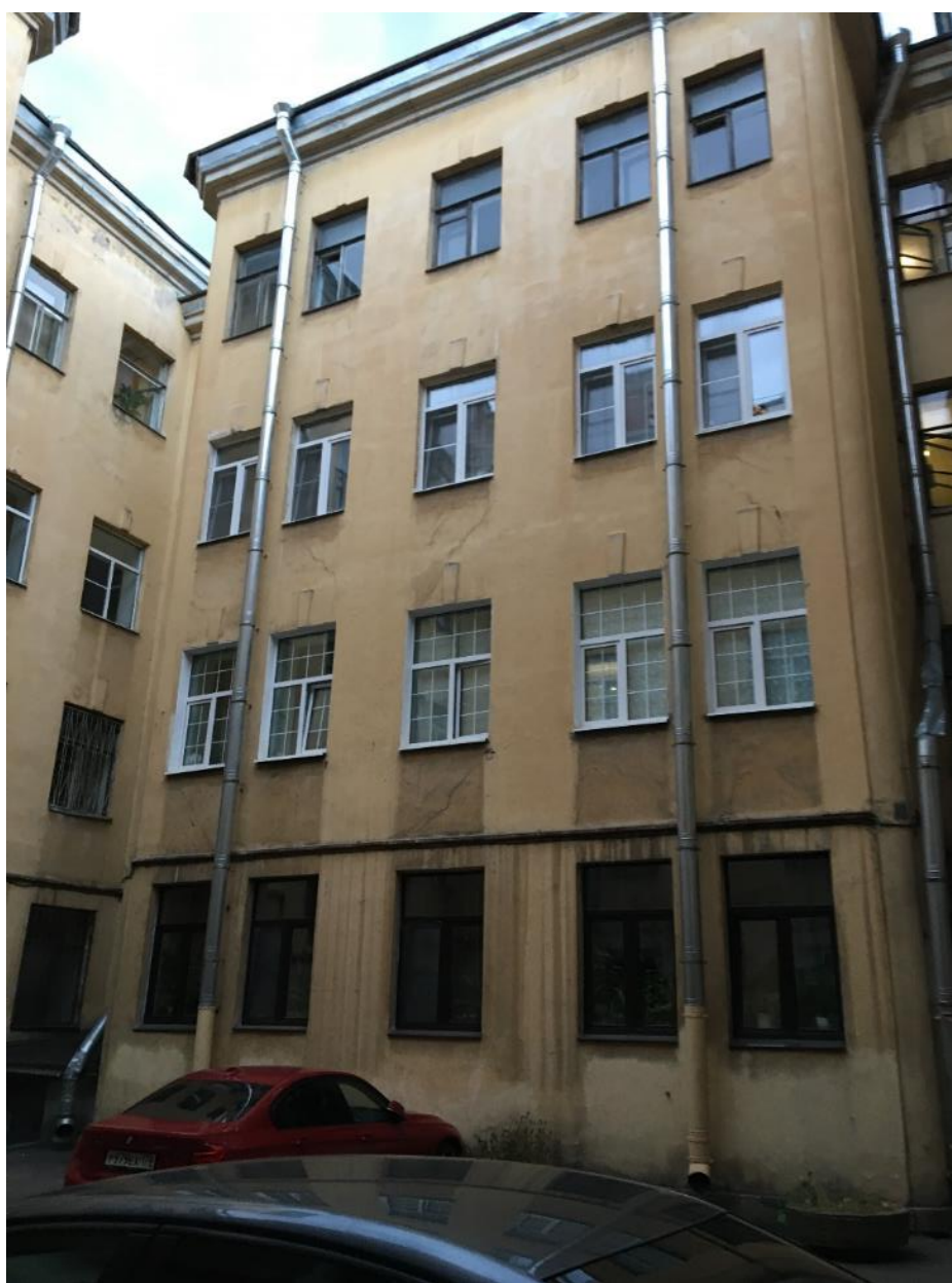
10. Фасады двора-колодца выявленного объекта культурного наследия «Дом Е.К. Эренберга», расположенного по адресу: г. Санкт-Петербург, Моховая ул., д. 4.
