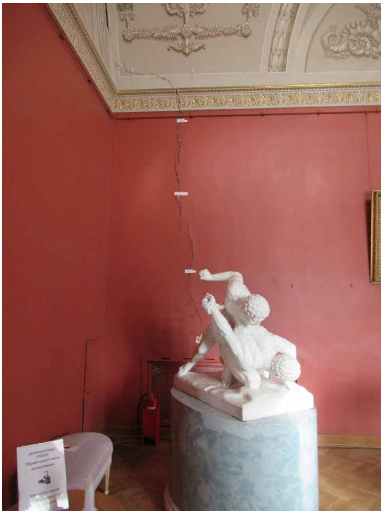
Илл. 48. Фото 2021 г. Античная. Вид на трещину.
