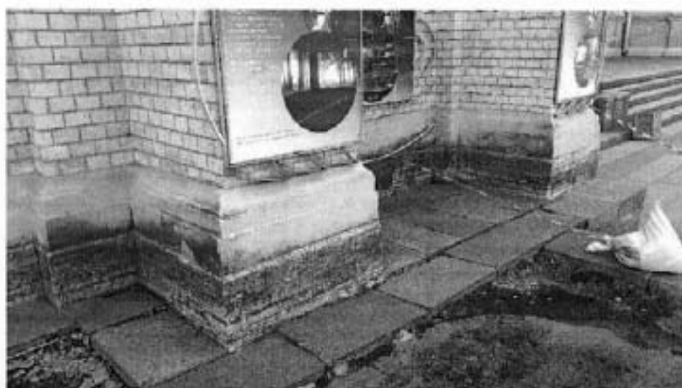
Фото 4. Состояние цоколя северного фасада объект культурного наследия
