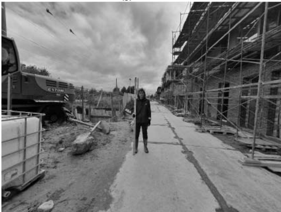
Рис. 16. СПб – 2021. Петродворцовый район, пос. Стрельна. Общий вид участка обследования. Точка фотофиксации 7. Вид с запада
