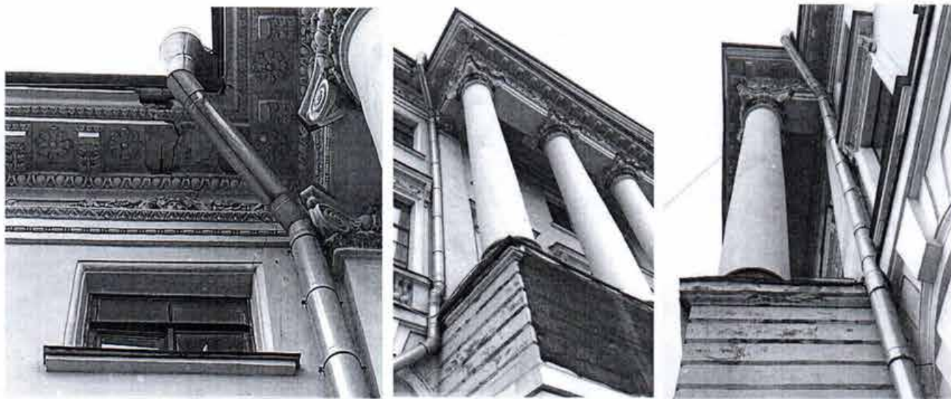
23-27. Дефекты восточного лицевого фасада по Марсовому полю (17.11.2021).
