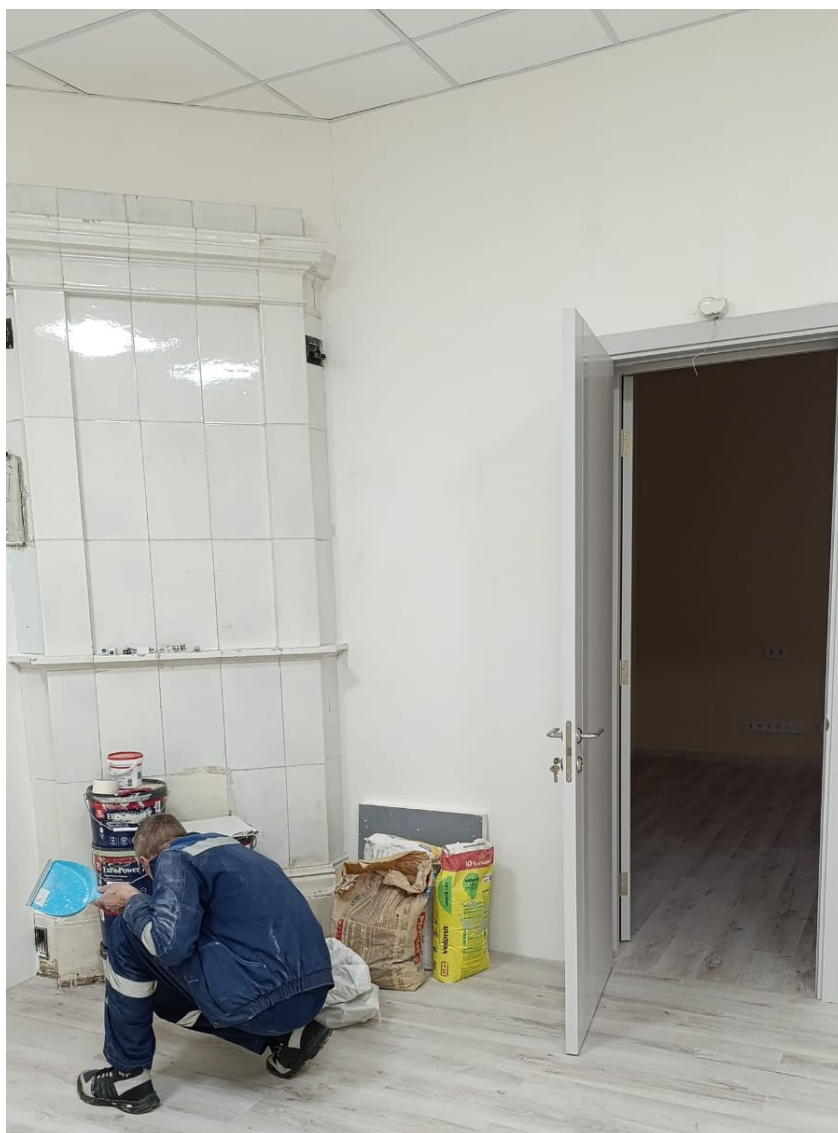
Фото №7. Помещение 15-Н (17), печь.
