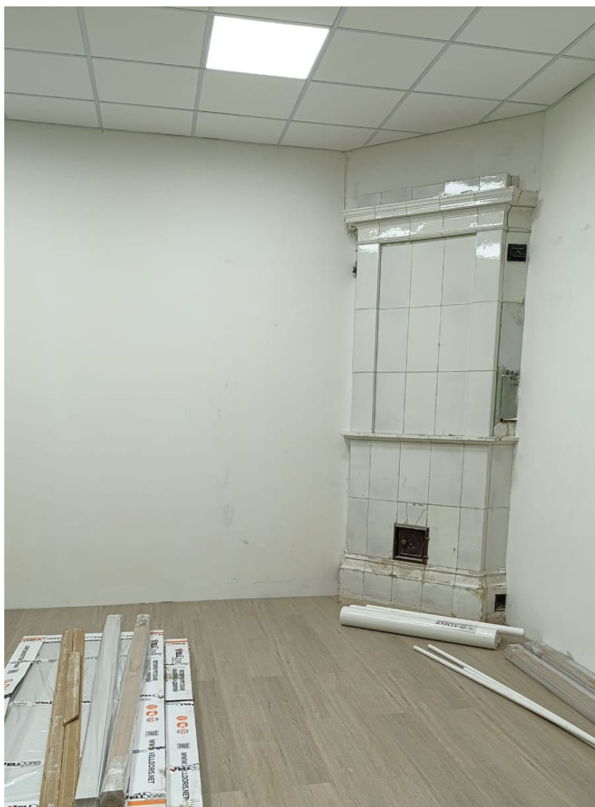
Фото №4. Помещение 15-Н (18), печь.
