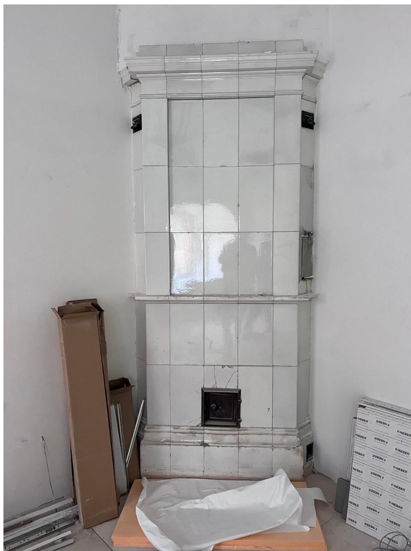
Фото №3. Помещение 15-Н (18), печь.
