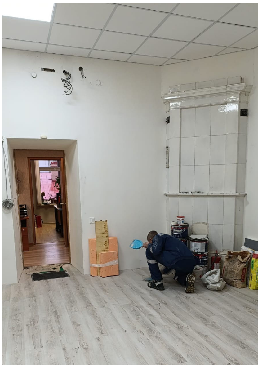
Фото №8. Помещение 15-Н (17), печь.
