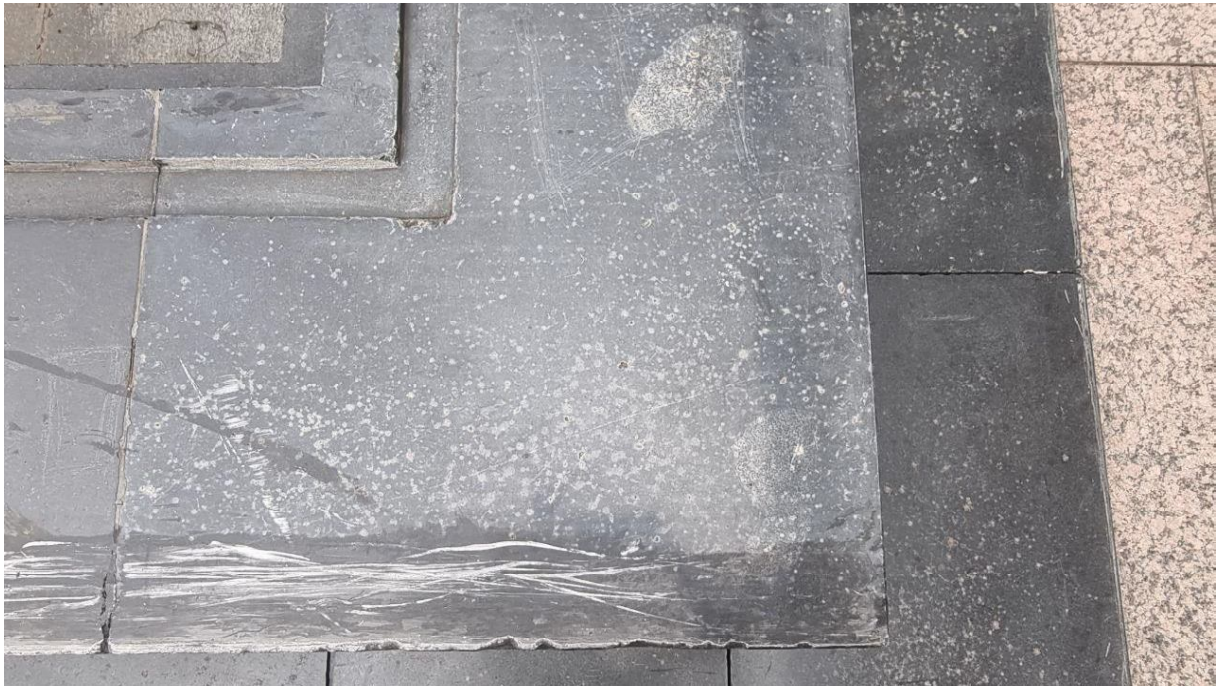
Фото 10. Царапины полированной поверхности, места утрат шовного заполнителя, сколы и выбоины.
