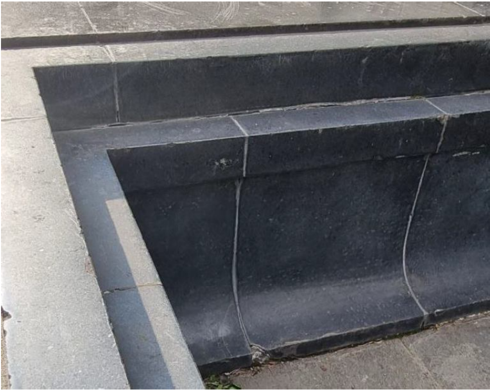
Фото 33. Следы биопоражения, сколы и выбоины, места утрат шовного заполнителя.
