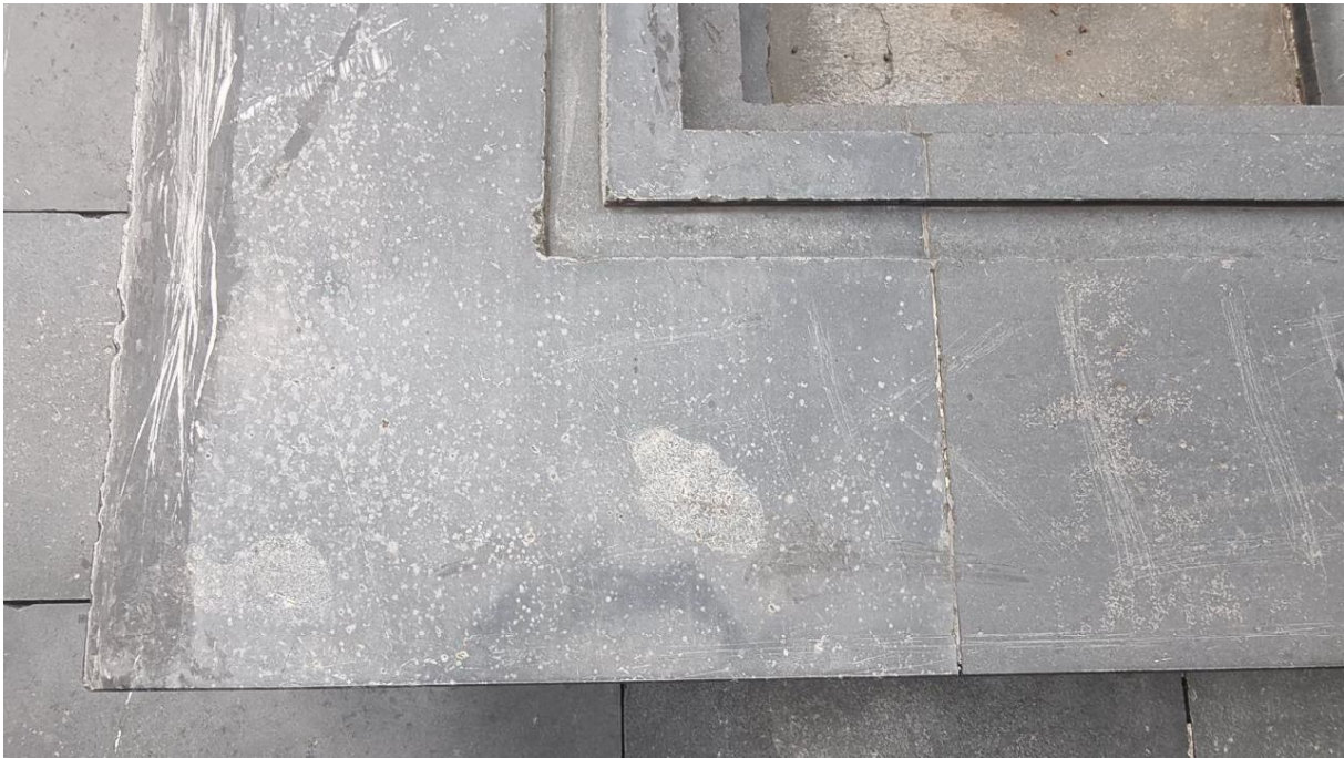
Фото 11. Царапины полированной поверхности, места утрат шовного заполнителя, сколы и выбоины.
