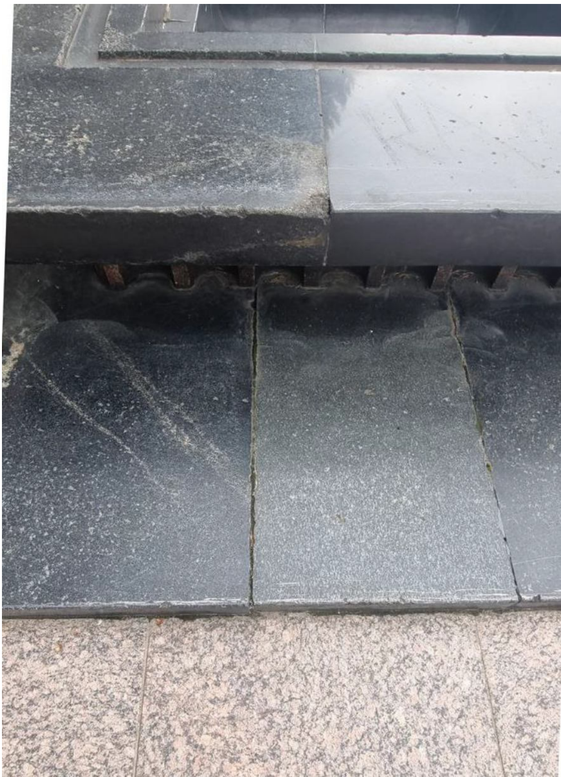
Фото 25. Биопоражение, места утрат шовного заполнителя, сколы и выбоины.
