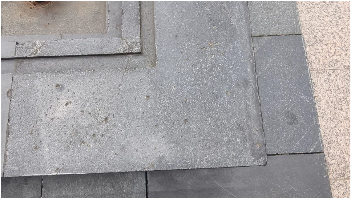
Фото 15. Сколы и выбоины, различные механические повреждения, места утрат шовного заполнителя.
