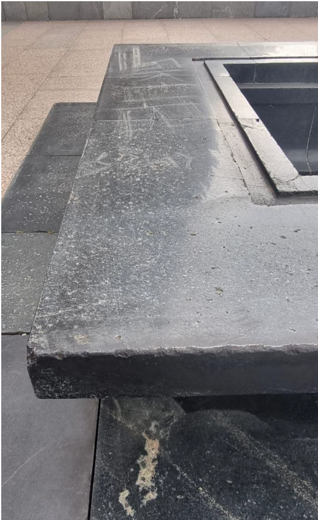
Фото 12. Царапины полированной поверхности, места утрат шовного заполнителя, сколы и выбоины.
