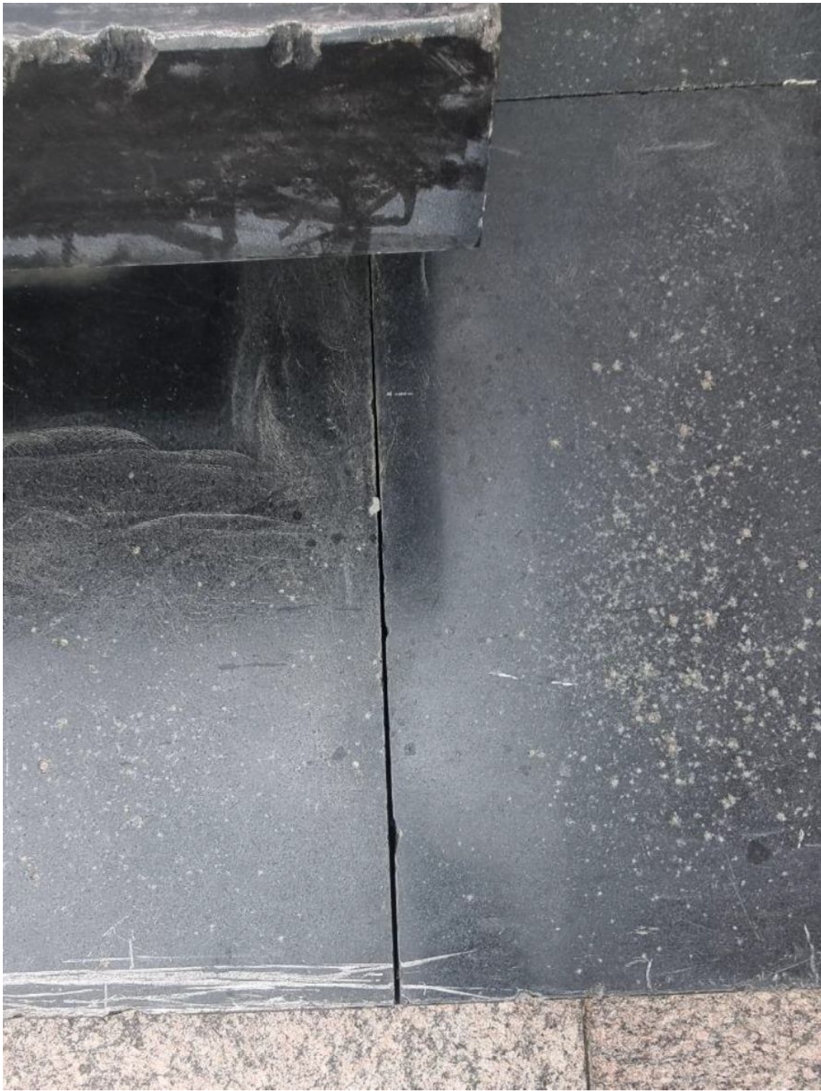
Фото 27. Царапины полированной поверхности, места утрат шовного заполнителя, сколы и выбоины.
