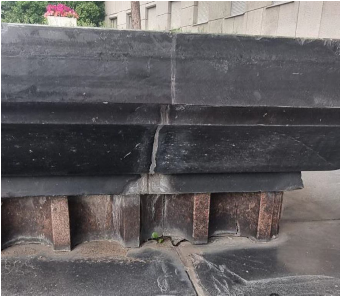
Фото 17. Биопоражение, места утрат шовного заполнителя, трещины в декоративных элементах чаши фонтана раскрытием до 3 мм.
