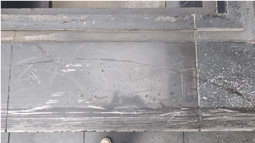
Фото 8. Царапины полированной поверхности, места утрат шовного заполнителя, сколы и выбоины.
