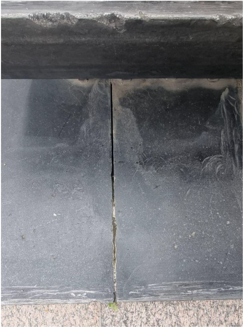
Фото 21. Царапины полированной поверхности, места утрат шовного заполнителя, сколы и выбоины.
