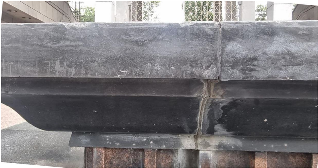
Фото 30. Сколы и выбоины, биопоражения, места утрат шовного заполнителя.
